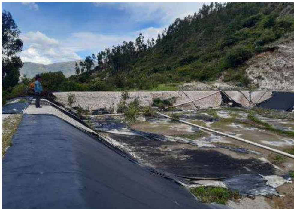
Fotografía 2. Reservorio Quilla Pata Pata, donde se observa el deterioro de la geomembrana por lo que no se hace uso del reservorio.
