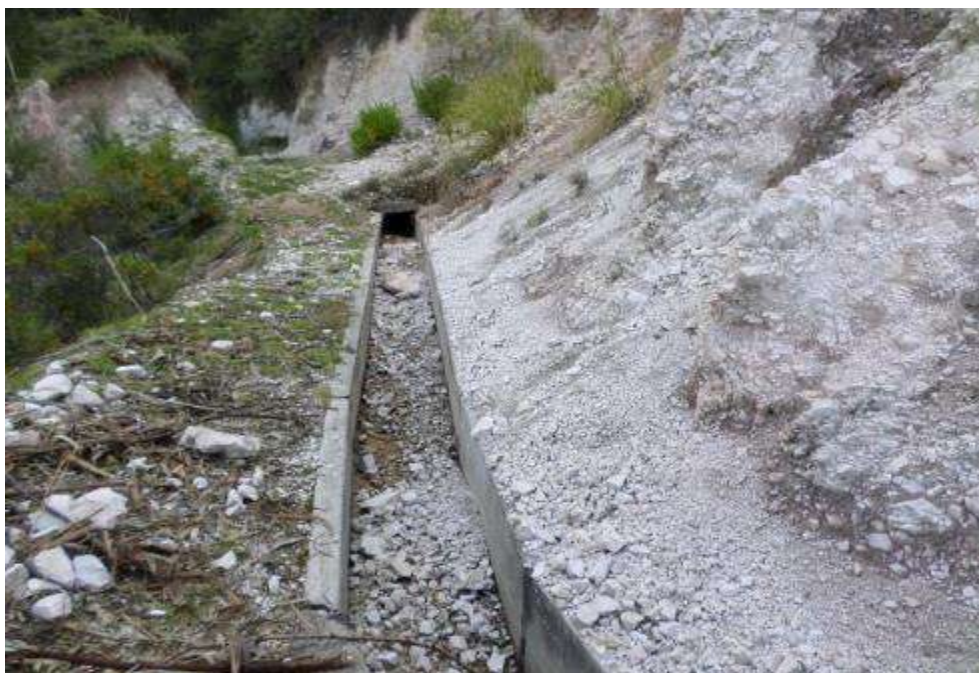
Fotografía 3. Canal de regadío obstruido con material de derrumbes que ocurren en el talud.
