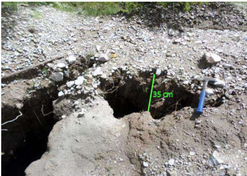
Figura 21. Se muestra grietas de hasta 35 cm de apertura, ubicada en la cabecera de la erosión de ladera. Con coordenadas UTM (WGS 84): 601866.93 E; 8485283.36 S.
