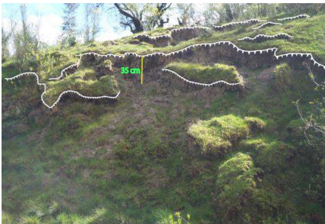
Figura 15. Se observa en línea dentada de color blanco escarpes de reptación de suelo, que presentan saltos de hasta 35 cm
