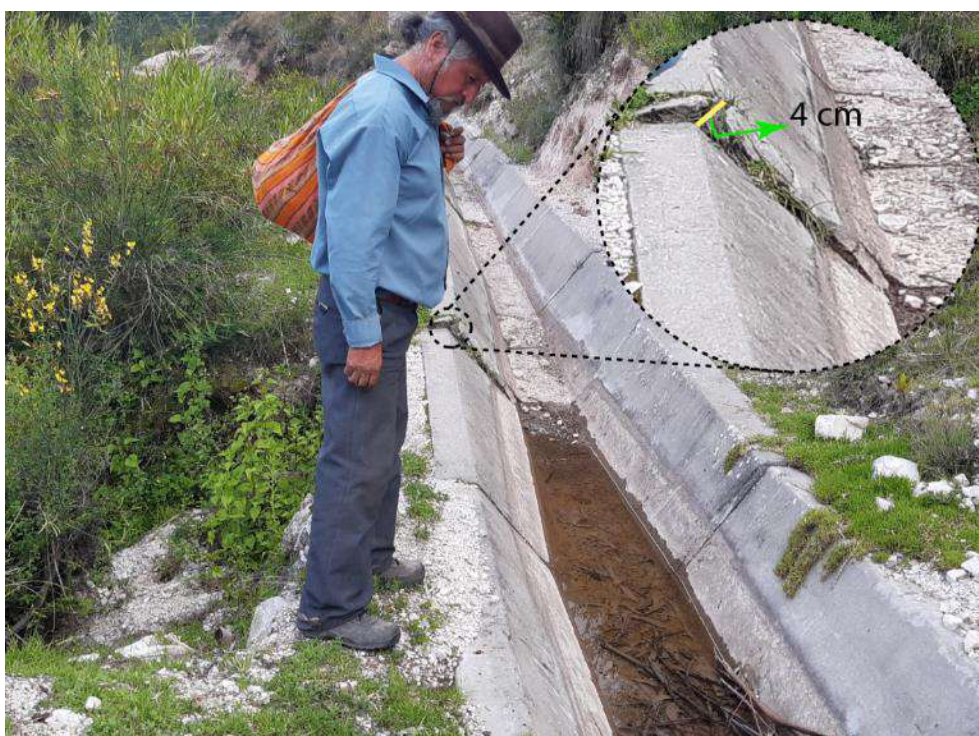
Figura 26. Se observa desplazamiento de 4 cm de la estructura del canal de regadío por el cual se infiltra agua y desestabiliza el terreno, pudiendo desencadenar derrumbes de mayor magnitud.
