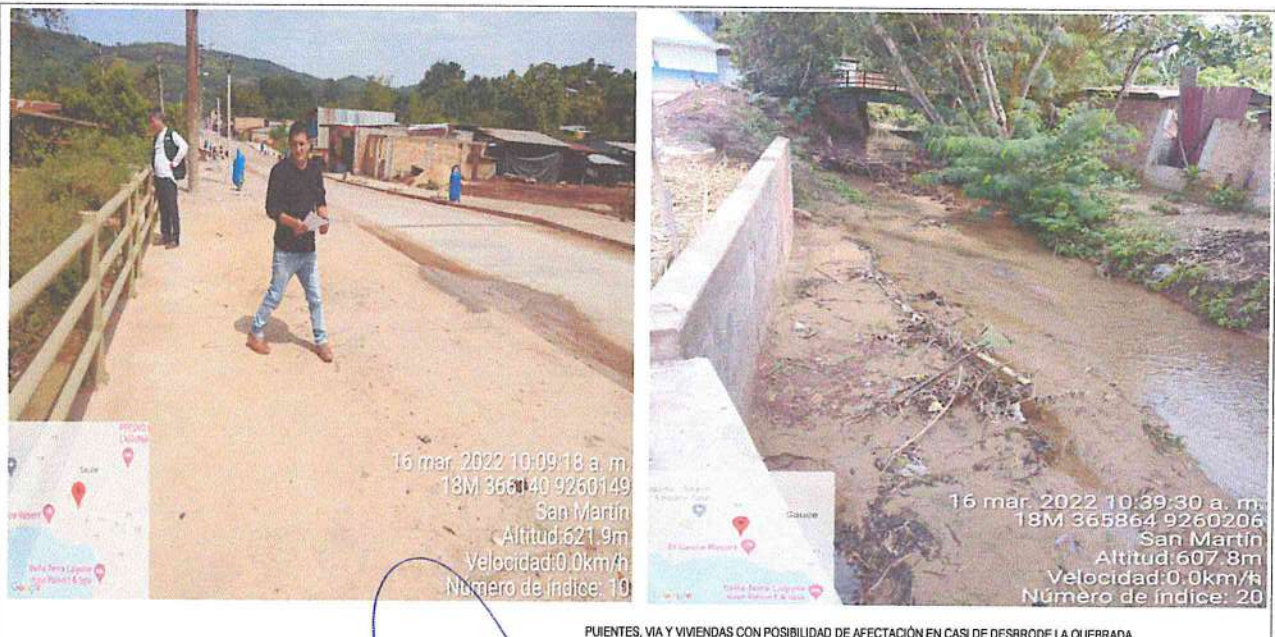
PUENTES, VIA Y VIVIENDAS CON POSIBILIDAD DE AFECTACIÓN EN CASI DE DESBORDO DE LA QUEBRADA
