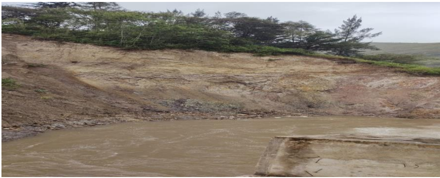
Erosión causada en el margen izquierdo del río Chancay Sector Pachamama
