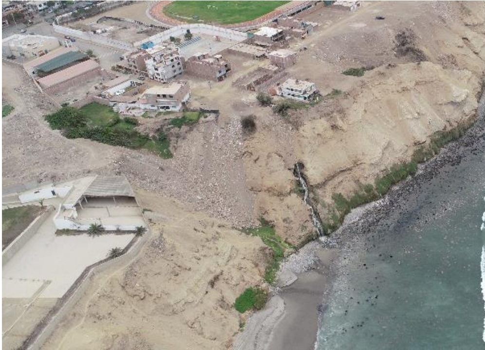
Fotografía 5. Viviendas ubicadas muy próximas al acantilado de la playa Chorrillos que podrían ser afectadas por actividad sísmica.
