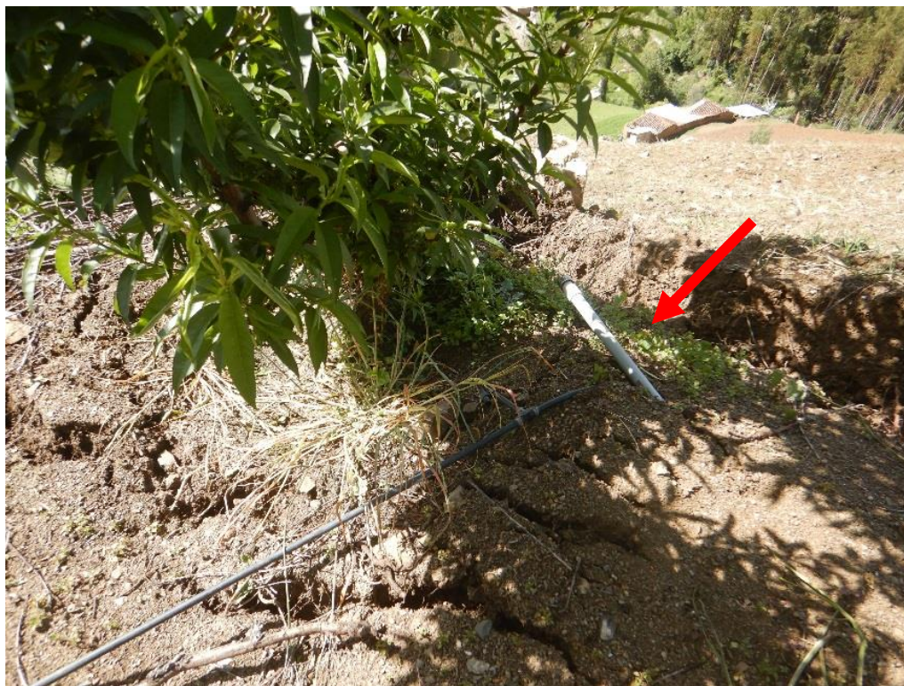
Figura 19. Tubería de PVC destruidas por el deslizamiento con dirección N28°E, actualmente se encuentra reparado, para evitar fugas. Esta se ubica entre las coordenadas UTM 8976635 N, 208744 E, con una altitud de 2952 m s.n.m.
