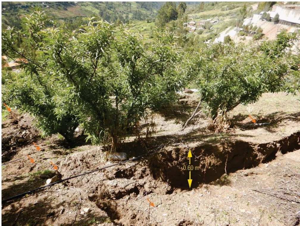
Figura 13. Agrietamientos longitudinales discontinuos, con aberturas de 0.05 a 0.17 m (flechas naranjas) y agrietamientos transversales con saltos de 0.60m aproximadamente.
