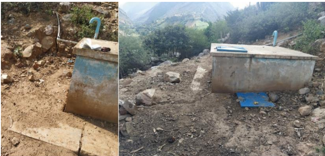
Figura 39. Reservorio de agua afectada por grietas tensionales en el terreno.
