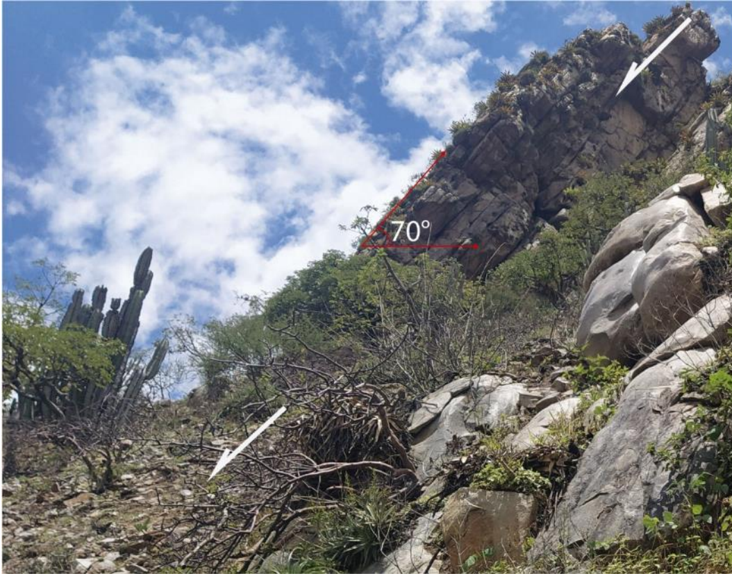
Figura 9. Se observan afloramientos de areniscas de la Formación Chimú, sobre el poblado Chacapunta, en el parte superior del cerro Baños, muestra areniscas con Bz: 70°, fracturadas, que provocan caída de rocas.
