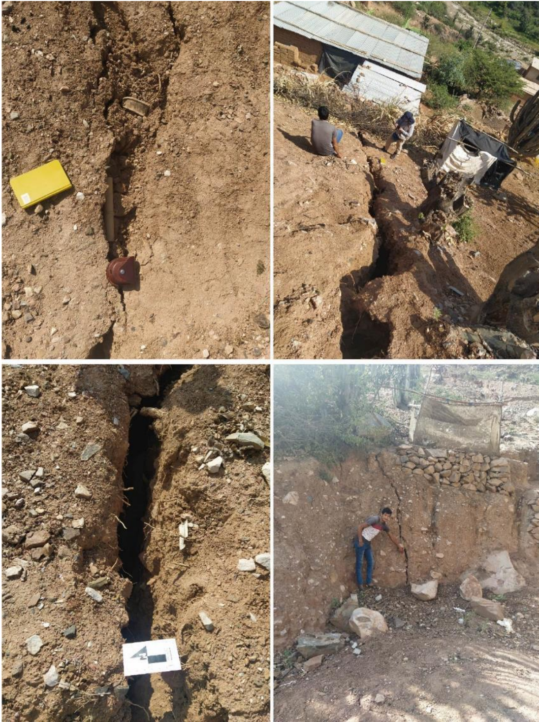
Figura 34. Grietas tensionales en la vertiente coluvio deluvial, donde se asientan las viviendas del caserío de Chacapunta.
