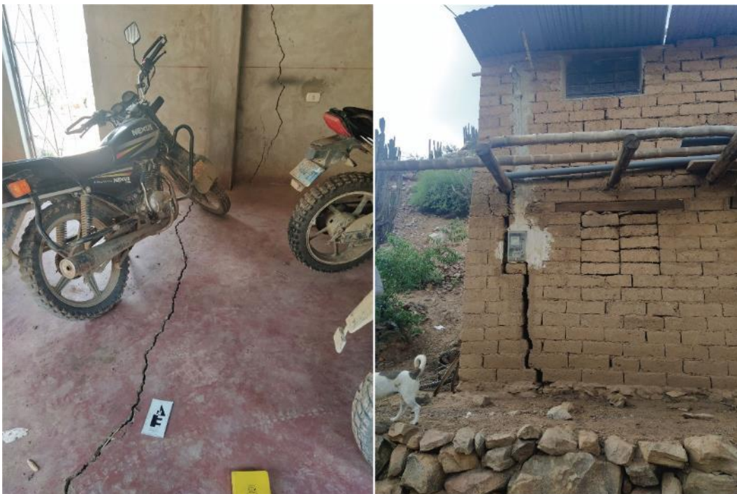
Figura 38. Agrietamientos en pisos y muros de viviendas ubicadas dentro del cuerpo del deslizamiento.
