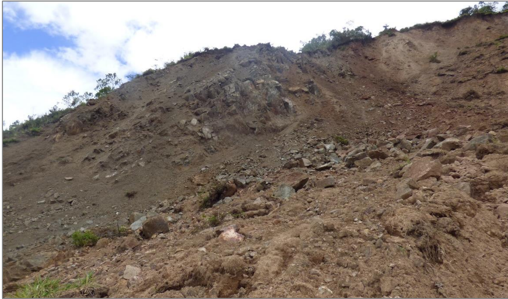
Fotografía 9. Vista de andesitas muy fracturadas y altamente meteorizadas a arenas de grano grueso, color verdoso.
