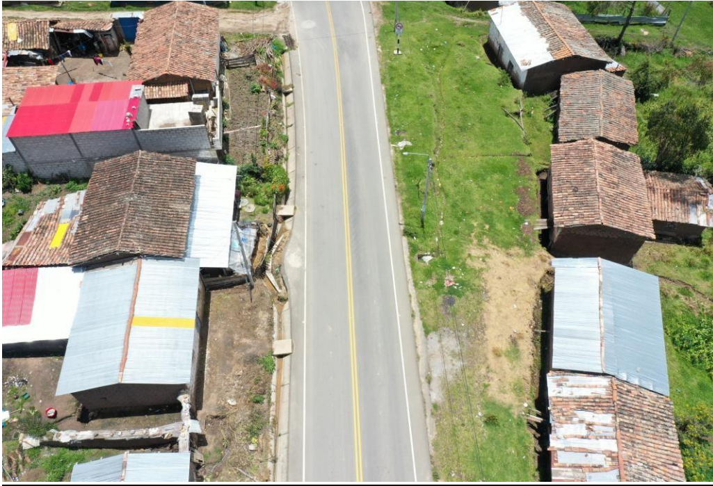
Fotografía 18. Flujos de agua y filtración de agua en las viviendas de la comunidad de Los Ángeles (parte baja)
