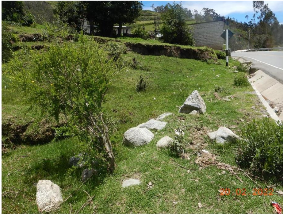
Fotografía 15. Deslizamiento activo ubicado en el flanco derecho de la carretera Kishuara - Sahuinto
