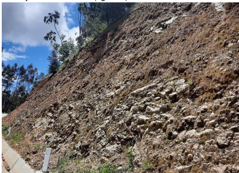
Fotografía 3. Bloques sedimentarios e intrusivos subangulares envueltos en una matriz limo-arcillosa
