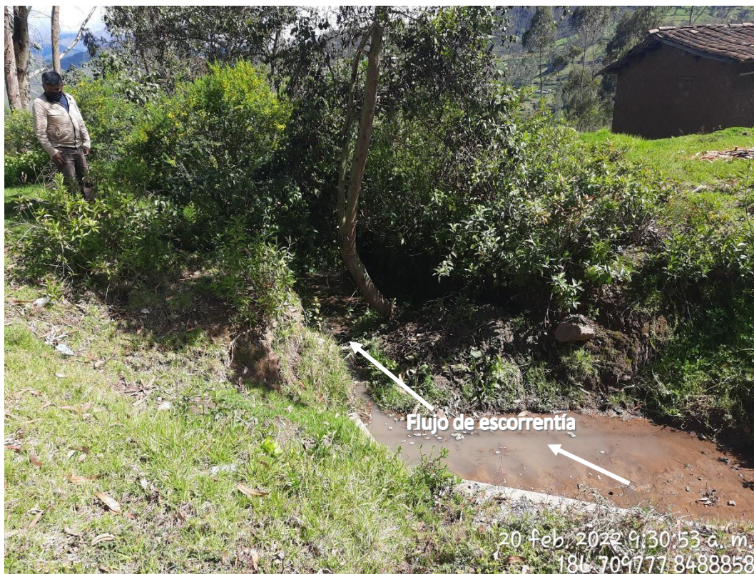
Fotografía 7. Vista del baden de escorrentía, colmatado de material arcilloso
