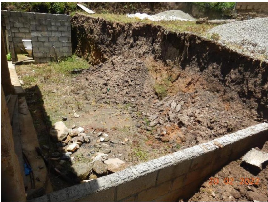
Fotografía 16. Salida de Ojos de agua, en el corte de talud de viviendas en la parte alta de la comunidad de Los Ángeles
