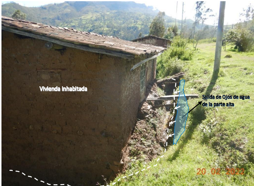
Fotografía 6. Zanjas de encausamiento precario de aguas de infiltración provenientes de la parte alta. Y vista del poste de la red de energía de la comunidad de Tappacera, a 30 cm de la zanja.
