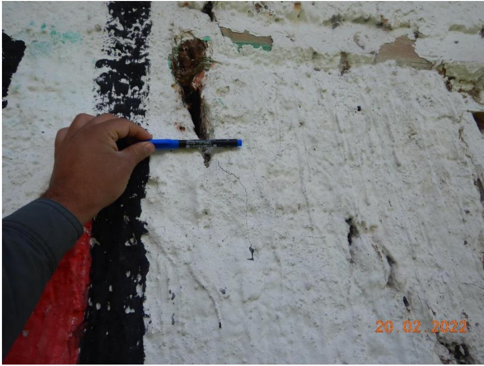
Fotografía 9. Vista de agrietamientos y aperturas generadas durante la construcción de la carretera Dv. Kishuara – puente Sahuinto (tramo VII), en las viviendas de adobe de la comunidad de Tapaccera.
