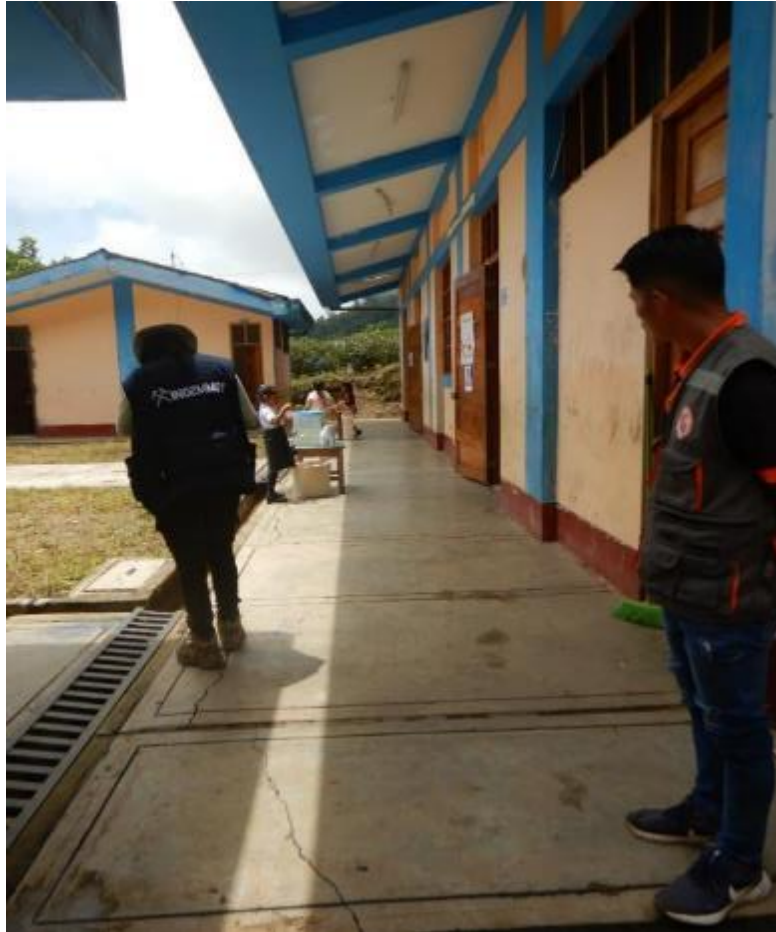
Fotografía 6. Se observa grietas en la vereda de la I.E. N° 389 1/Mx.U.Chongos Carmen Pampa, con coordenadas UTM (WGS 84): 606765 E; 8622591 N.
