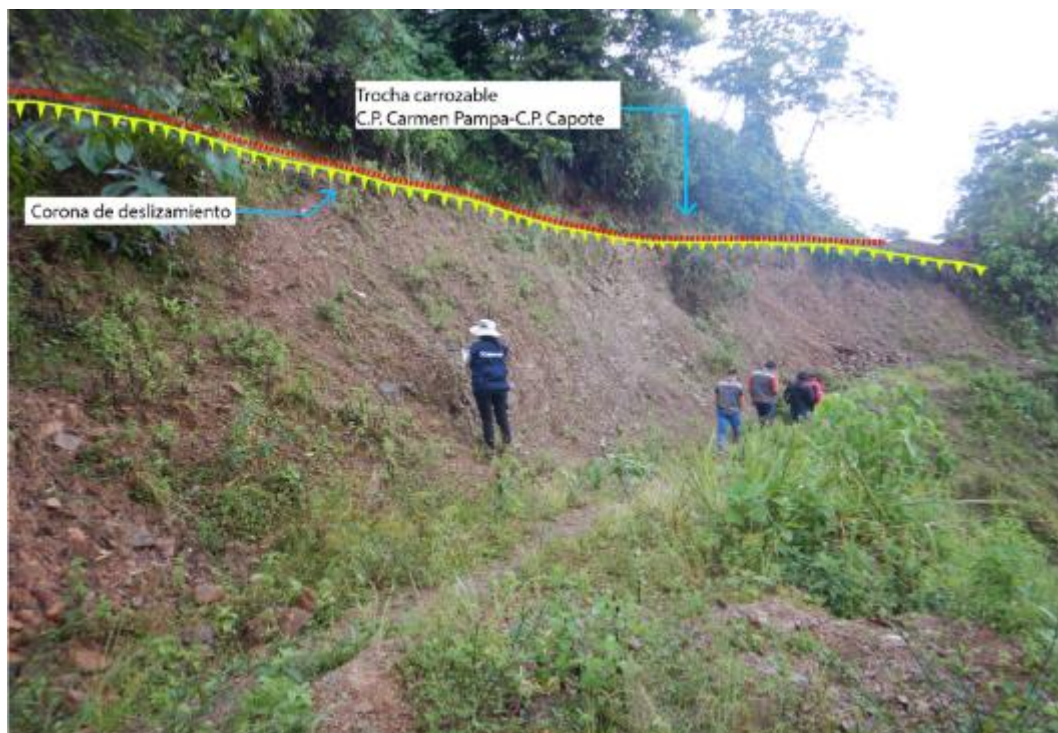
Figura 14. Se observa la corona del deslizamiento, el cual afecta 52 m de la trocha carrozable C.P. Carmen Pampa – C.P. Capote, con coordenadas UTM (WGS 84): 606576 E; 8622738 N.
