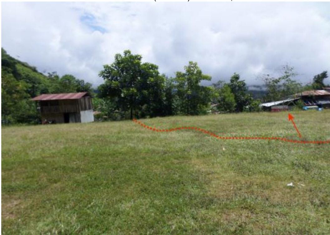
Figura 17. Presencia de grietas en el campo deportivo del C.P. Carmen Pampa, con un salto de 10 cm, con coordenadas UTM (WGS 84): 606718 E; 8622589 N.
