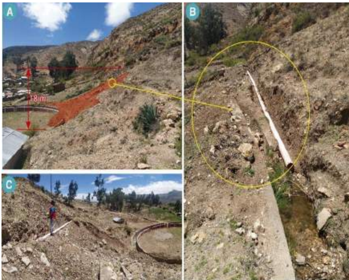
Figura 25. A) altura del derrumbe identificado en la ladera noreste del cerro Anchacata, derecha de la quebrada Panteón Huaycco; B) muestra canal de riego revestido destruido por el derrumbe (5 m longitudinales) y reemplazado por tubería provisional, C) vista del derrumbe y como llego hasta la plaza de toros de Acos
