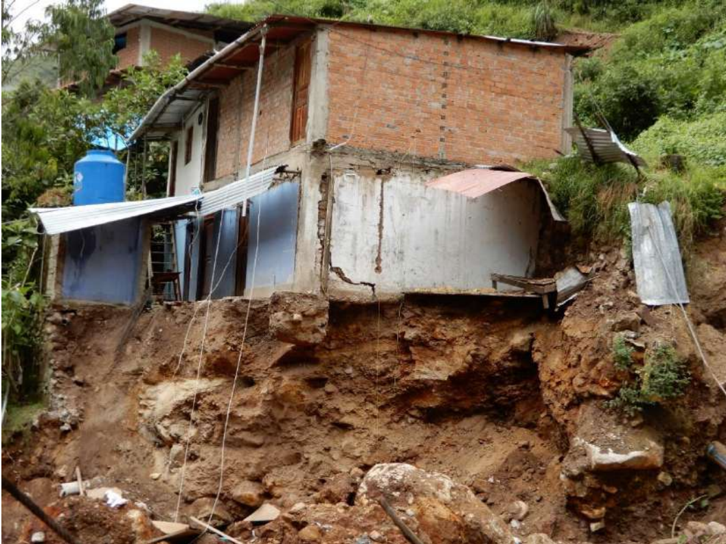
Fotografía 8: Vivienda ubicada en la margen derecha del río Parcoy y afectada por el desarrollo del proceso de hundimiento.
