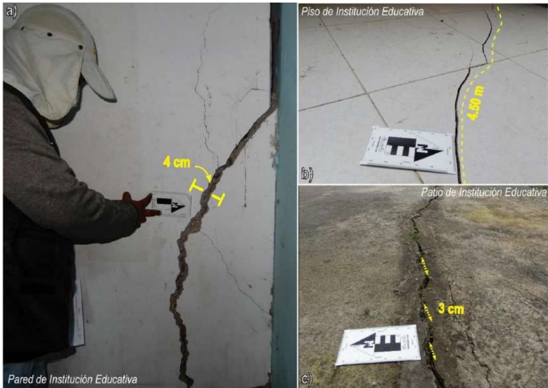
Figura 15: Institución Educativa 80455 "Luis Valle Goicochea" afectada por activación de deslizamiento. Actualmente se puede visualizar: a) Grietas en la pared de hasta 4 cm de ancho, b) Grietas de 4.5 m de longitud en el piso de aula y c) Asentamientos o desnivel en patio de 3 cm.
