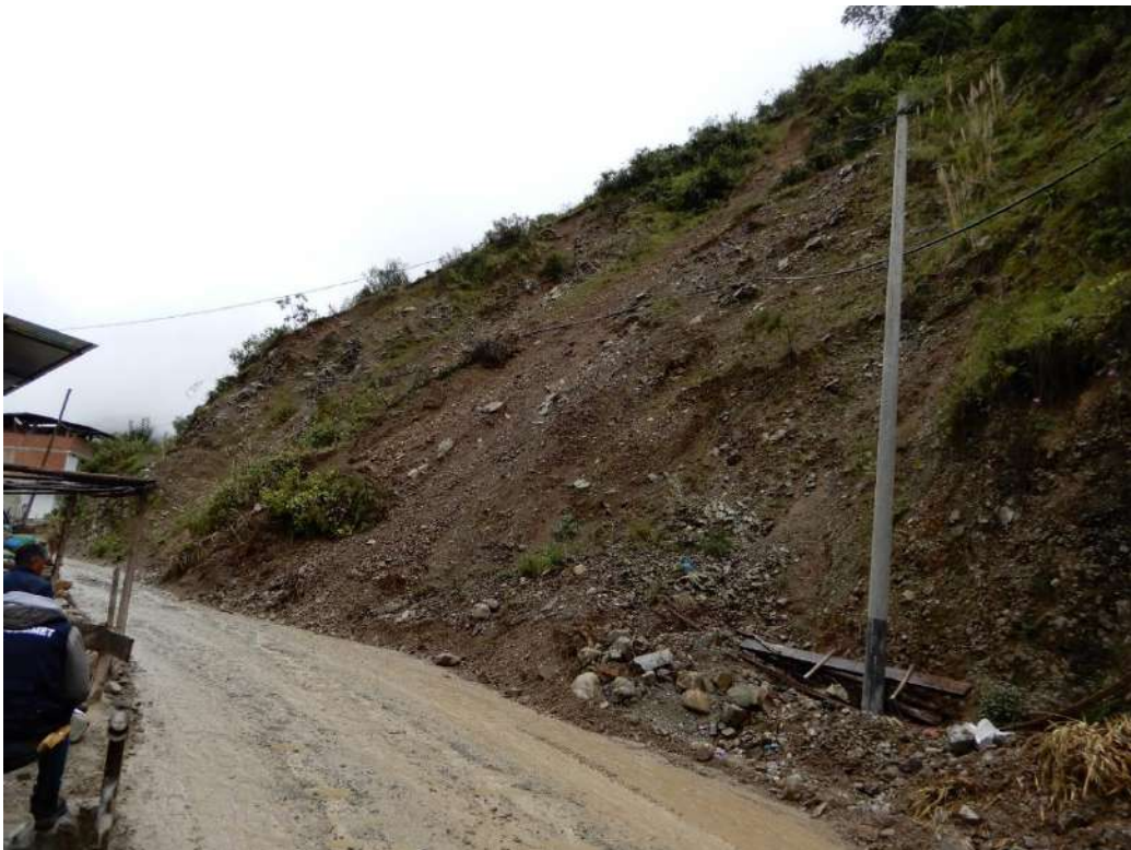
Fotografía 21: Derrumbe activo ubicado en el sector de Lamas, que pone en peligro viviendas ubicadas al pie de la ladera, tuberías de agua y un tramo de la carretera Lamas-Retamas.
