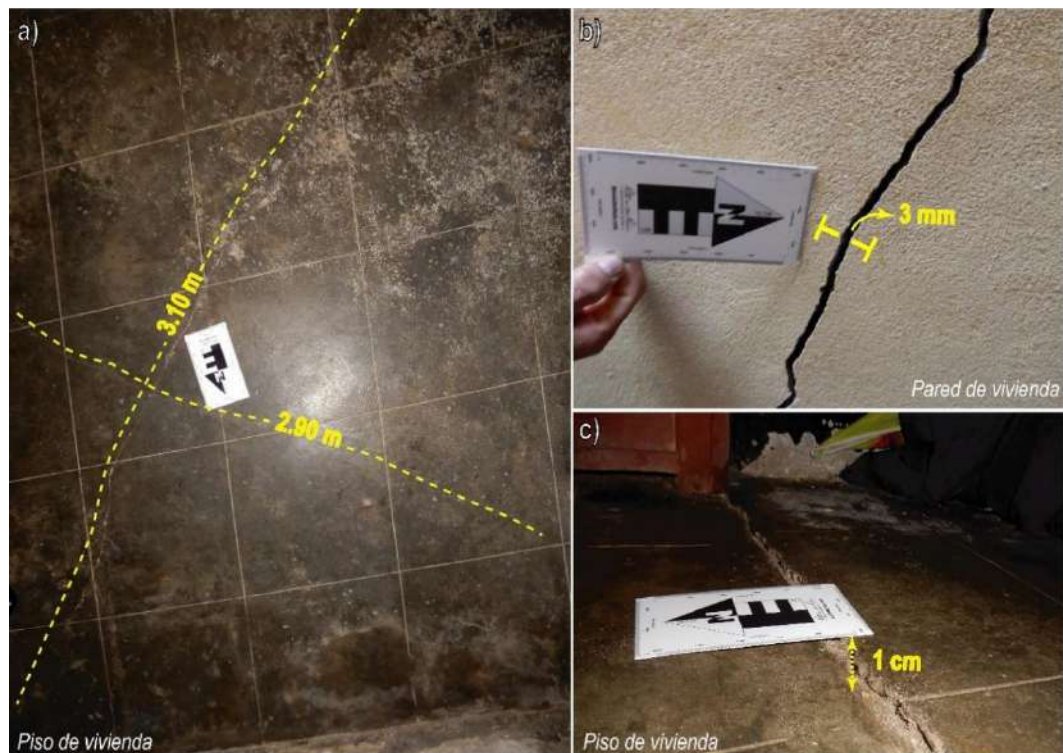
Figura 16: Vivienda posiblemente afectada por procesos de hundimiento. Actualmente se puede visualizar a) agrietamientos en el piso de hasta 3.1 m de longitud, b) grietas con aberturas de hasta 3 mm en paredes y c) asentamientos o desnivel en piso de hasta 1 cm.
