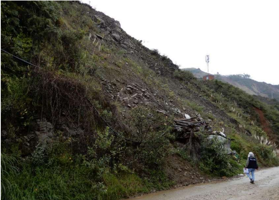
Fotografía 16: Ladera susceptible a la ocurrencia de derrumbes, con la presencia de bloques sueltos que pone en peligro 2 viviendas ubicadas al pie de la ladera y la vía Retamas-Parcoy.
