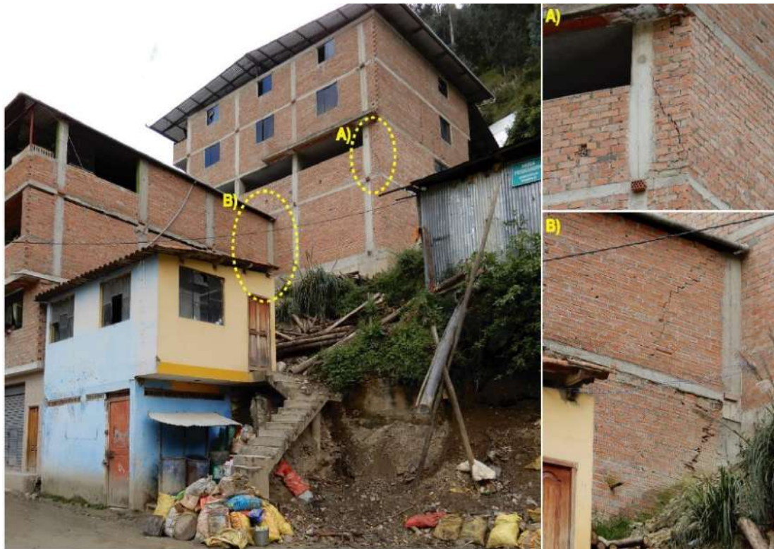
Figura 17: Ladera susceptible a la ocurrencia de derrumbes, que en la actualidad se encuentra afectando dos viviendas ubicadas en la margen derecha de la ladera.
