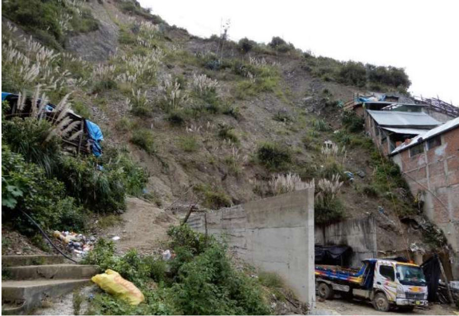
Fotografía 10: Derrumbe activo ubicado en la margen izquierda del río Retamas. Al pie de la ladera se observa corte de talud para delimitar una nueva área de construcción.
