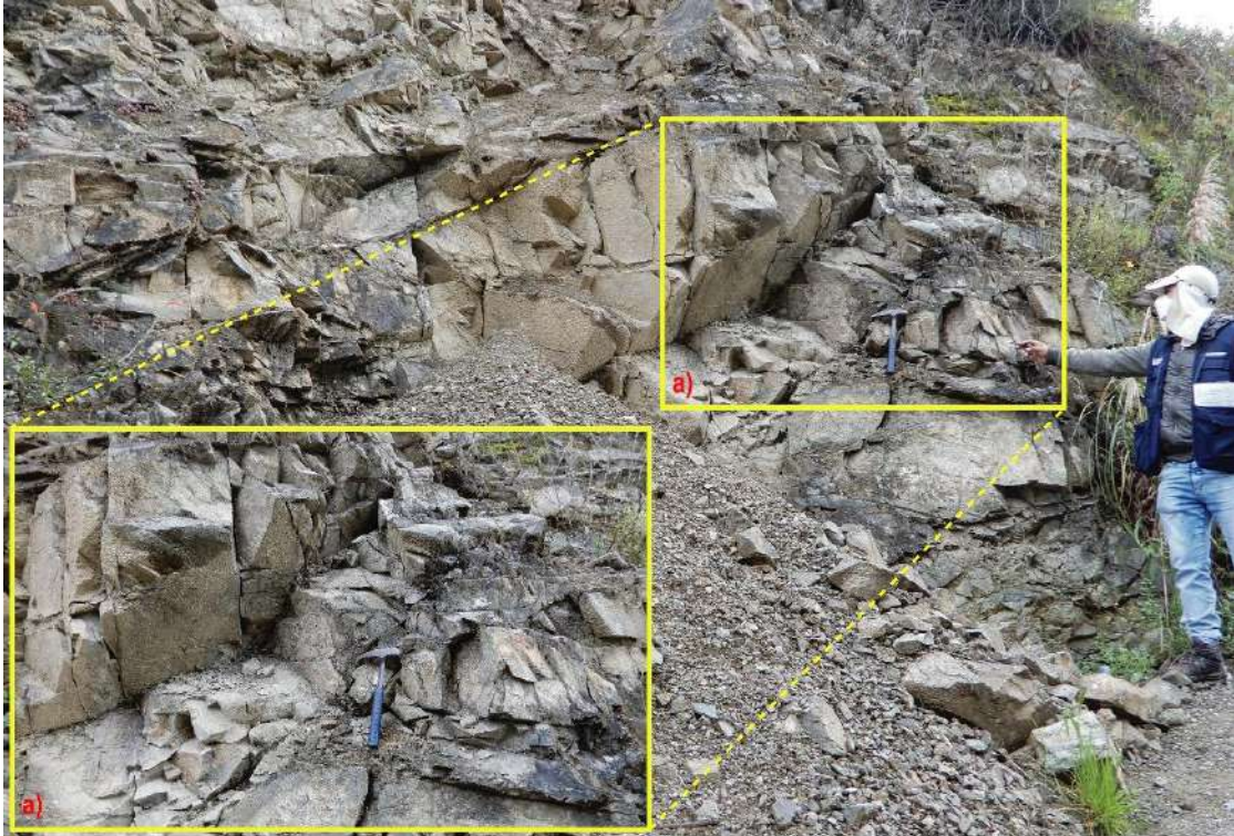
Figura 6. Sustrato rocoso conformado por tonalitas y granodioritas las cuales se encuentran muy fracturadas, con espaciamentos muy próximas a próximas entre sí, ligeramente rugosas y además se presentan altamente meteorizada.
