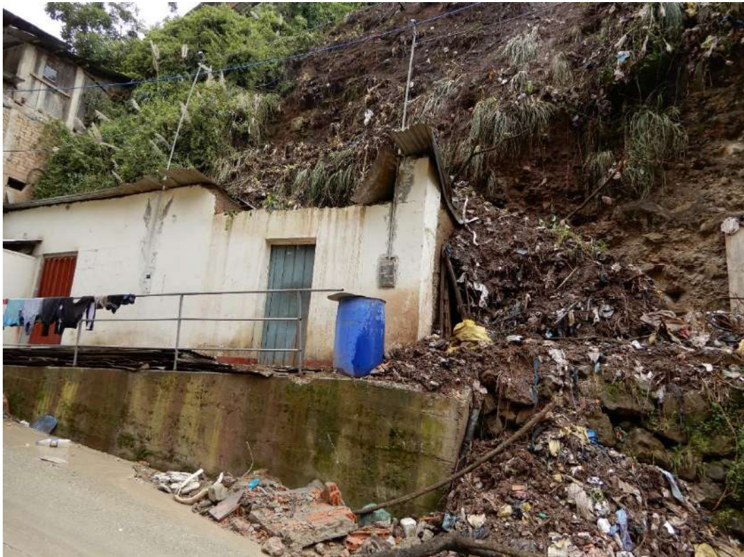
Fotografía 5: Afectación de una vivienda ubicada al pie del derrumbe, que pone en peligro a sus habitantes de ocurrir un evento similar.
