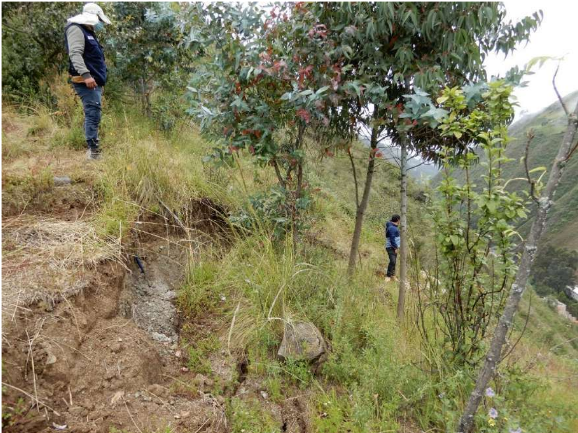
Fotografía 13: Se observa grieta con desplazamiento horizontal de un metro; también, se muestra árboles inclinados que indican que la ladera es inestable.
