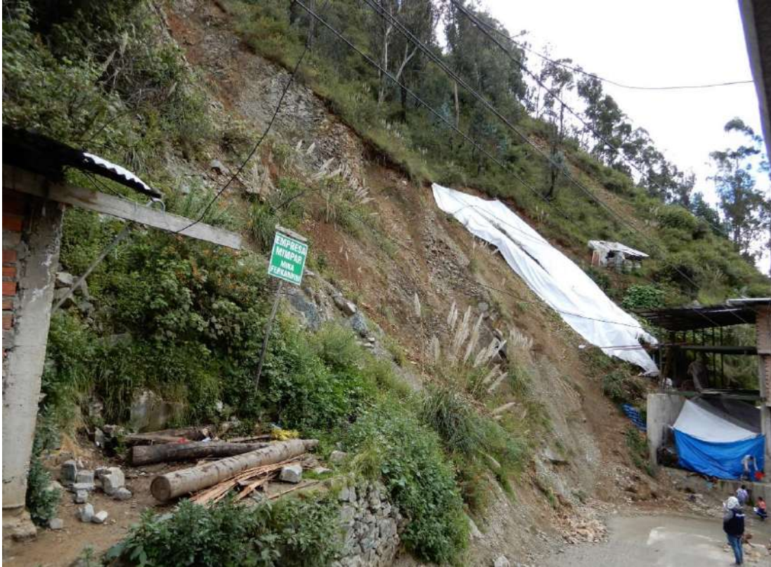
Fotografía 7: Ladera susceptible a la ocurrencia de derrumbes, que pone en peligro viviendas ubicadas al pie de la ladera y un tramo de la vía Retamas-Parcoy.
