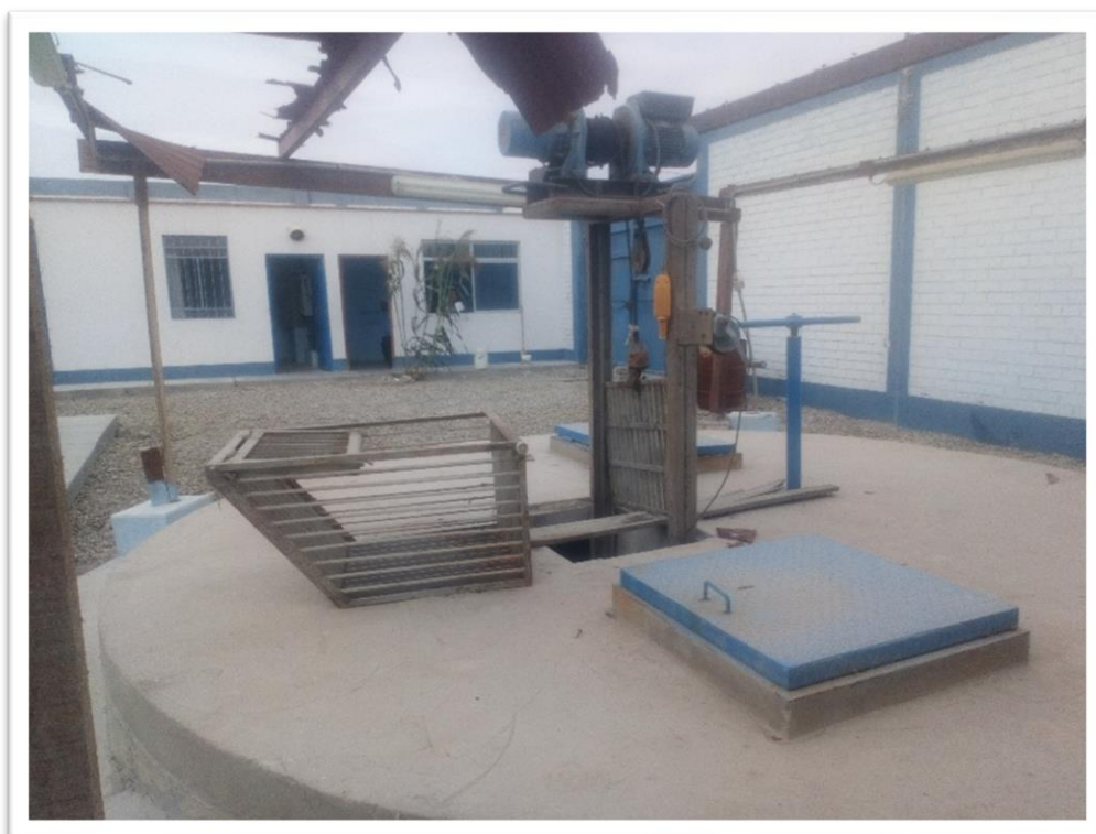
Fotografía 6: Cámara de rejas colocado a un costado por las lluvias, lo cual ha sido afectado por las abundantes lluvias del FEN 2017
