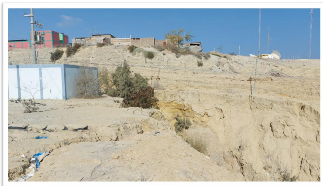
Fotografía 12: Vista frontal del talud erosionado.
