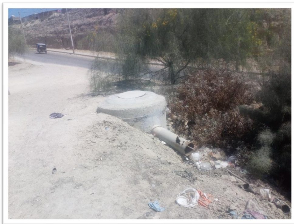
Fotografía 5: Buzón de llegada de la red colectora de desagua hacia la cámara de bombeo N° 01
