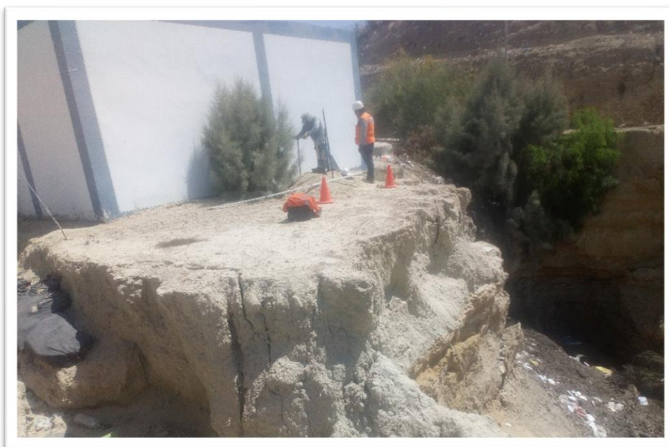
Fotografía 1: Caseta de bombeo N°01. Calicata en extremo exterior de la caseta, al borde del abismo. Verificación de existencia de grietas en sobrecimientos y base del muro perimetral. El suelo adyacente esta erosionado por escorrentías pluviales con pérdida de suelo por desprendimiento del talud.
