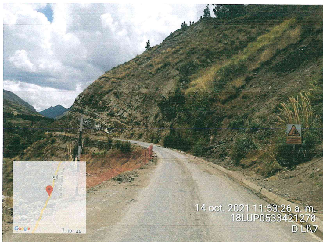
Imagen 8: Deslizamiento en Sector Cashaucro
