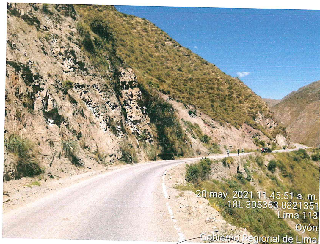
Imagen 7: Deslizamiento en Sector Badopata
