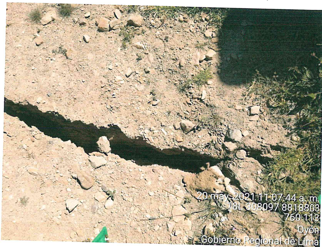
Imagen 6: Fractura en el suelo atravesando carretera en Sector Pucallpa
