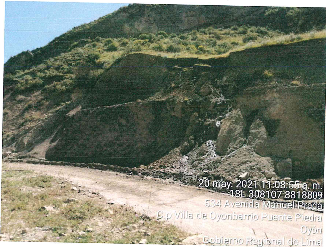
Imagen 5: Deslizamiento en el Sector Pucallpa
