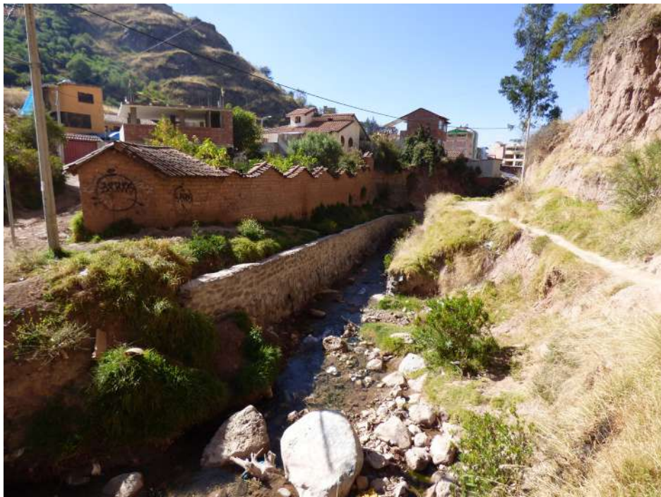
Fotografía 10.26 Procesos de erosión fluvial en ambas márgenes de la quebrada Shihuilla que podría afectar las viviendas.
