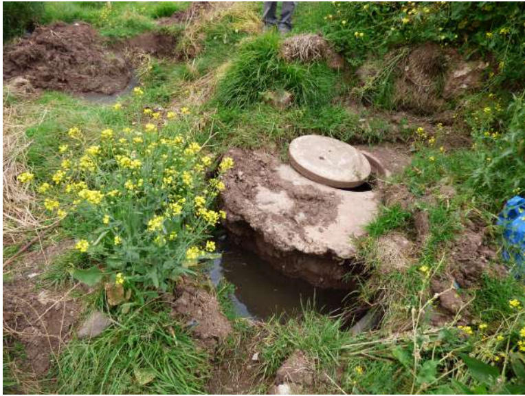
Fotografía 10.31 Saturación del suelo en el cuerpo del deslizamiento ubicado en la Asociación Provienda Camino Real. También, se observa buzón de sistema de alcantarillado que cruza el cuerpo del deslizamiento.
