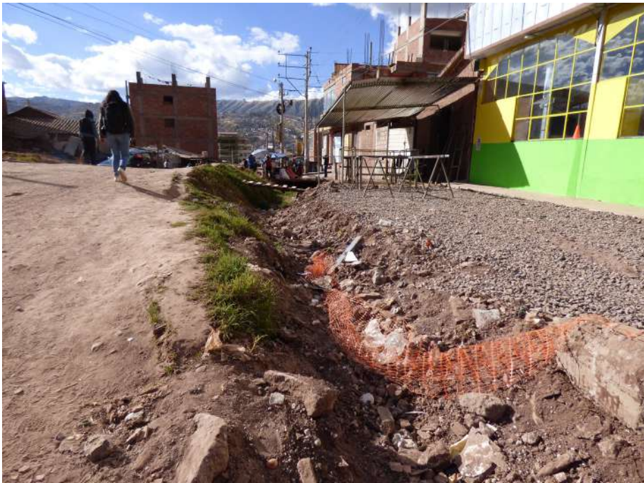
Fotografía 10.18 Vista aguas abajo de curso de quebrada reducido, con viviendas construidas muy cerca.
