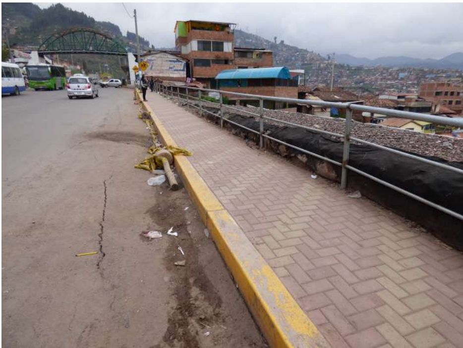
Fotografía 10.45 Grietas en la plataforma de la carretera que cruza la quebrada Saqramayo construida sobre depósito antropógeno.
