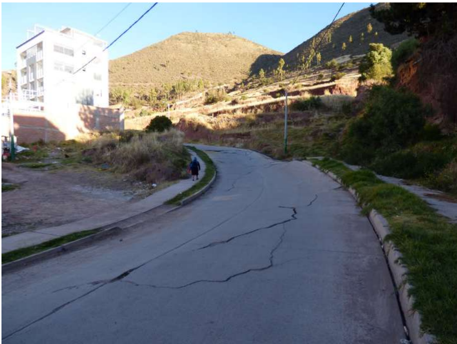
Fotografía 10.22 Se observa múltiples agrietamientos, asentamientos y endulzamientos en la plataforma de carretera.
