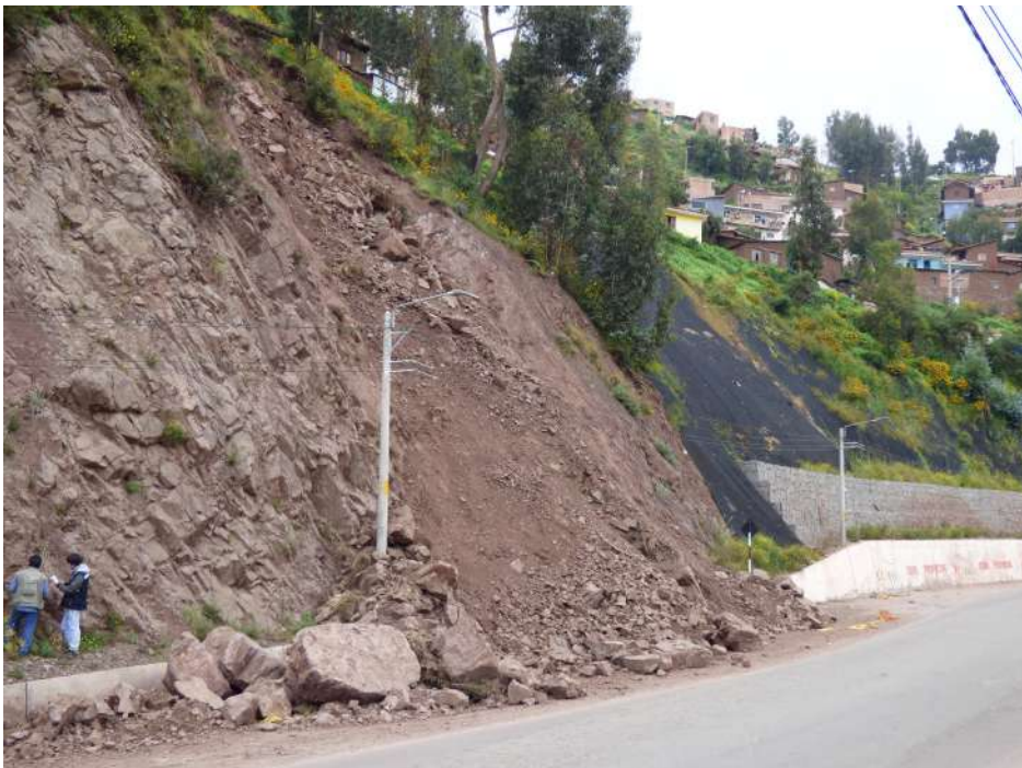
Fotografía 10.38 Caída de rocas y derrumbe en talud de la carretera de la avenida Antonio Lorena. También, se observa muros de contención construidos en base a gaviones y talud cubierto con geomalla.
