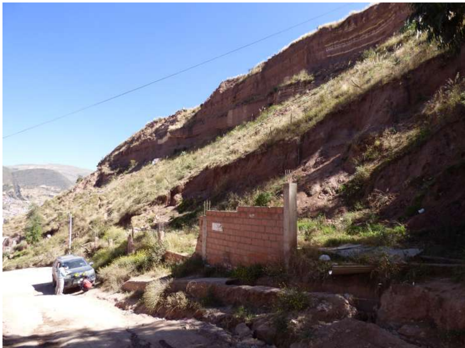
Fotografía 10.10 Derrumbe ocurrido en la margen derecha de cárcava que afectó paredes de ladrillo y concreto de vivienda construida al pie de las márgenes.
