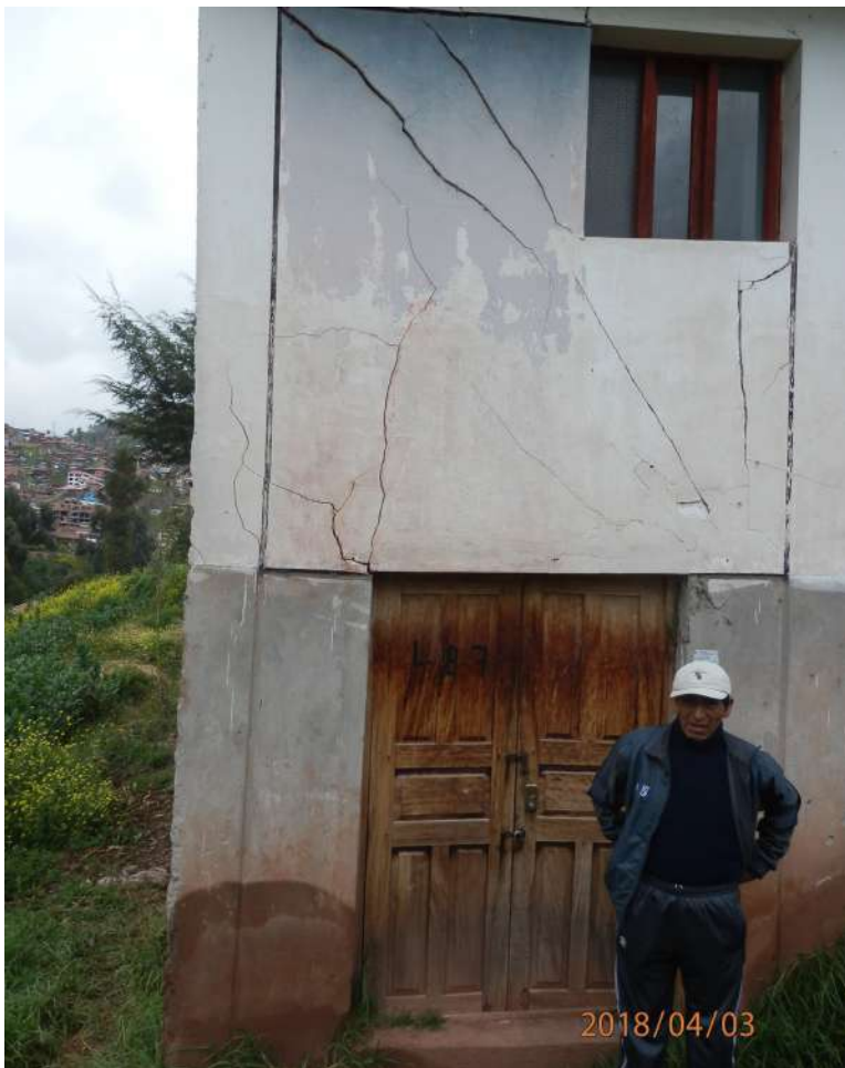
Fotografía 10.32 Vivienda afectada en el lado derecho del deslizamiento; se observa fisuras en las paredes.
