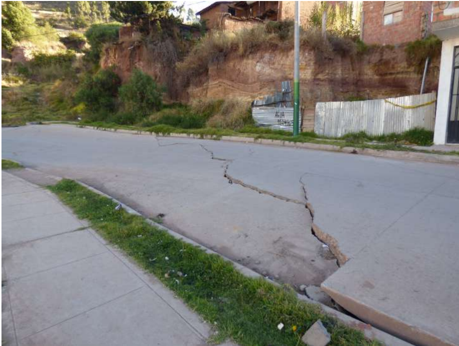
Fotografía 10.21 Vistas de agrietamientos en la plataforma de carretera.
