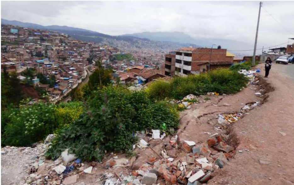
Fotografía 10.41 Talud inferior de la carretera de la avenida Antonio Lorena donde se observa escarpa de deslizamiento.
