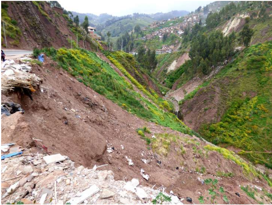
Fotografía 10.39 Vestigios de ocurrencias de derrumbe en ambas laderas de la quebrada Sipaspujo.
