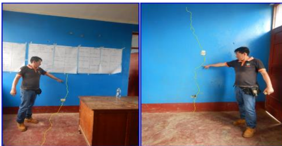
Figura 23. Vista de las grietas en las paredes de la Municipalidad del centro poblado Junín Libertad, ubicado con coordenadas UTM (WGS 84): 607151 E; 8630417 N.
