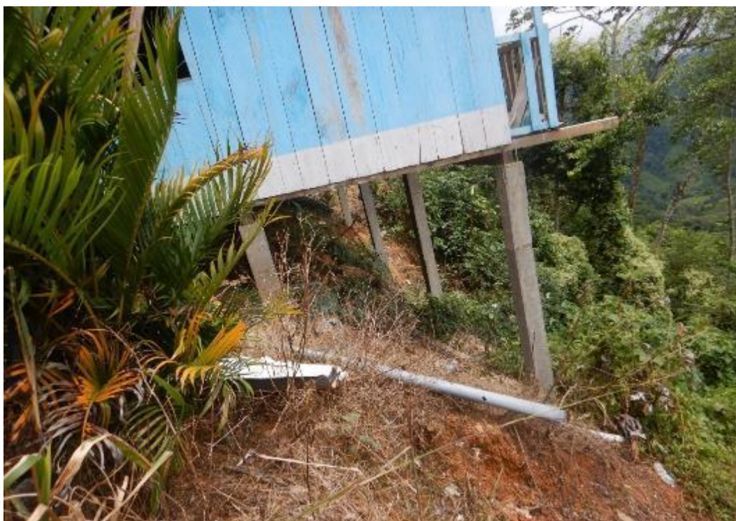
Fotografía 9. Muestra las tuberías de aguas servidas, las cuales desfogon directamente al talud provocando sobresaturación en el terreno, lo cual conlleva a un movimiento en masa ladera abajo.
