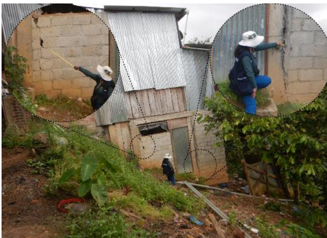
Figura 21. Con coordenadas UTM (WGS 84): 607163 E; 8630416 N, se observa una vivienda ubicada detrás de la municipalidad, presentando grietas en las paredes con aberturas de hasta 5 cm, cabe mencionar que parte de la vivienda colapsó por el arrastre del material con dirección NW.
