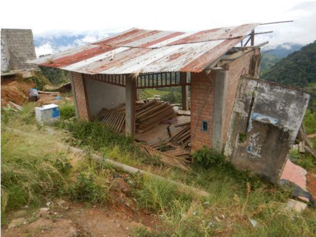
Fotografía 7. Se observa vestigios de las viviendas colapsadas por la ocurrencia del deslizamiento rotacional del 11 de enero del año 2021, ubicada con coordenadas UTM (WGS 84): 607228 E; 8630471 N.
