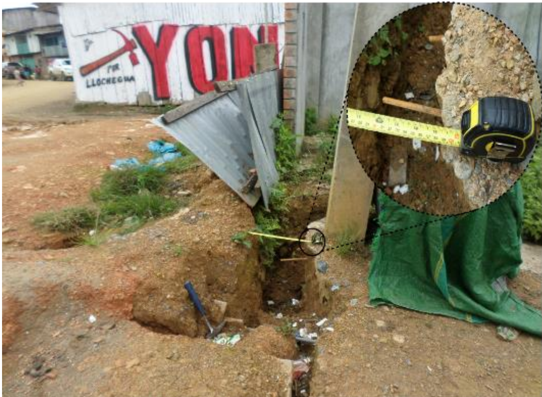
Figura 17. Vista de grietas a 3 m sobre la corona principal del deslizamiento, con separación de 40 cm con profundidad visible de hasta 1 m, ubicado con coordenadas UTM (WGS 84): 607219 E; 8630459 N.
