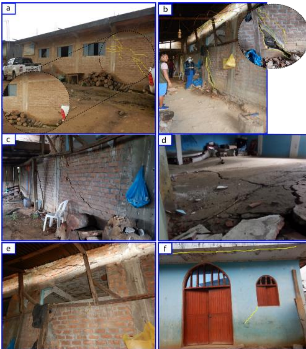
Figura 22. Vista de las afecciones en la Iglesia Evangélica “Las Asambleas de Dios del Perú”, con coordenadas UTM (WGS 84): 607211 E; 8630528 N, a) grietas en la pared derecha exterior hacia la calle, b), c) y e) grietas en la pared izquierda, se observó grietas de hasta 8 cm de abertura y saltos de 15 cm, d) grietas en el piso al interior de la iglesia, f) grietas en el lumbral del techo, actualmente dicha Iglesia se encuentra inhabitable.
