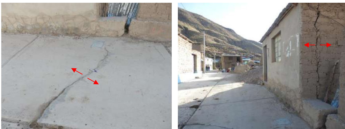
Foto 15: Agrietamientos en las paredes y pisos de viviendas ubicadas en la calle Dos de Mayo, construidos con adobe, las aberturas alcanzan hasta los 3 cm.
