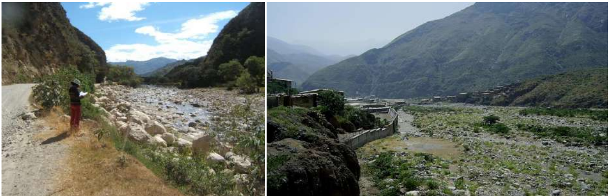
Foto 29. Ejemplo de uso de enrocados para protección de la plataforma de carretera (izquierda). En muchos casos esto debe estar acompañado de un levantamiento de la rasante de la carretera. A la derecha, protección de ribera con muros contra la erosión fluvial e inundación.
