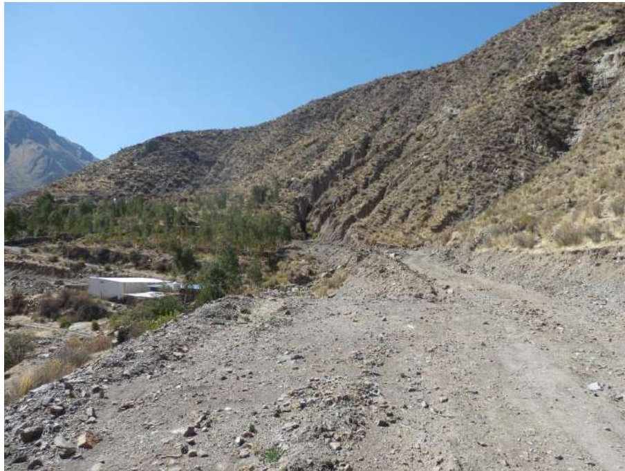
Foto 26: Presencia de erosión en cárcavas, en ciertos sectores se presentan pequeños derrumbes que alimentan torrentes menores afluentes que pueden generar flujos. Puede afectar carretera Yunga-Ichuña en un tramo de 0,5 km aproximadamente por sectores.
