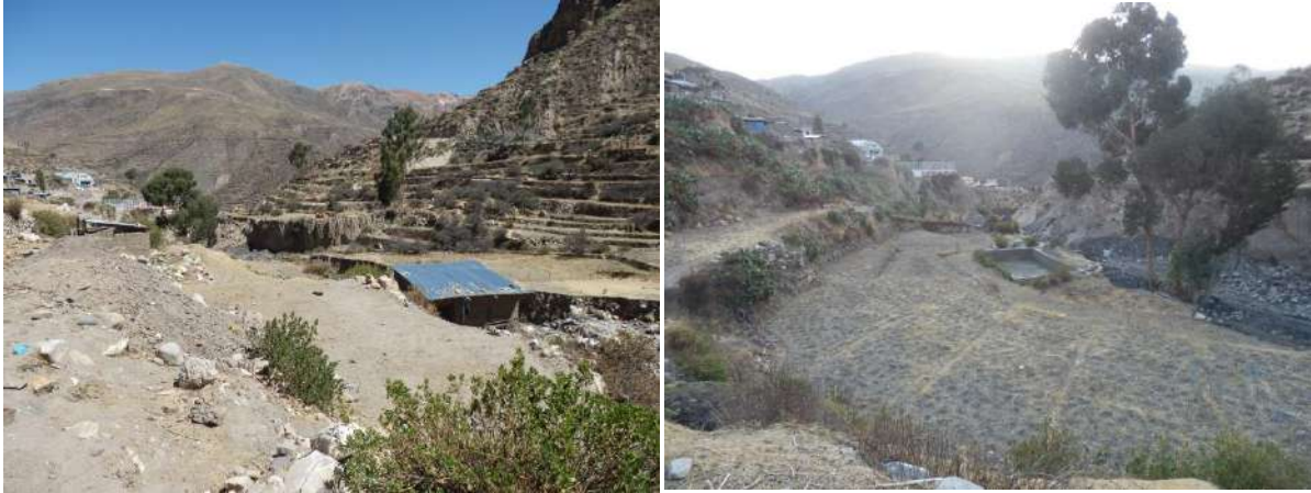
Foto 03: Terraza aluvial en ambas márgenes de la quebrada Yunga (izquierda), en la margen izquierda de la quebrada Yunga, sobre el cual se ubica un reservorio agrietado (derecha).
