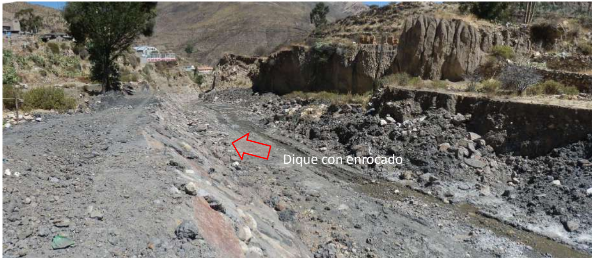
Foto 21: Se ha colocado un dique con enrocado para evitar la frecuente erosión fluvial en la margen izquierda de la quebrada Yunga, que se da en depósitos antiguos de remoción en masa, potentes, con presencia de derrumbes reactivados por erosión fluvial o socavamiento del pie del talud de la ladera o terraza, infiltraciones naturales y de riego.
