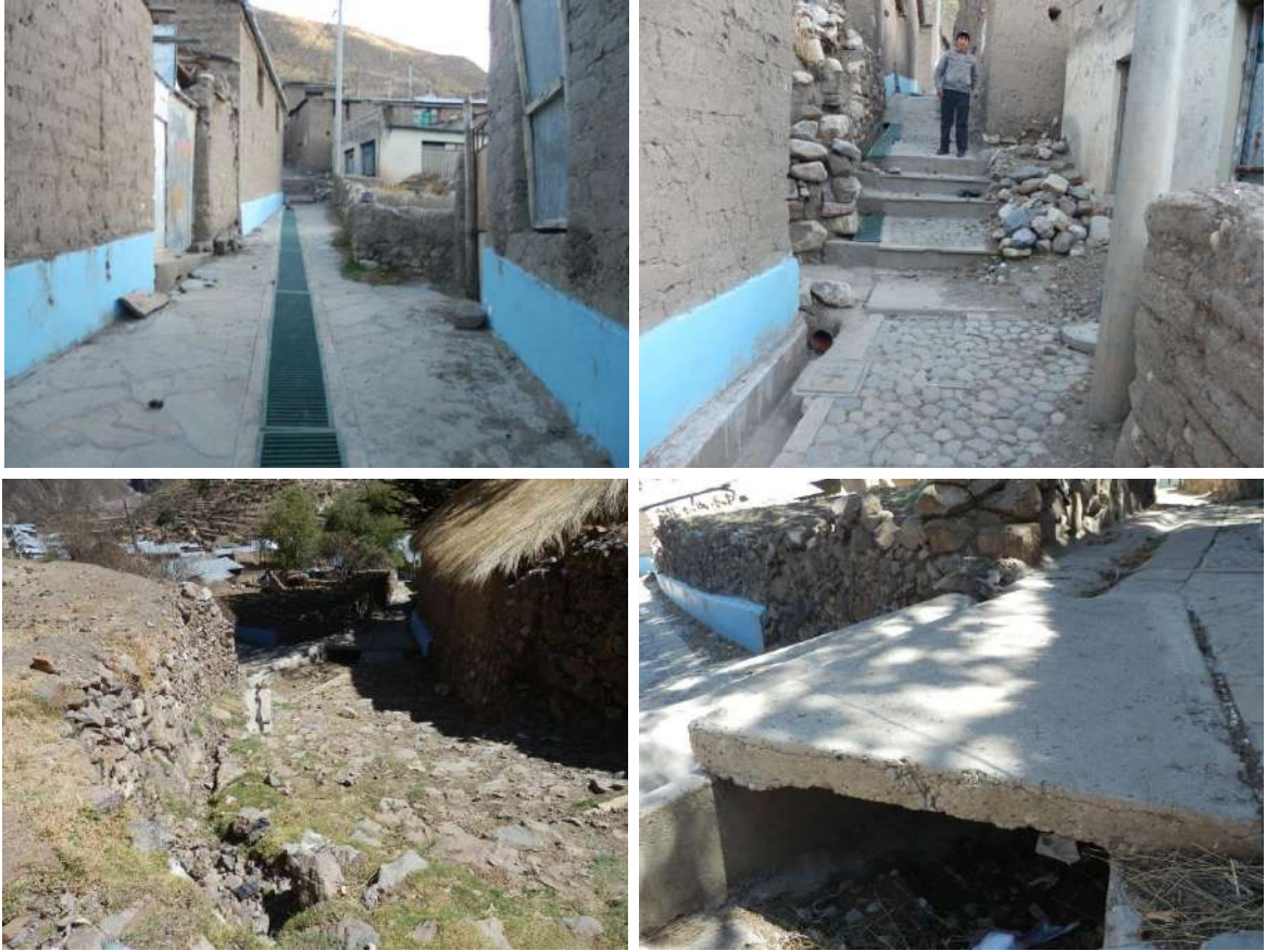
Foto 12: Quebradas encauzadas por canales, de aprox. 35 cm de ancho x 20 cm de profundidad, en la calle Libertad revestido con concreto hace 04 años según la versión de los pobladores (arriba). De la misma manera se encuentra la calle Santa Cruz, aquí se ha colocado un canal con revestimiento de concreto tapado por encima se ha colocado una pequeña cuneta en el km 0+108 Yunga-Ichuña (abajo). Ambas canales sirven a su vez como drenaje pluvial.
