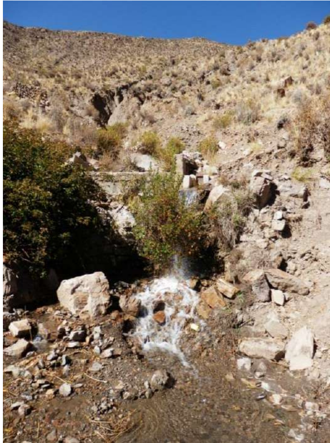
Foto 24: Erosión en cárcavas profundas en el Km 0+713 Yunga-Ichuña, de 230 m hasta 400 m de altura, pueden generar flujos. Afecta la carretera por sectores en un tramo de 0.5 km. El desarrollo de las cárcavas se produce por medio de derrumbes hacia su cara libre; y afectan principalmente terrenos de cultivo y tramos de carretera. Estos procesos, en muchos de los casos son premonitorios de un movimiento en masa como puede ser un deslizamiento, derrumbe, flujo o movimiento complejo.
