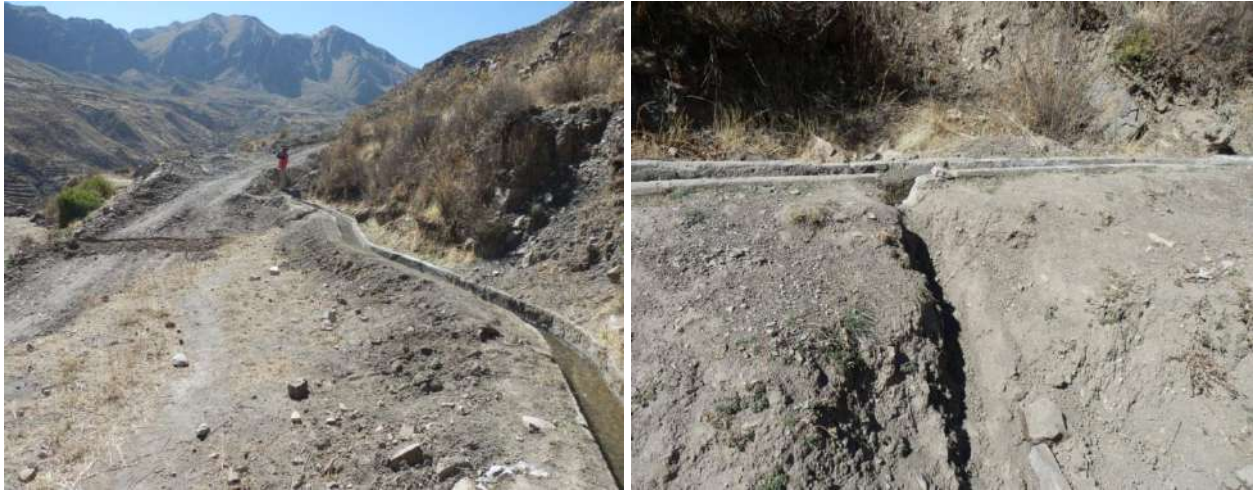
Foto 25: Vistas del canal que pasa por encima del poblado Yunga, en algunos sectores se ha cortado para desviar mediante zanjas hacia los terrenos de cultivo saturando el depósito superficial facilitando así la formación y/o profundización de cárcavas, en el Km 0+530 Yunga-Ichuña.
