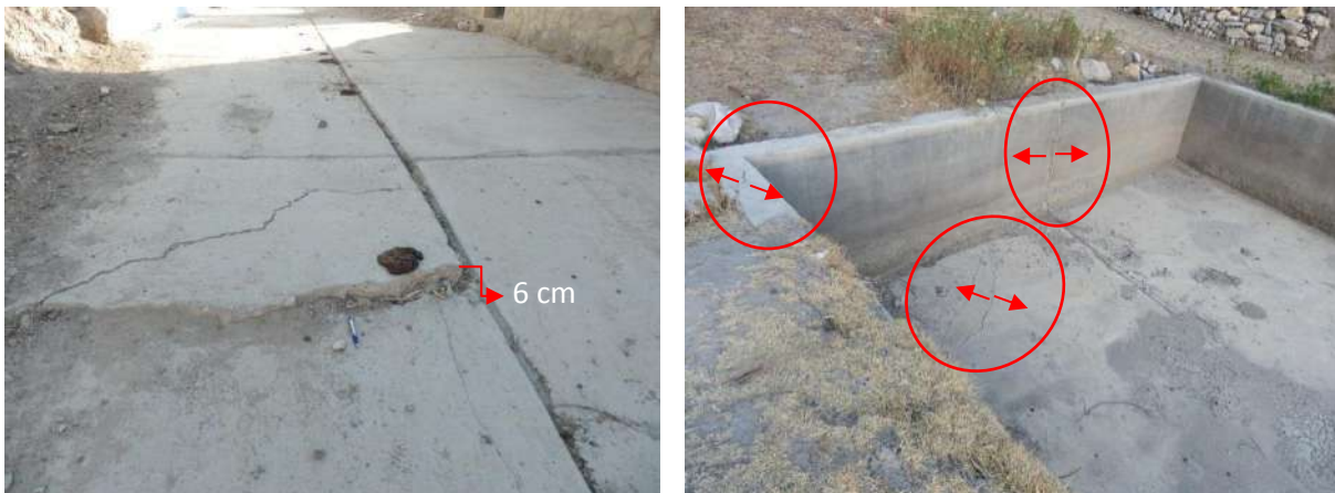
Foto 14: Asentamientos y grietas transversales de 2,5 m de longitud, 5 cm de ancho y 6 cm de profundidad en pavimento de la calle Dos de Mayo, Km 0+400, según versión de algunos pobladores mencionan que en época de lluvias se profundiza el asentamiento (izquierda). Reservorio agrietado en piso y paredes, revestido con concreto en el año 1998 (derecha).
