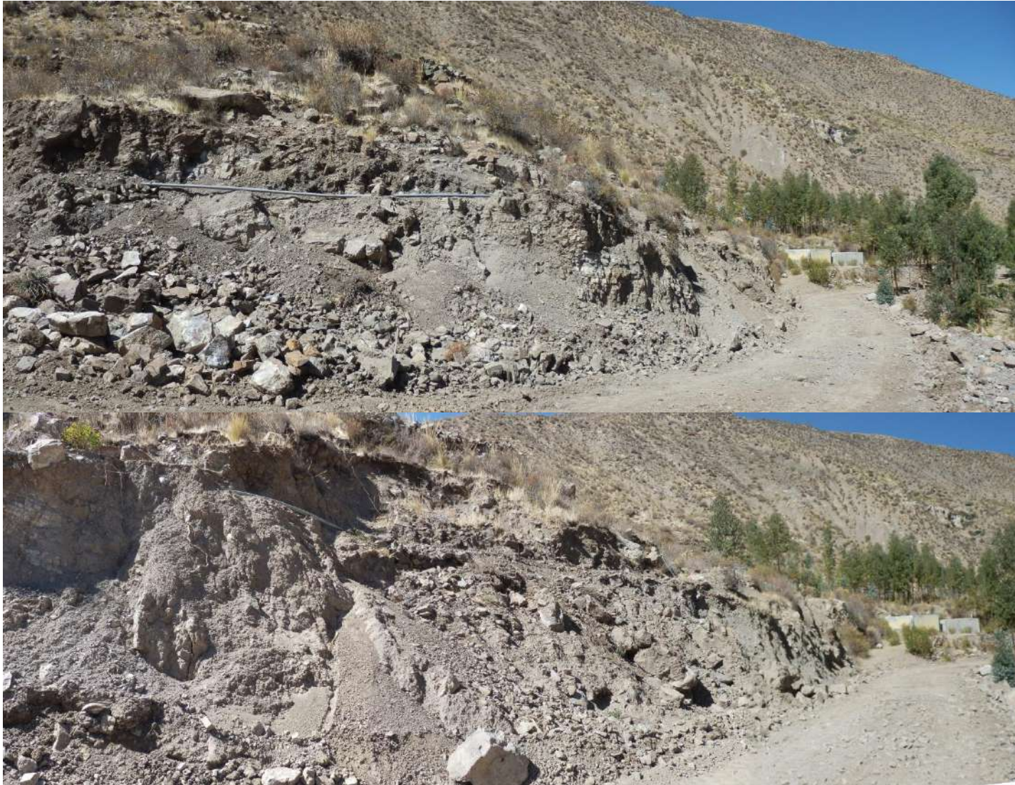
Foto 20: Derrumbes en talud superior de trocha carrozable Yunga-Ichuña
