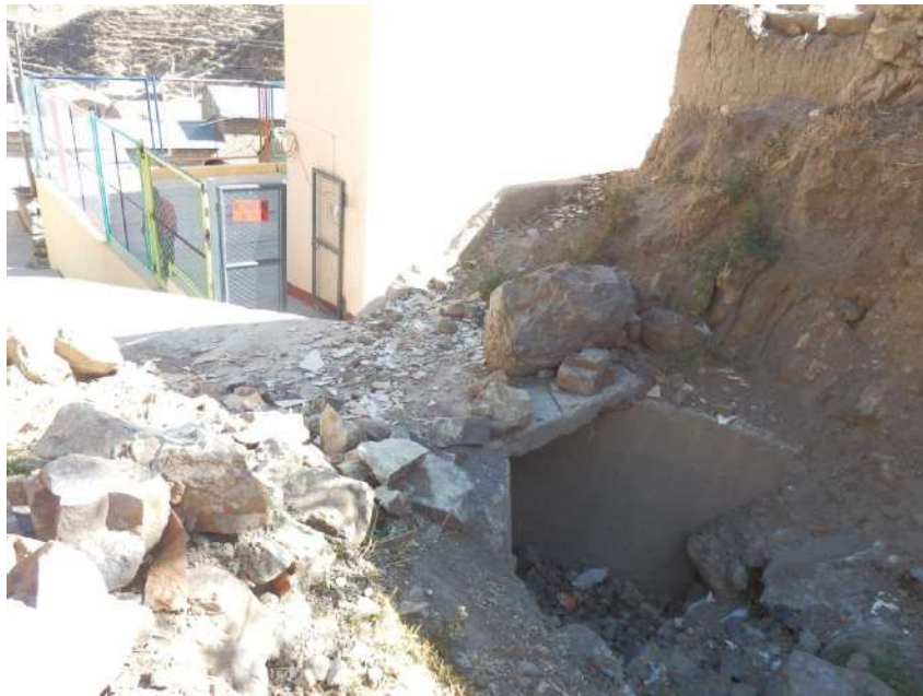
Foto 09: Cauce de quebrada, se ha colocado alcantarilla insuficiente obstruida por detritos y basura en la calle 3. El 16 de diciembre del 2012 el flujo se discurrió por encima de la alcantarilla por encontrarse obstruida, afectando al I.E. Inicial No. 203 que se encuentra muy cerca al cauce. Es decir el cauce retomó su cauce antiguo, desviado por los pobladores.
