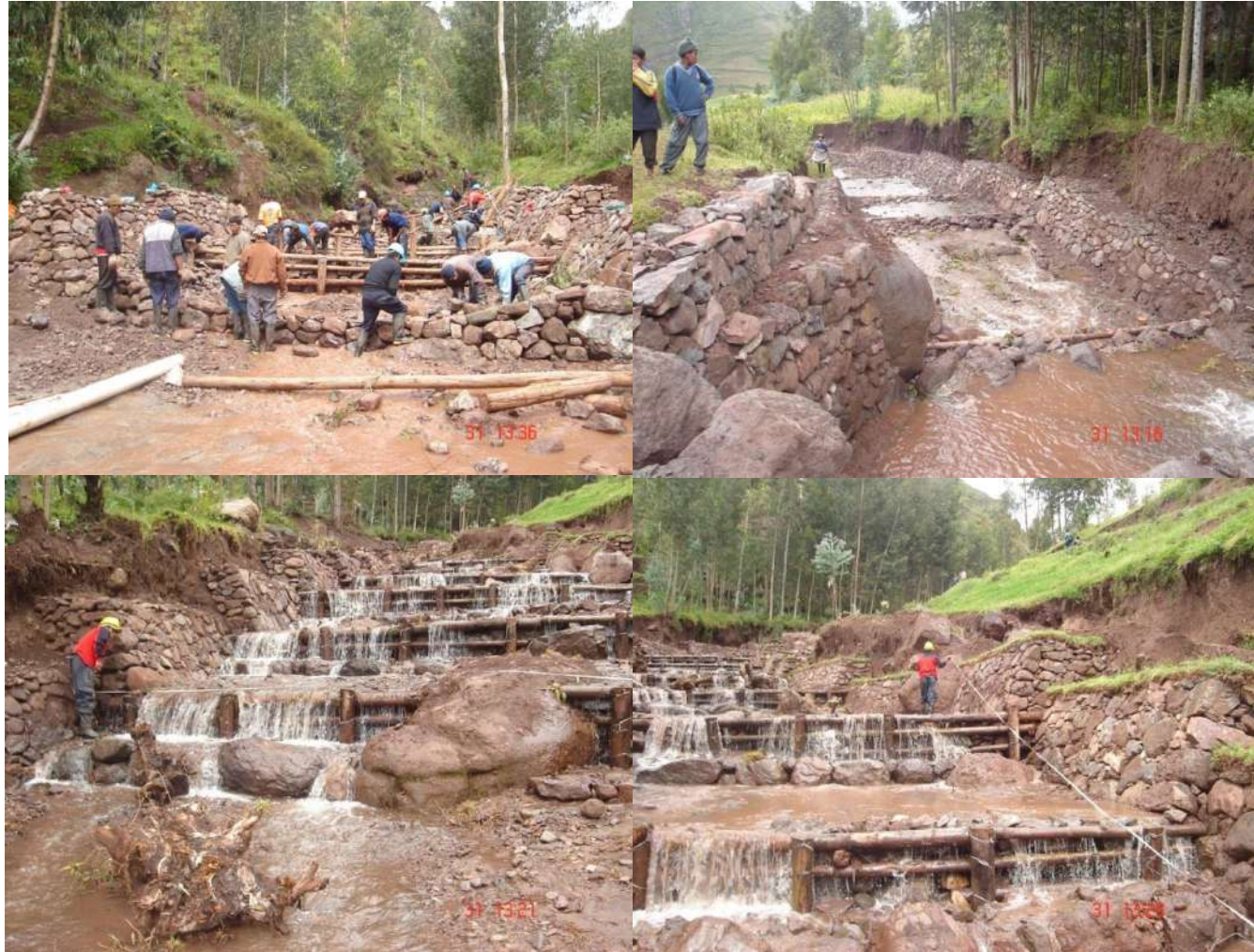
Foto 31. Ejemplos de construcción de disipadores de energía para las corrientes concentradas en el cauce de una quebrada, mediante diques transversales (enrocados) y canalización del cauce con muros escalonados utilizando bloques de rocas para mitigar los efectos ante la ocurrencia de un flujo de detritos. Esto puede replicarse en la quebrada Yunga
