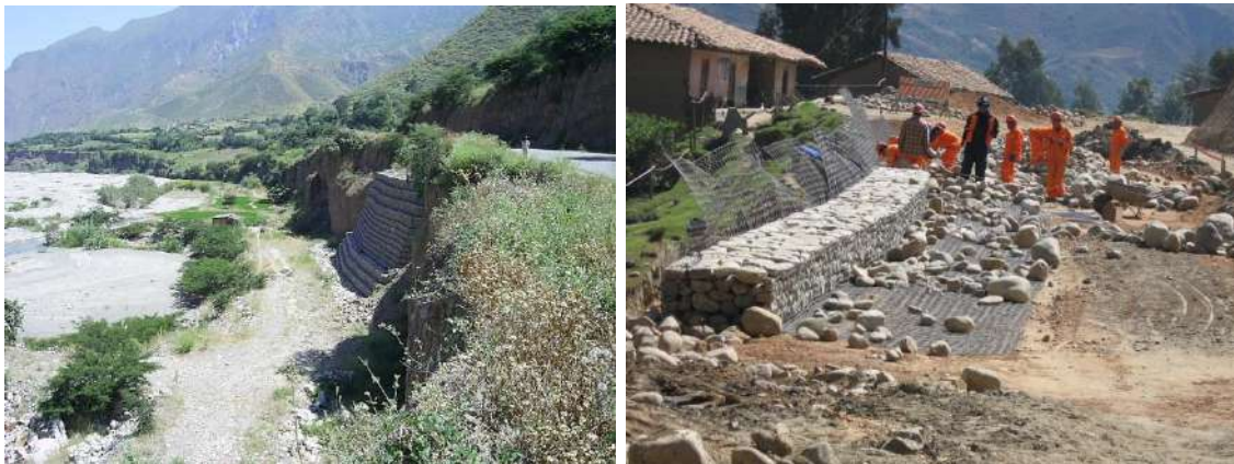
Foto 30. Ejemplos de construcción de muro de gaviones para protección de talud inferior de carretera.
