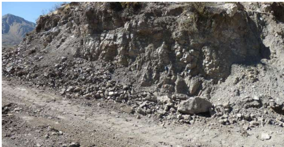
Foto 19: Derrumbes en talud superior de trocha Yunga-Ichuña, se da en rocas sedimentarias (areniscas grises muy fracturadas), taludes casi verticales de pendiente.
