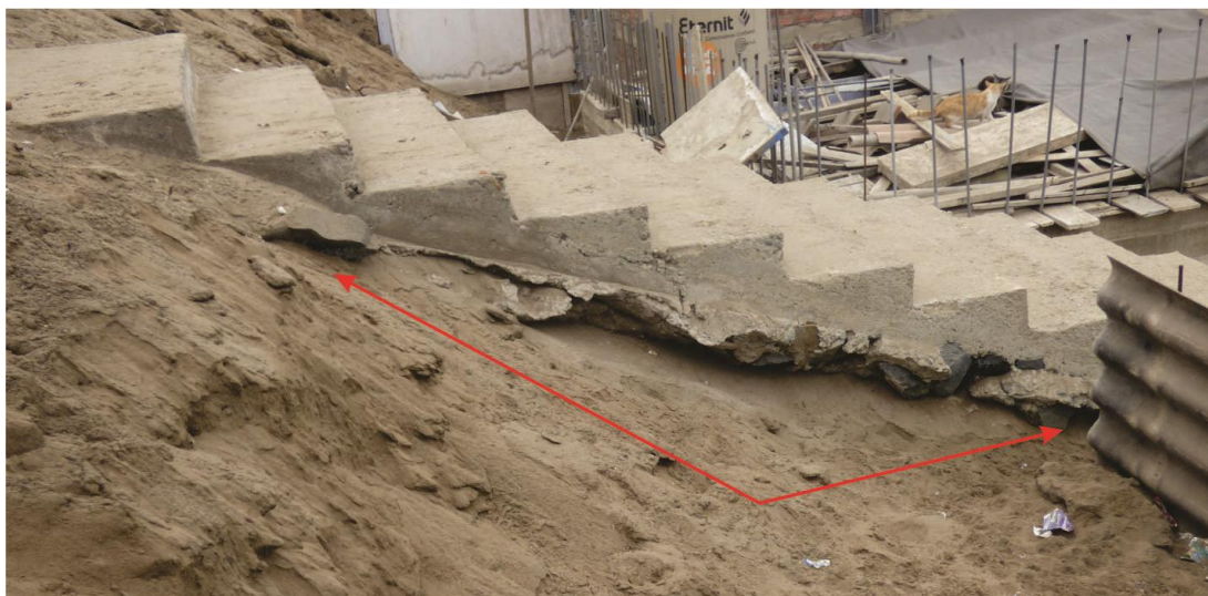
Foto 19. La base de la escalera esta "flotando", tramo señalado con líneas rojas.
