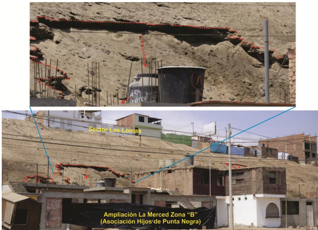
Foto 15. Se aprecian los derrumbes localizados (líneas punteadas de color rojo), formadas por el corte de talud.
