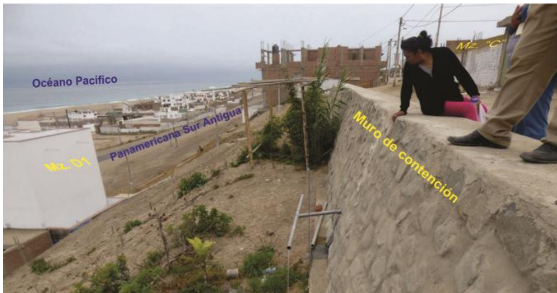
Foto 23. Se aprecia el muro de contención, ubicado entre las manzanas "D1" y "C".
