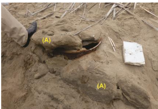
Foto 8. Se aprecia sobre el buzón de desagüe abandonado, la tapa está cubierta por una capa de sal (A).
