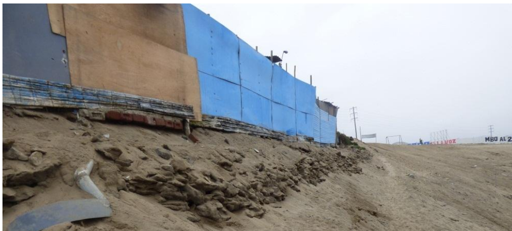
Foto 14. Vivienda asentada sobre un relleno.
