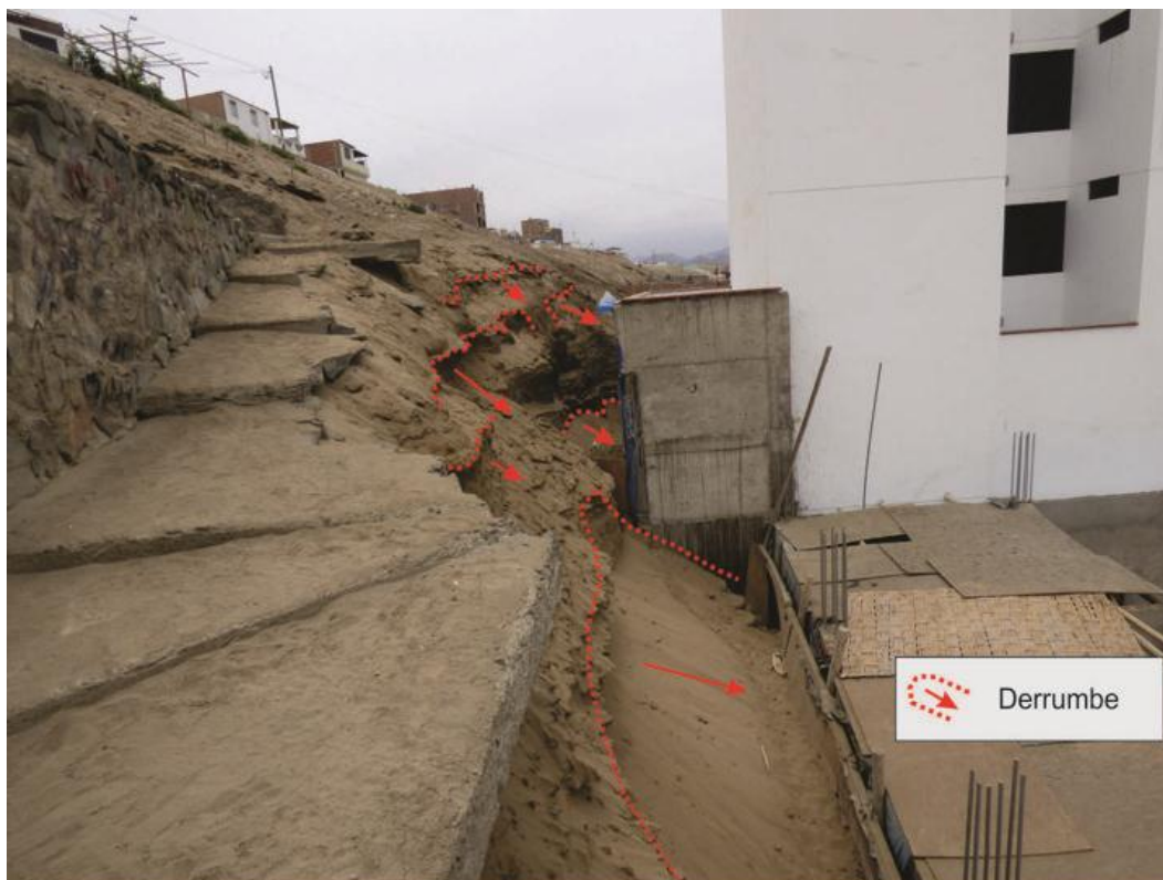
Foto 22. Se aprecian “derrumbes localizados”, que están rellenando parte del vacío.
