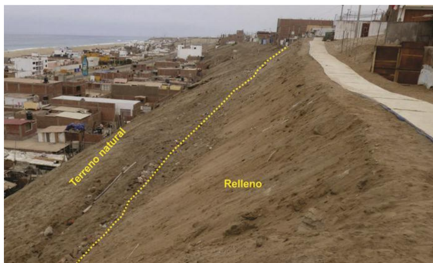
Foto 28. Se aprecia el terreno natural y el relleno. Se observa la vereda deformada.
