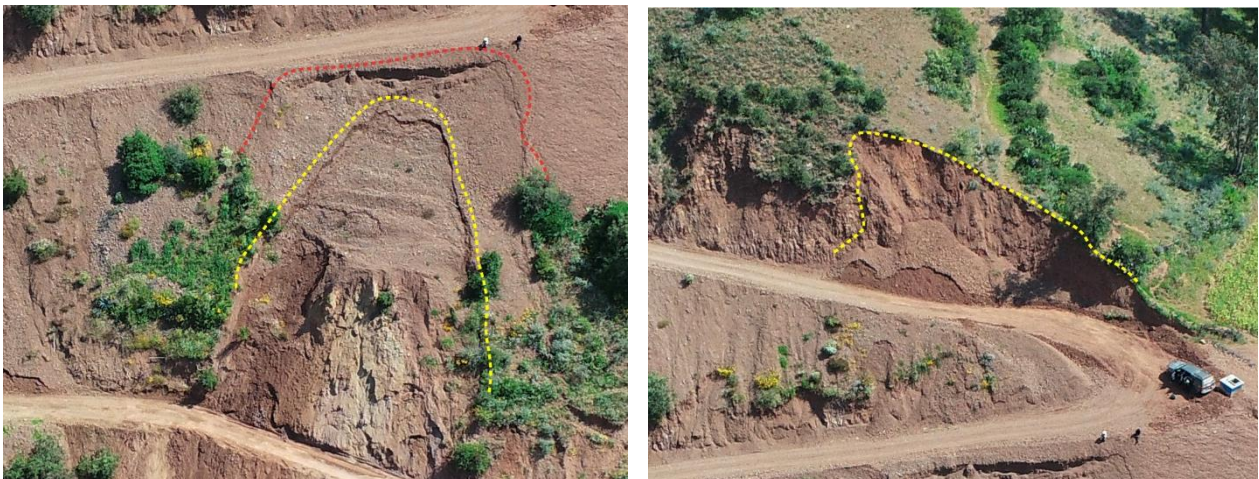
Figura 28. Vista aérea donde se observan los deslizamientos y grietas en un tramo de la vía vecinal, afectó un carril. En la imagen de la izquierda es un evento a deslizarse y en la imagen de la derecha es un deslizamiento ya ocurrido.
