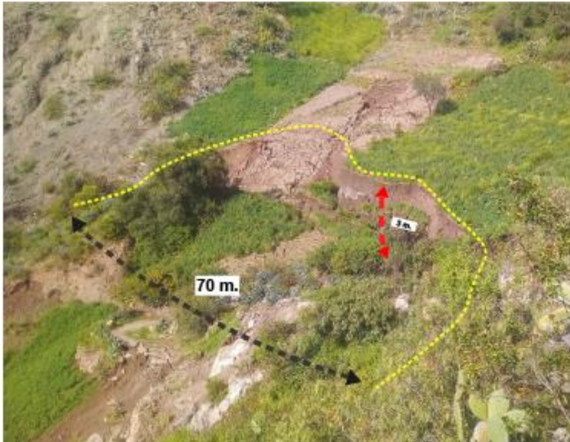
Figura 25. Vista donde observa de color amarillo en línea punteada escarpa del deslizamiento de 70 m. con un salto de 3 m.
