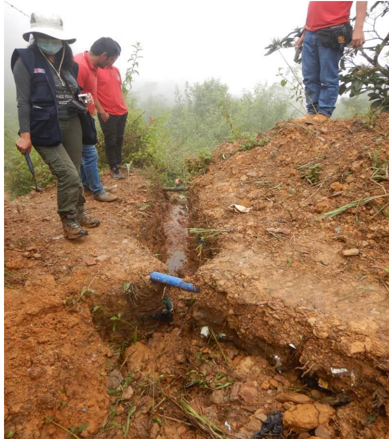
Fotografía 4. Vista donde se observa depósitos antrópicos en donde instalaron dos tuberías de PVC, ubicado en las coordenadas UTM 8623429 N, 612457 E con una altitud de 1285 m s.n.m.
