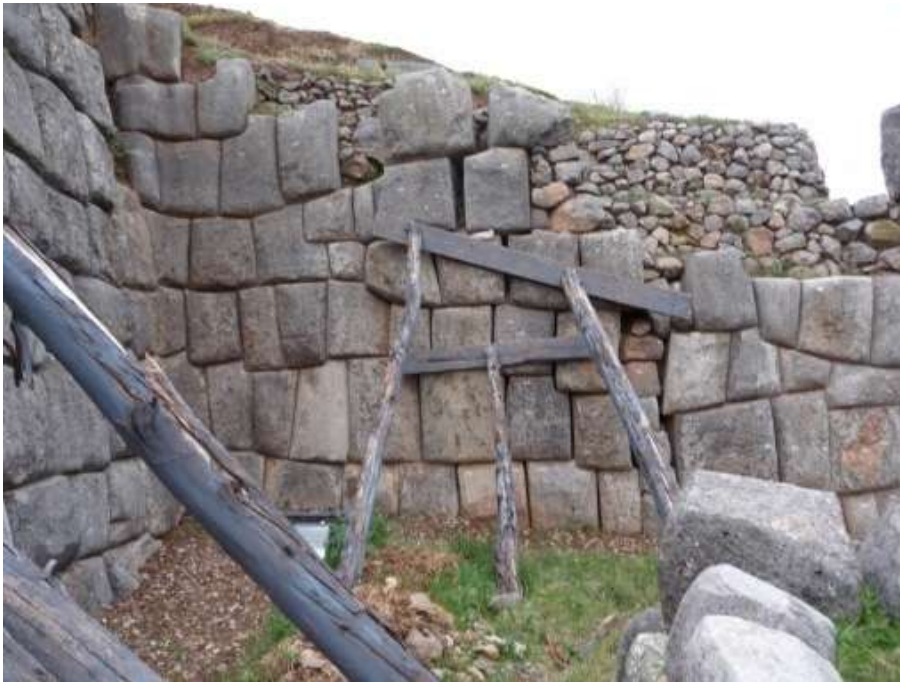
Foto 21. Muro con bloques con separación de juntas por presión lateral y asentamiento.
