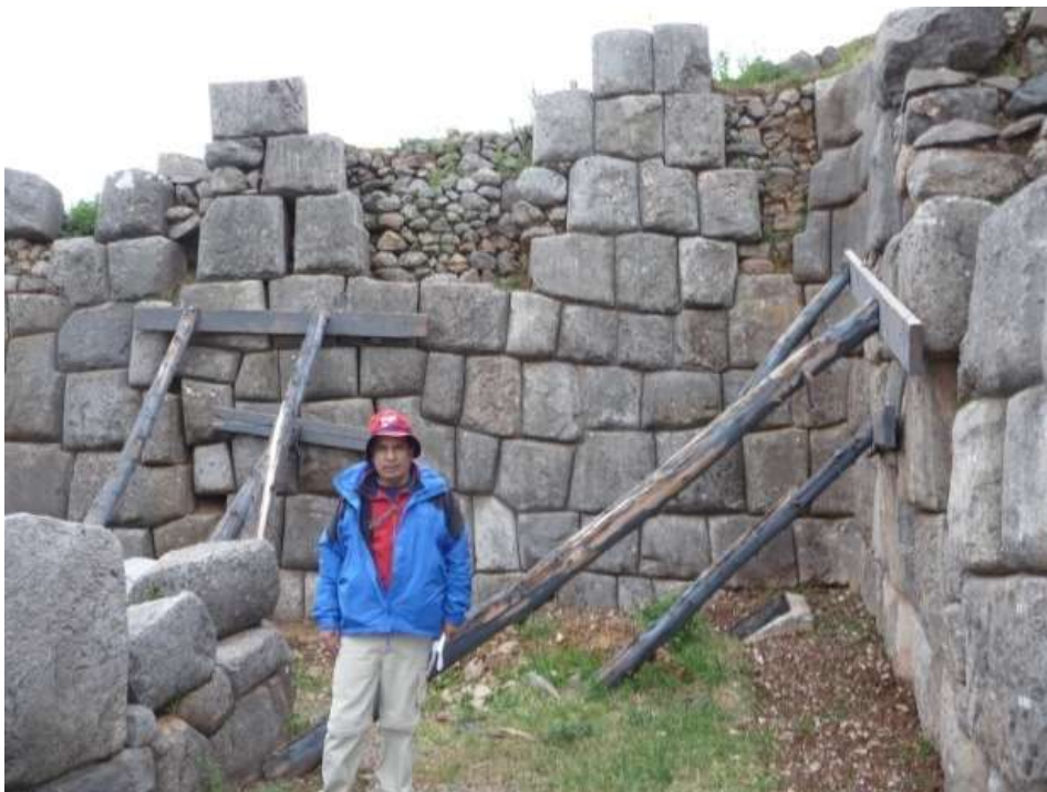
Foto 22. Muro con separación de juntas por presión lateral, y pandeamiento.
