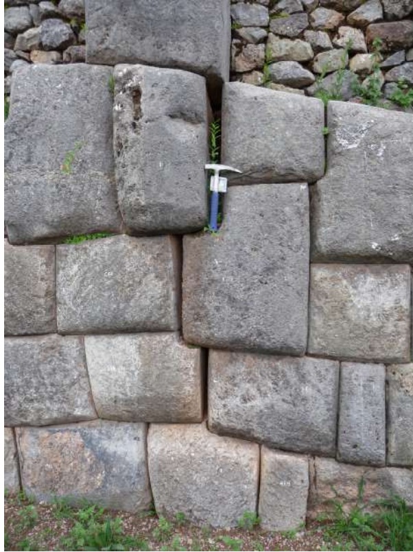
Foto 15. Muro afectado por empuje lateral y asentamiento.
