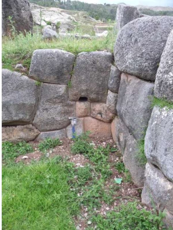
Foto 11. Drenaje en la esquina de un zigzag que se encuentra por encima del piso actual.
