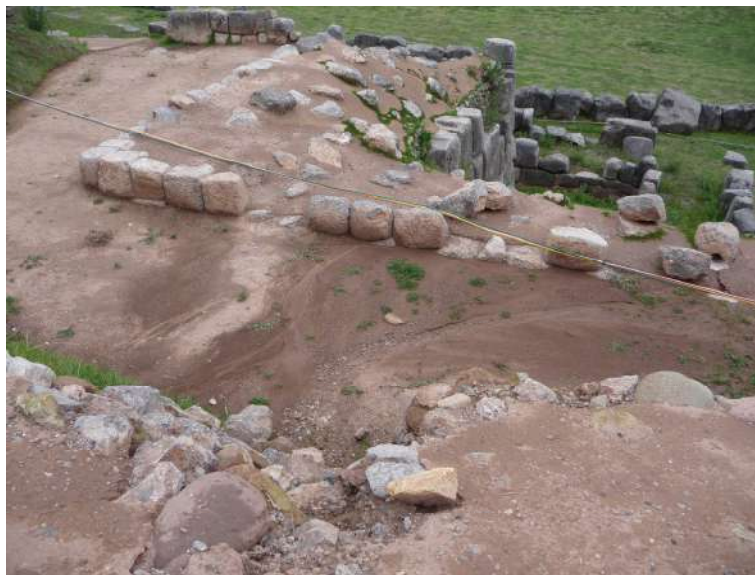
Foto 26. Desagüe de las aguas pluviales hacia el muro del Tercer Nivel.
