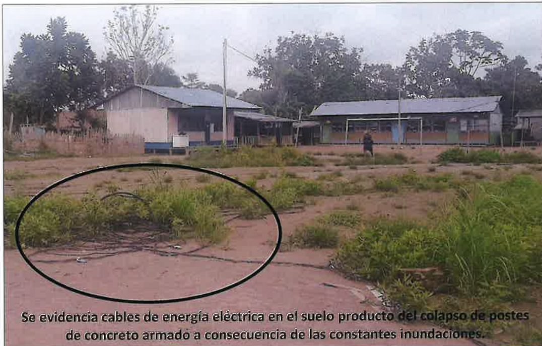
Fotografía N° 11. Cables del Servicio de Energía eléctrica
