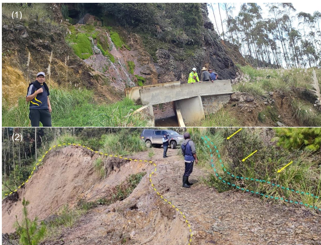
Figura 38. Análisis longitudinal del deslizamiento, arriba: aflente de escorrentía superficial natural que es desviado a través de un dren en mal estado; abajo: vista de un dren colmatado por el movimiento de la ladera. La ubicación de esta fotografía se presenta en la Figura 37.
