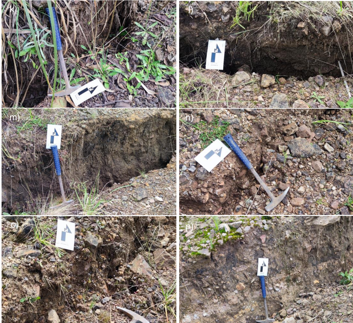
Figura 36. Detalle de los escarpes y agrietamientos del deslizamiento principal del cerro Chicche (k, l, m, n, o, p), la ubicación de estas fotografías se muestra en la Figura 34.
