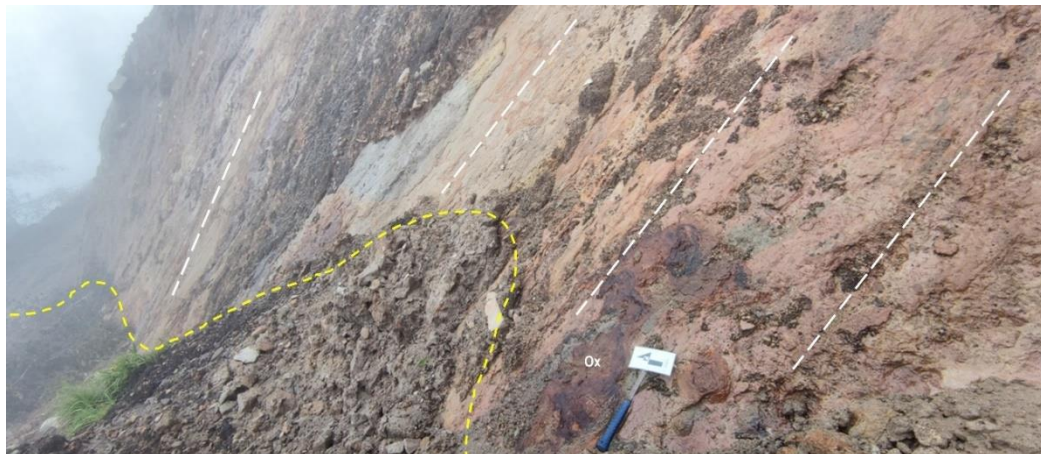
Figura 48. Detalle de la superficie de falla del deslizamiento traslacional, donde se aprecian óxidos hidrotermales (Ox) como relleno de discontinuidades.
