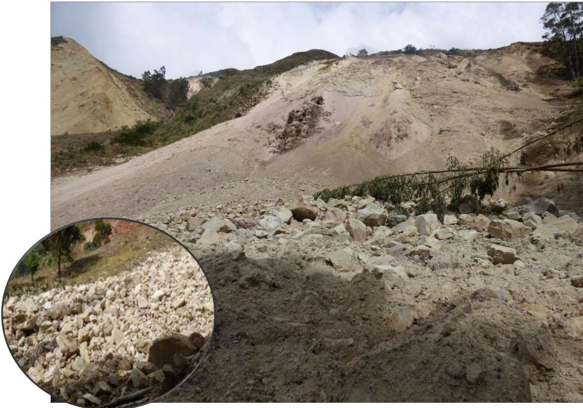
Figura 11. Flanco izquierdo del derrumbe, compuesto por bloques de formas angulosas, con diámetro mayor a 1 m, arenas y limos inmersos en material lodoso, muy inestable al paso.
