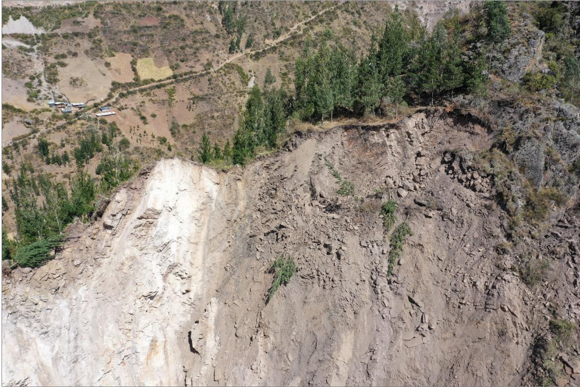
Fotografía 5. Vista de la zona de arranque del derrumbe (rocas muy fracturadas y alteradas), es notoria la presencia de material suelto inestable, el cual podría ceder cuesta abajo.
