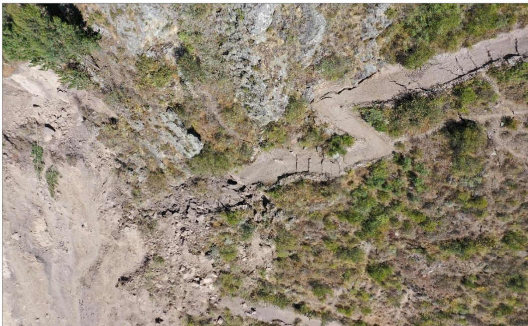
Fotografía 8. Vista de los agrietamientos múltiples y continuos, producidos en el camino que conducía al mirador de Cerro Cruz de Shallapa.
