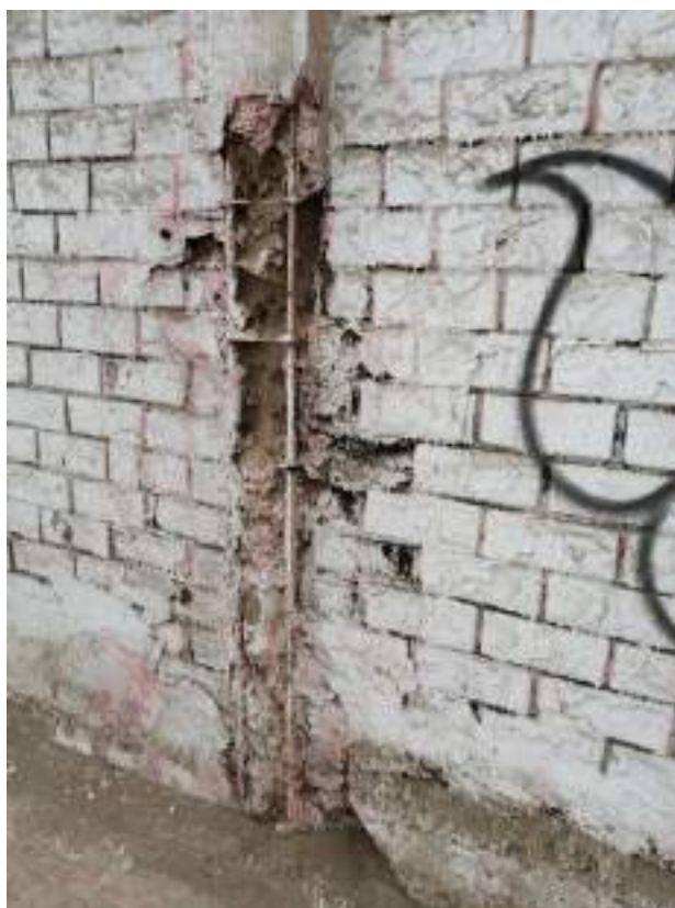
Foto N°16 elementos estructurales (columna), fierros expuestos.
