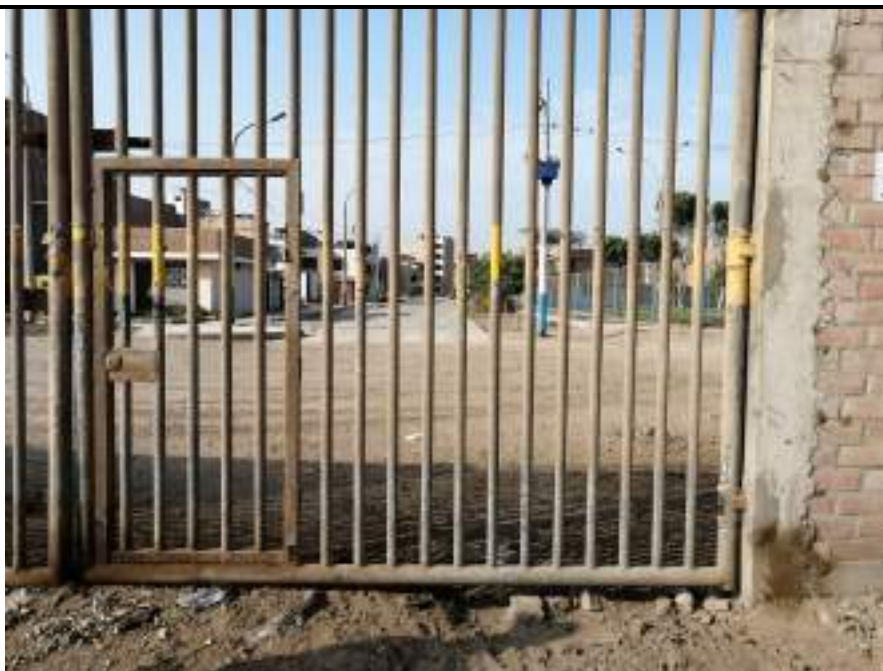
Foto N°17 rejas cerradas en el cerco perimétrico de la Urb. Las viñas de Surco de Oquendo, éstas que obstaculizan una eventual evacuación.
