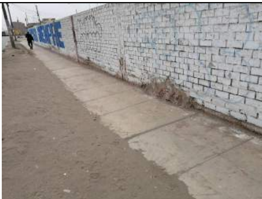
Foto N°15 Cerco de ladrillos en muy mal estado de conservación.
