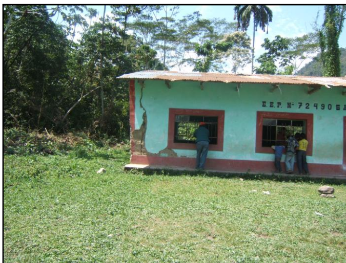
Foto2.- Aula del centro educativo Santa Rosa de Yuracmayo N° 72490, donde se observa la pared que fallo, a raíz de las inundaciones del 29 de julio del año 2007.
