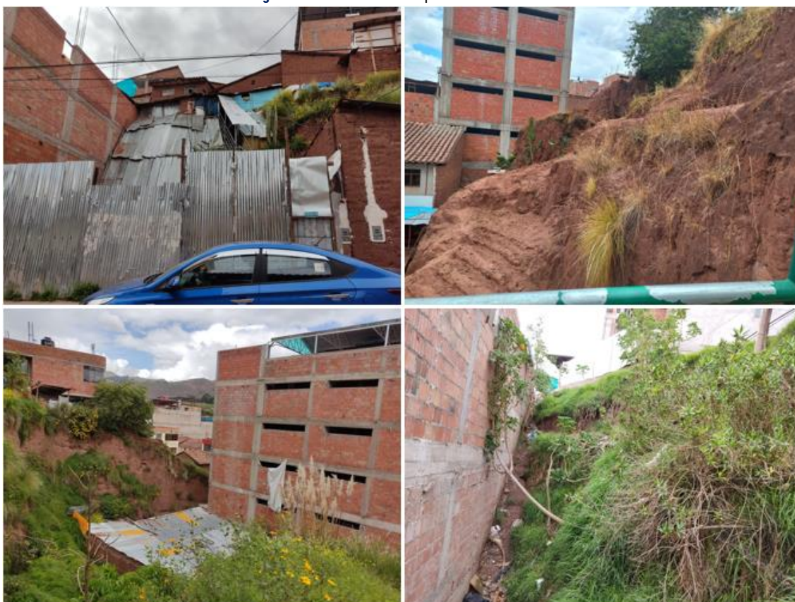
Fotografía 13: Zonas más susceptibles a caída de suelos.
