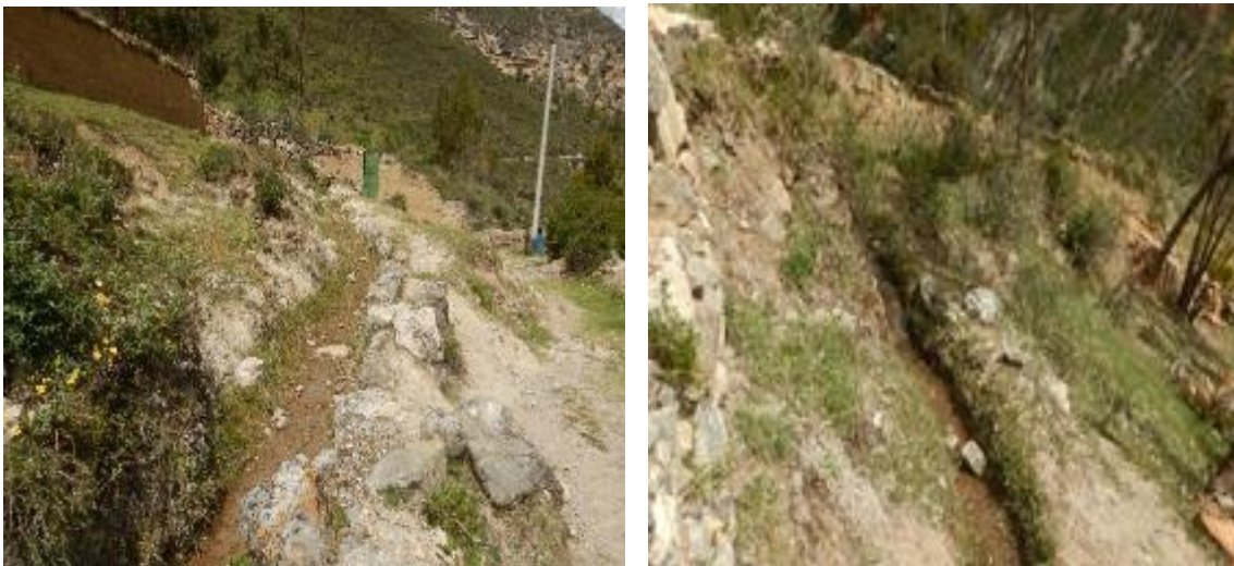
Figura 20. Casi la totalidad los canales se encuentran sin revestimiento en este sector.
