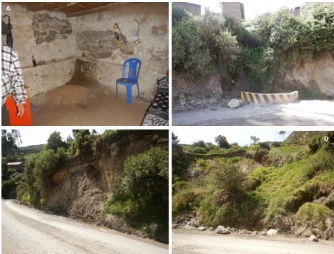
Figura 21. Filtraciones en diferentes puntos del sector en estudio (A) filtraciones dentro de vivienda., (B) Filtraciones en la parte alta de muro de contención; (C y D) se observa filtraciones producidas por lluvias que filtran hacia lados de carretera, las mismas que en su mayoría no presentan canales de drenaje.
