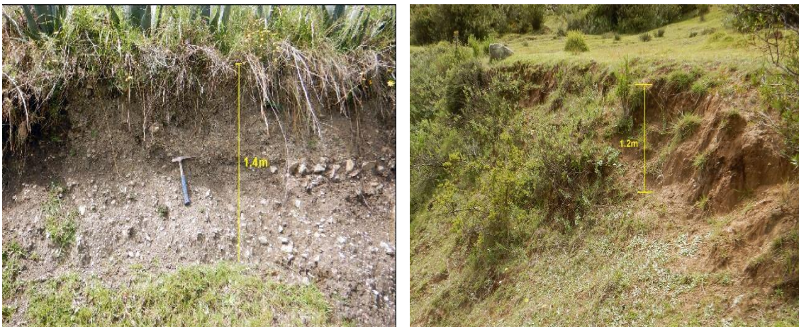
Figura 15. Se observa bloque de rocas sedimentarias que oscilan de 2 a 4.2 m, que llegaron a afectar a dos viviendas, actualmente dichas viviendas repusieron sus techos de calamina, que fueron afectadas.
