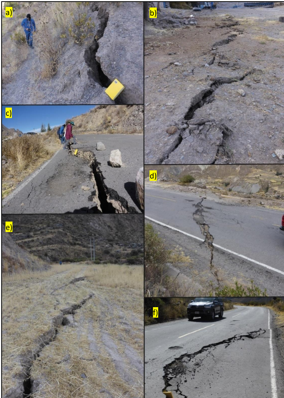
Figura 4. Grietas ubicadas en las siguientes coordenadas UTM WGS84: a) P7- 224756E, 8278430N; b) P8 - 224624E, 8278530N; c) P18 - 224765E, 8278616N; d) P14 - 224790E, 8278952N; e) P10 - 224600E, 8278761N y f) P23 - 224915E, 8279127N.
