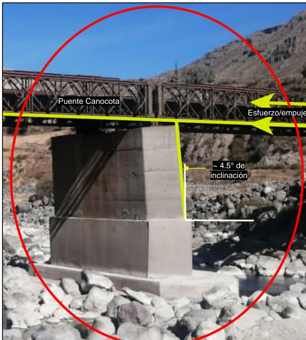
Figura 3. Inclinación del puente Canocota, aproximadamente 4.5°
