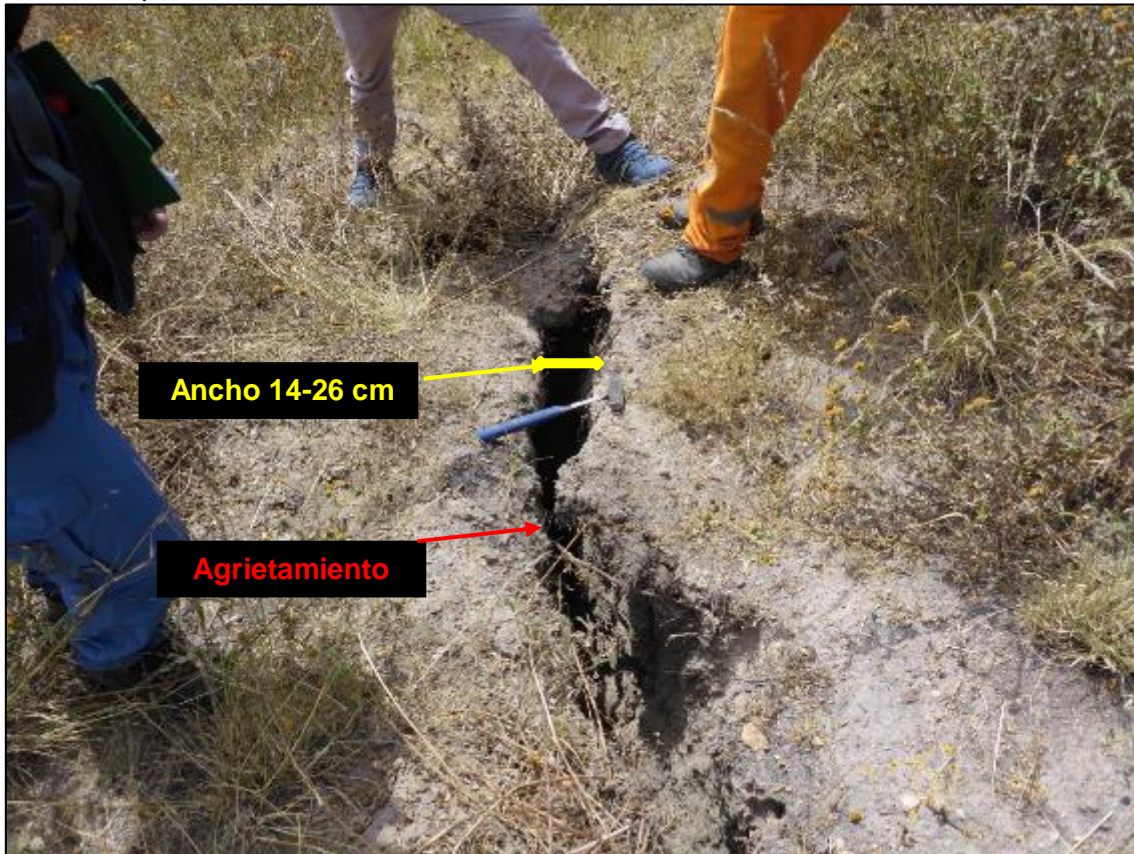
Figura 11. Agrietamientos en el sector de Osocon ( RCT1 ) (coordenadas UTM E: 300701, N: 8185473)
