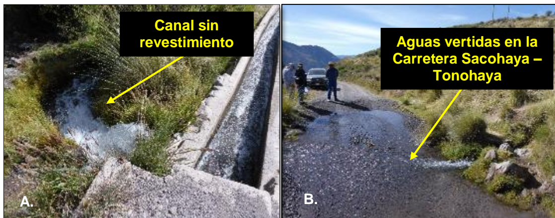
Figura 8. A. Canal sin revestimiento que transporta el agua hacia la comunidad campesina Tonohaya. B. Emanación de aguas vertidas por el canal sin revestimiento en la carretera Sacohaya-Tonohaya parte alta de Tonohaya (coordenadas UTM E: 300175, N: 8184952).
