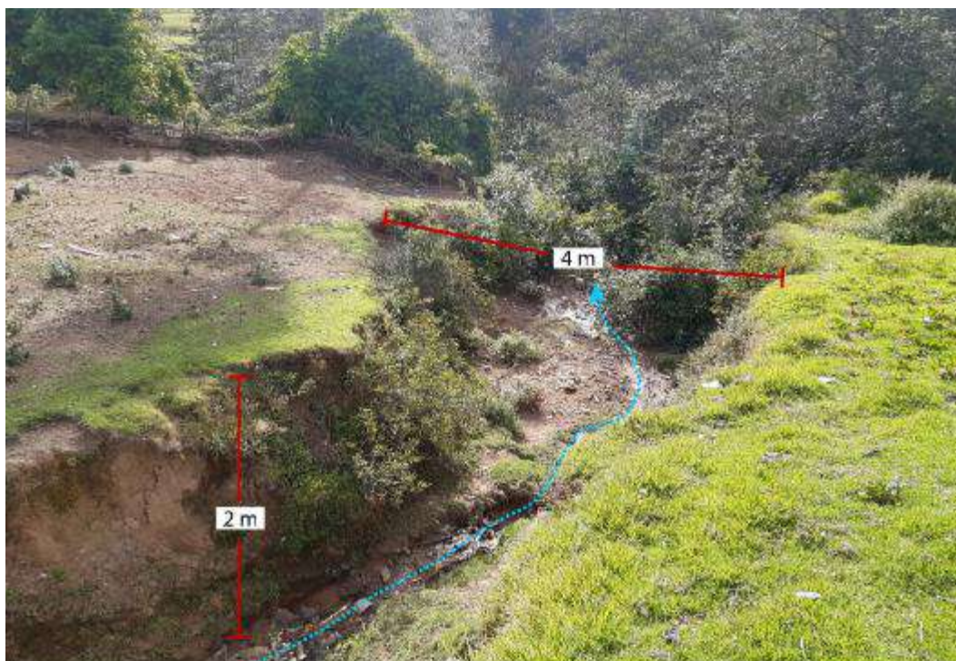
Figura 16: Vista de la erosión en cárcava, con coordenadas UTM (WGS 84): 361238 E; 8861224 N, donde por la erosión retrogresiva en sus márgenes, presenta un ancho de 4 m y profundidad de 2 m
