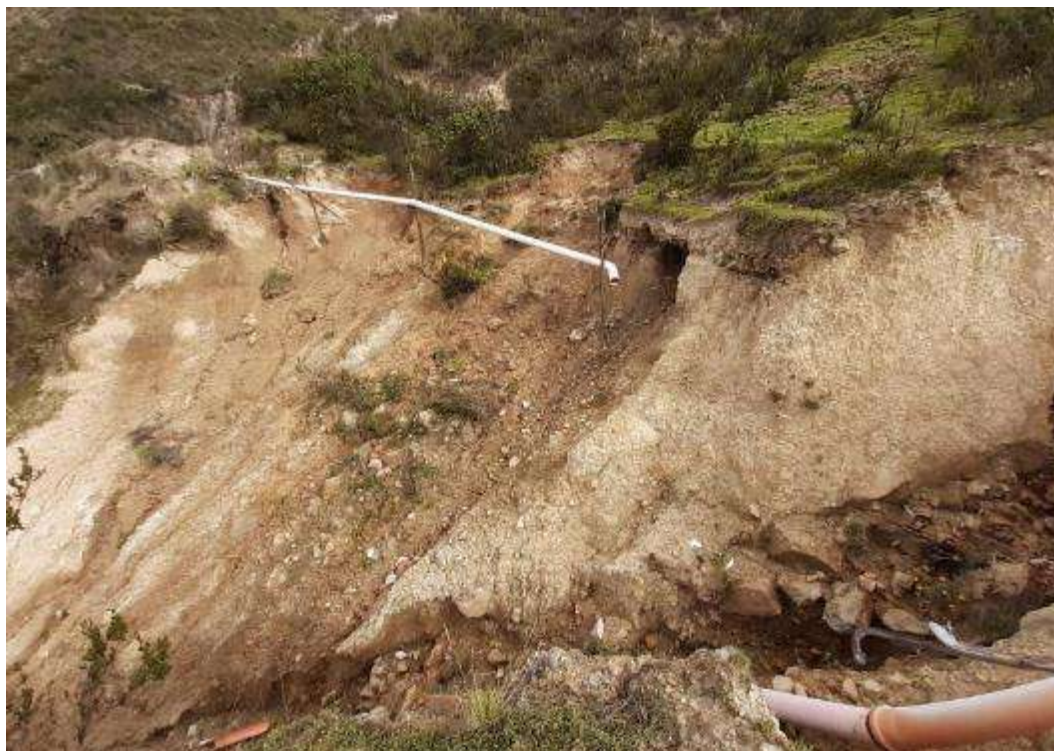
Fotografía 7. Vista del derrumbe, el cual afecta 20 m de la tubería de riego de Taurio, ubicado en el flanco este del cerro Rumichaca, con coordenadas UTM: 361389 E, 8860272 N.
