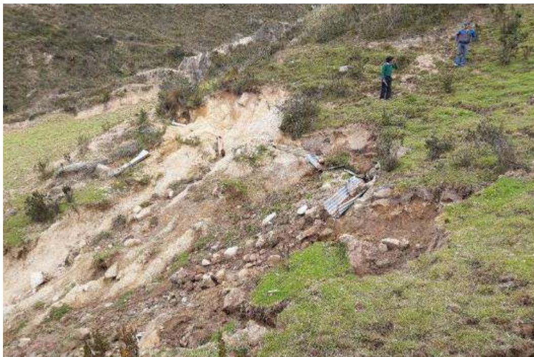
Fotografía 8. Vista del derrumbe, que afecta 16 m del canal de regadío entubado de Taurio, con coordenadas UTM: 361382 E, 8860324 N.
