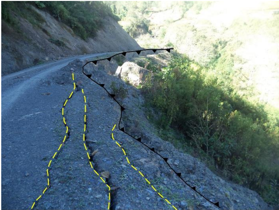
Figura 6. Vista tomada en coordenadas UTM E 724976; N 8554162. Se aprecia la plataforma de la carretera Lucma – Marampampa con el deslizamiento y sus grietas.
