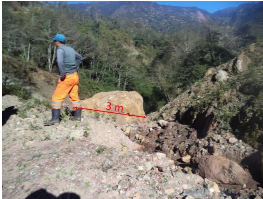
Figura 4. Bloque de roca de hasta 3 m de diámetro arrastrado y depositados en la carretera Lucma - Marampampa.
