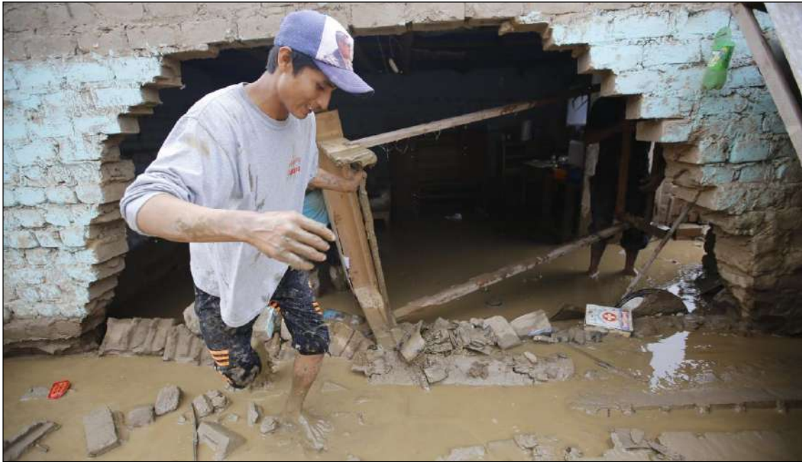
Lima 17/03/2017. Así quedaron las viviendas en la avenida Las torres, en el distrito de Lurigancho -Chosica, tras el paso de un huayco (Fuente: Diario el Comercio).
