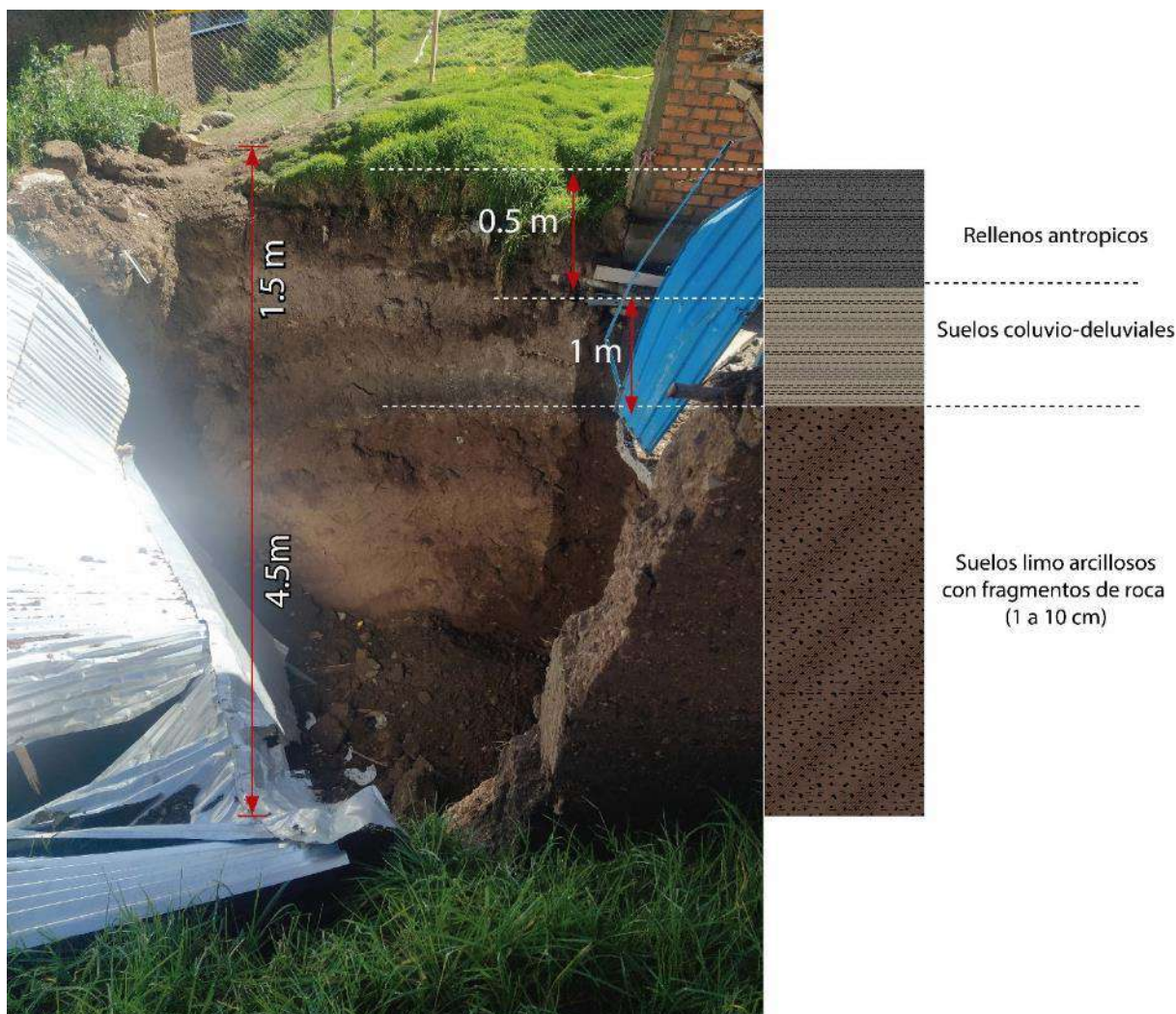
Figura 15. Hundimiento en el Barrio de Miraflores.
