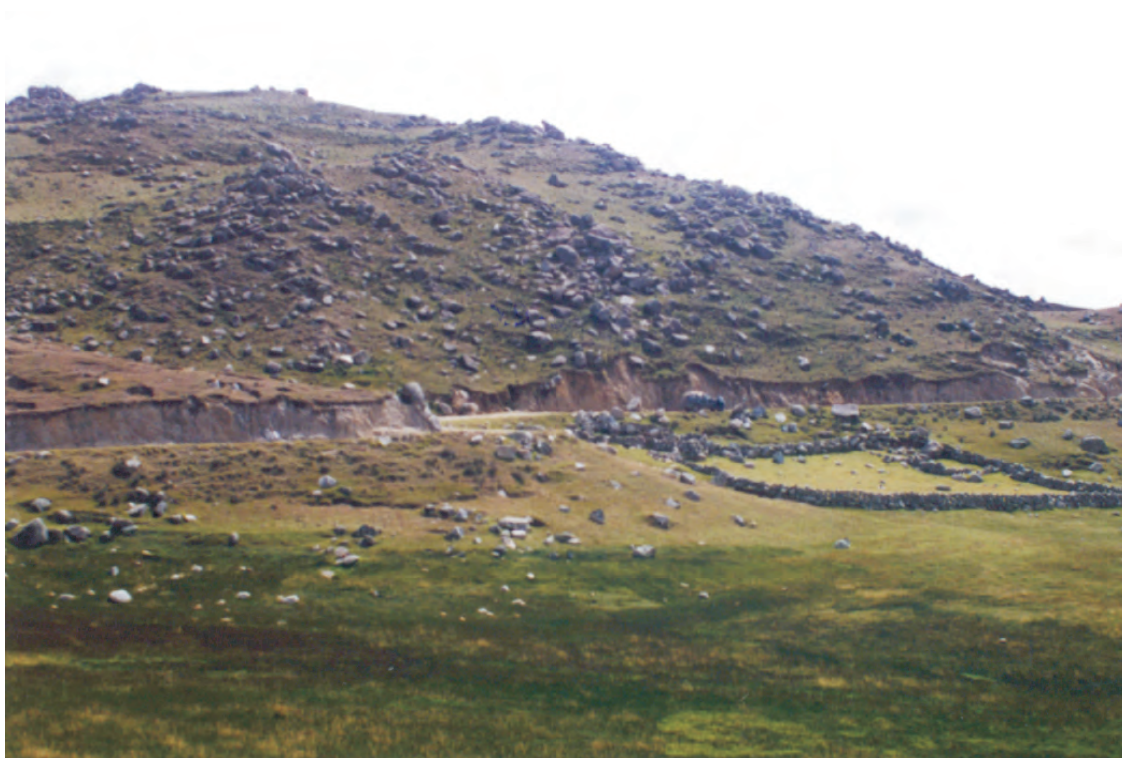
Foto N° 28 Caída de rocas que afectan el sector de la carretera Velille-Coporaque (Cusco)
