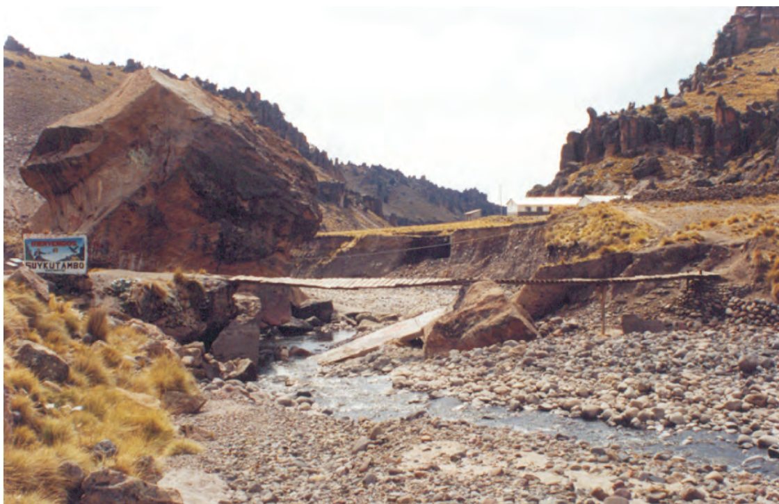
Foto N° 72 Erosión fluvial en el sector de La Virgen (Suyckutambo), ambas márgenes del río Cayomani. Afectó puente peatonal. Aguas abajo compromete poblados asentados en ambas márgenes.
