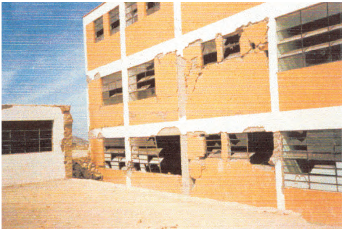
Foto N° 95 Vista exterior de un centro educativo en Nasca, afectado fuertemente por el terremoto del 12 de noviembre de 1996
