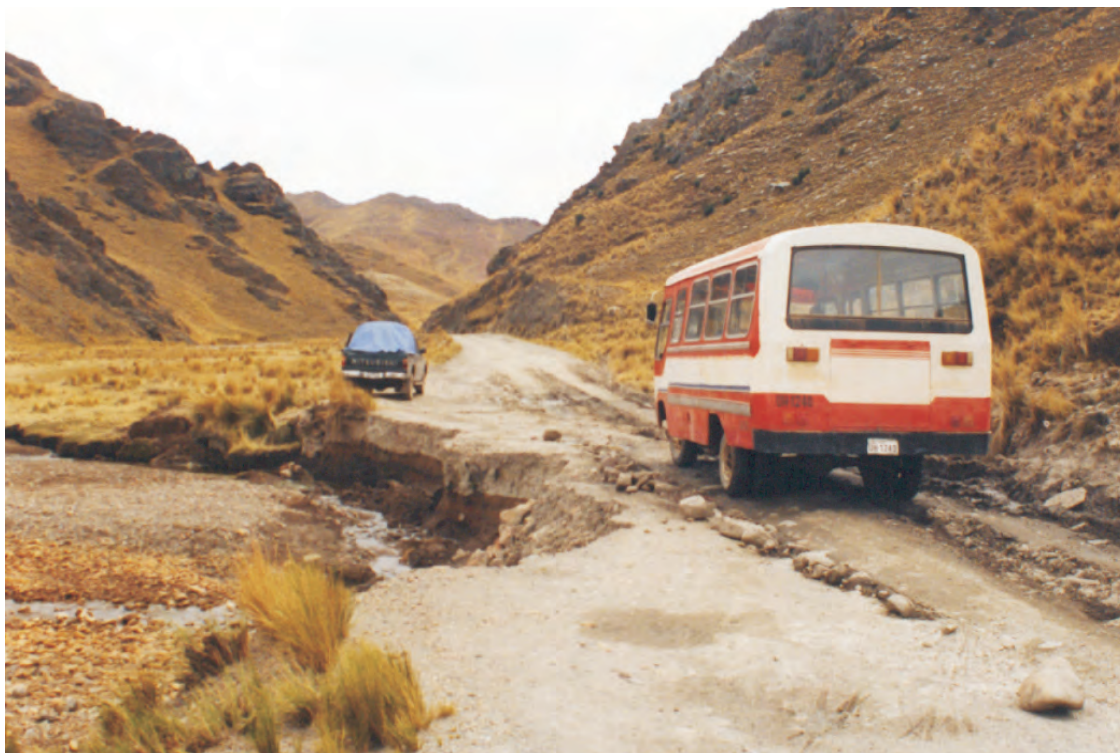
Foto N° 74 Erosión fluvial que afecta tramo de la carretera Putina-Ananea (río Toco Toco)
