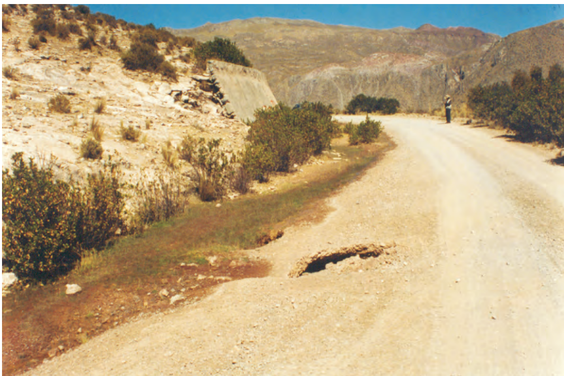
Foto N° 79 Hundimiento por karst en tramo de la carretera Huambo-Alto Sigüas; en la parte inferior afectó un reservorio de agua
