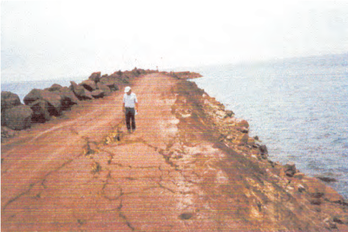
Foto N° 93 Vista del muelle de San Nicolás (Marcona). Se observan grietas y fisuras ocasionadas por el sismo de Nasca del 12-11-1996
