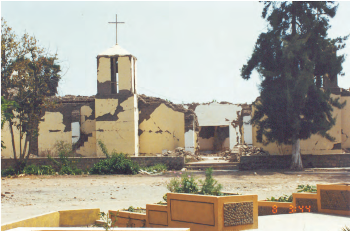
Foto N° 94 Vista de la iglesia de Acarí Viejo, que fue afectada por el sismo de Nasca del 12-11-1996
