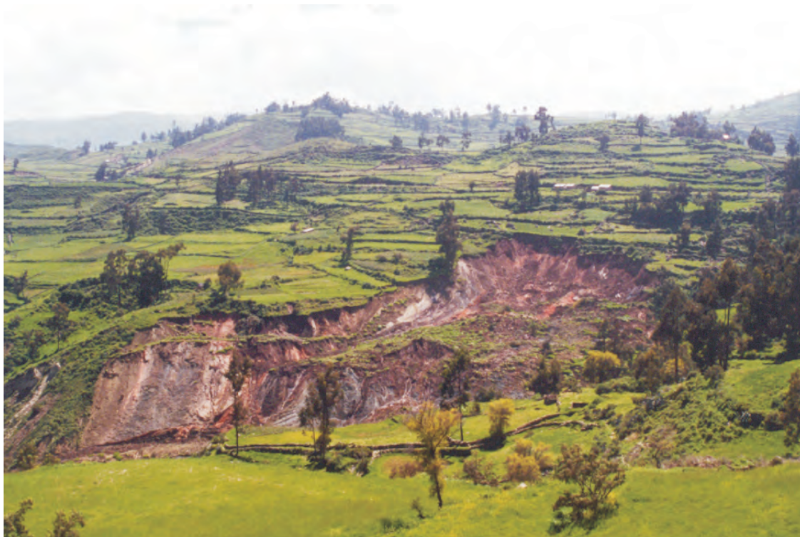
Foto N° 35 Deslizamiento de Jañahuaycco, tipo rotacional, ocurrido el 24-03-2001 en el distrito de Coracora
