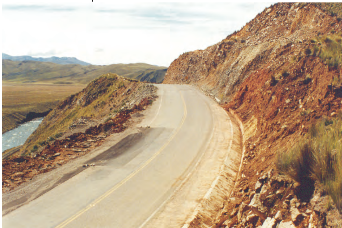
Foto N° 38 Deslizamiento que afecta carretera y línea férrea Juliaca-Arequipa en un tramo de 400 m (km 266+300)
