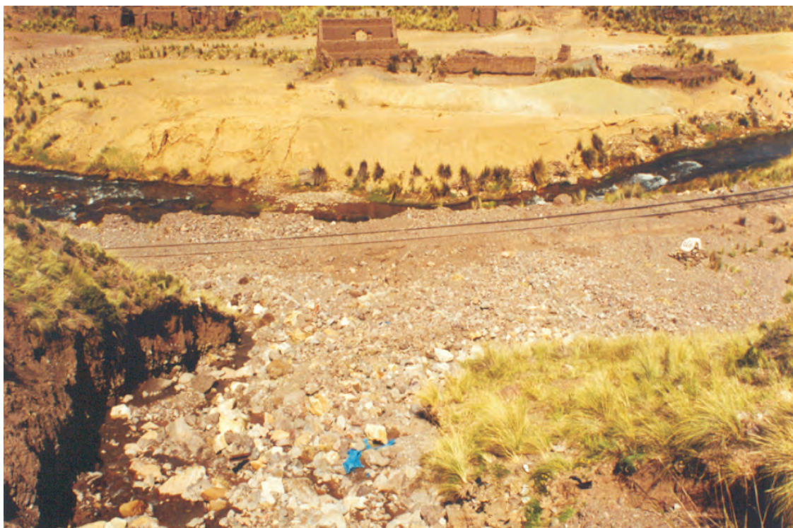
Foto N° 46 Huayco que afecta línea férrea y tramo de carretera Juliaca-Arequipa (sector Lagunillas)
