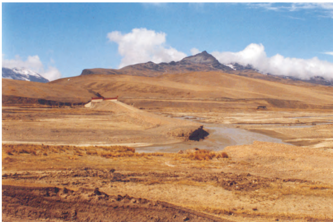
Foto N° 73 Erosión fluvial en el sector de Saytocochoa (río Grande) carretera a Putina.
