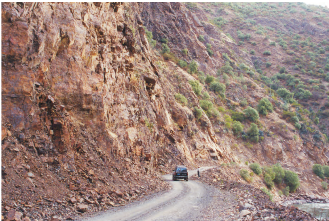
Foto N° 32 Derrumbe en sustrato calcáreo muy fracturado, corte de la carretera a Chalhuanca (sector Huamanchina). zona inestable
