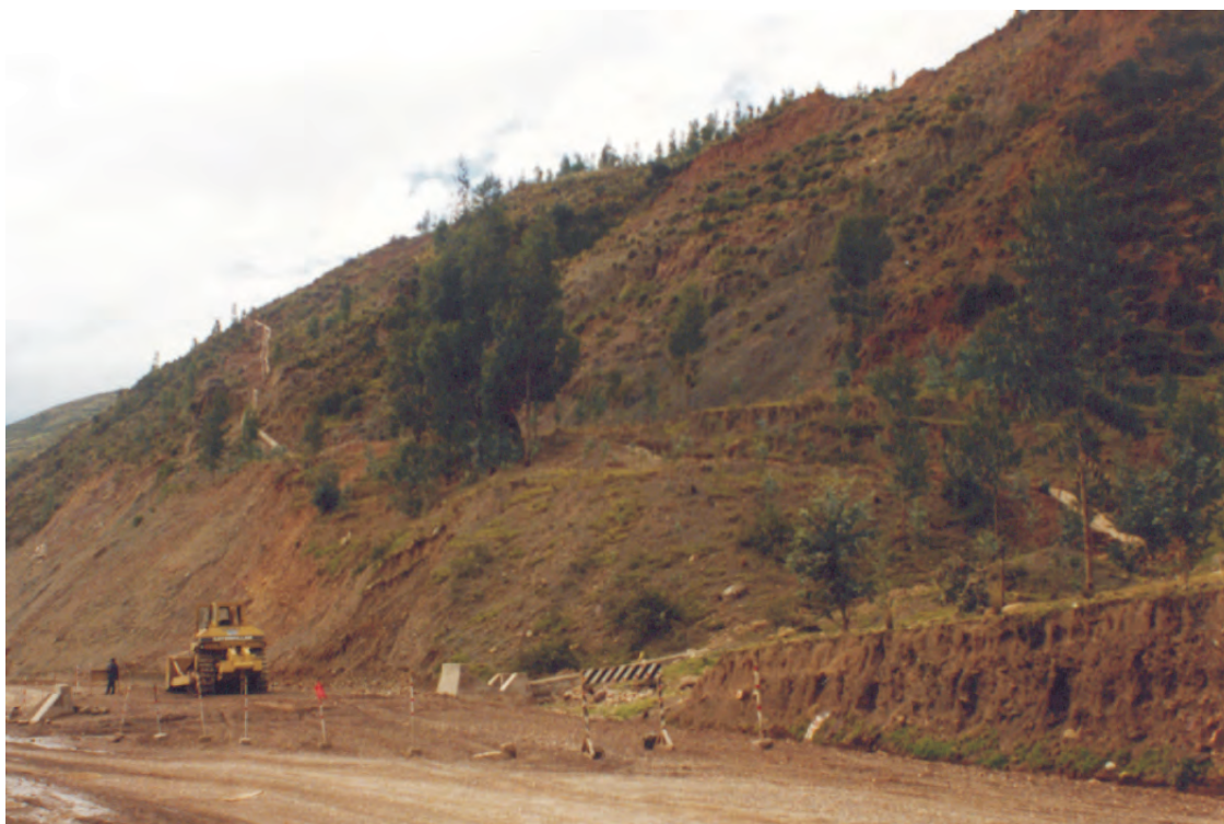
Foto N° 37 Deslizamiento cerca de Checacupe, carretera Sicuani-Cusco. Se aprecian trabajos de reforestación, zanjas de coronación en el talud comprometido. Zona inestable con lluvias que afectan tránsito carretero
