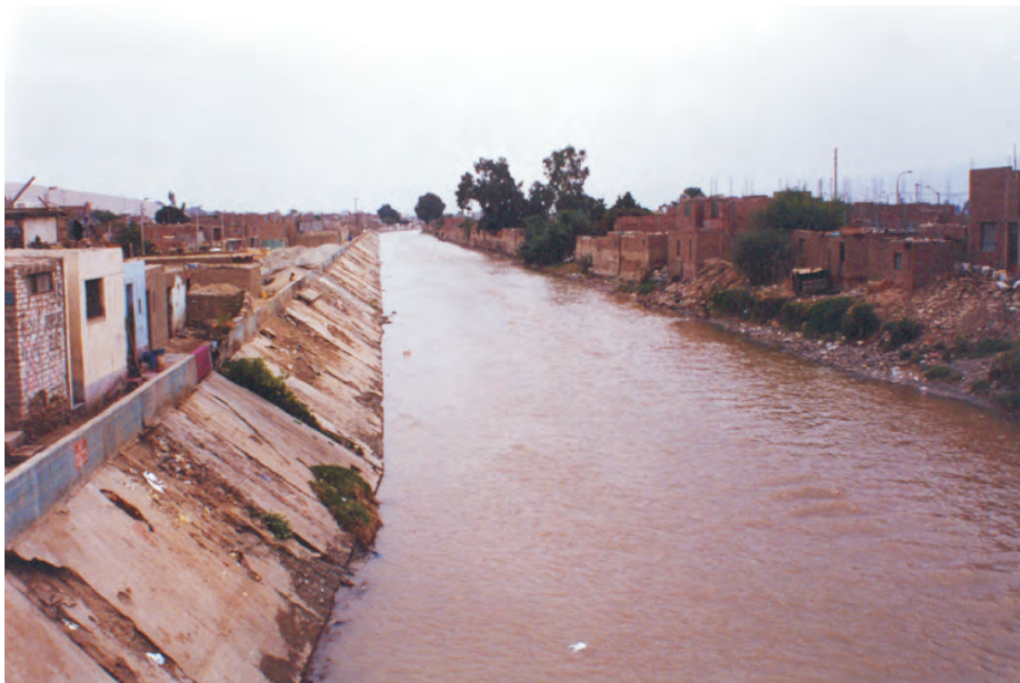
Foto N° 81 Inundación del río Ica. Viviendas en peligro en la margen derecha, sector Puente Cutervo
