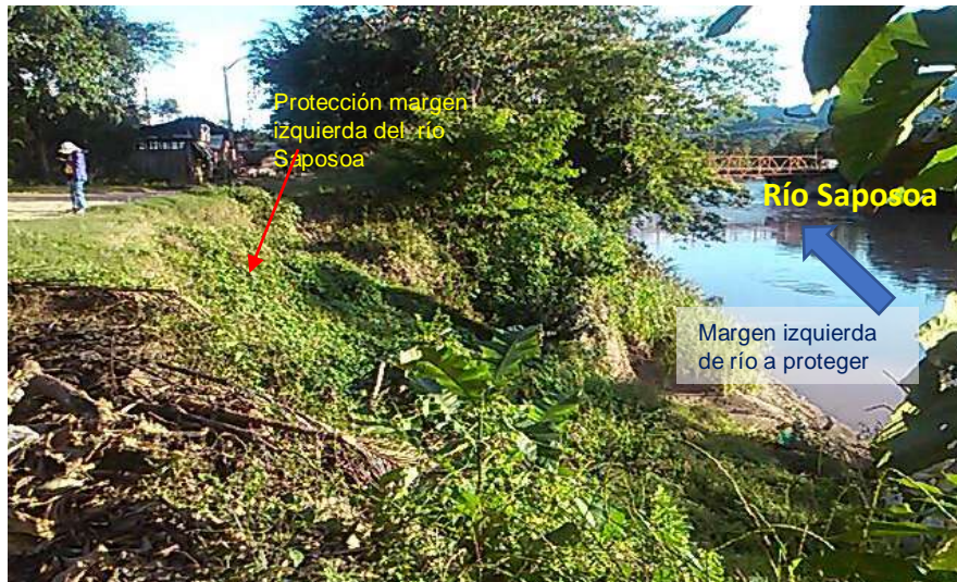
Figura 32. Terrenos de cultivo y el estribo del puente, en peligro por inundación
