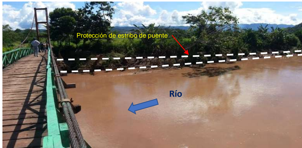
Figura 28 .Ubicación del tramo afectado en el sector Pantaleón Aguas arriba.
