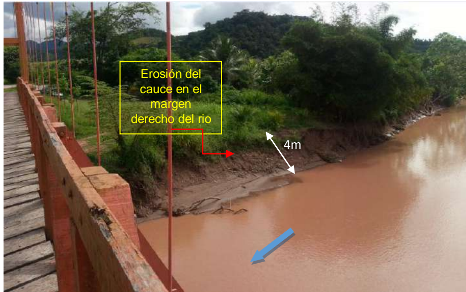
Figura 22. Vista de la erosión en el margen izquierdo del río Saposoa a causa de las crecidas, sector Puente Tingo de Saposoa
