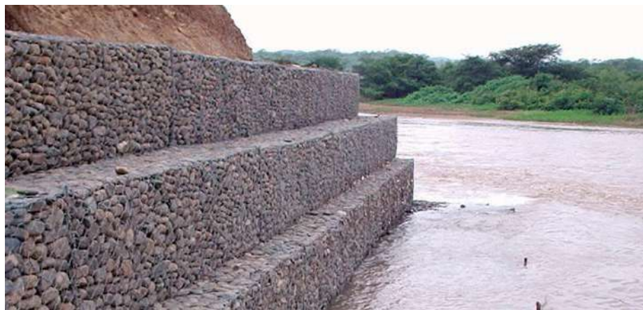
Figura N°4: Muro de defensa con gaviones
