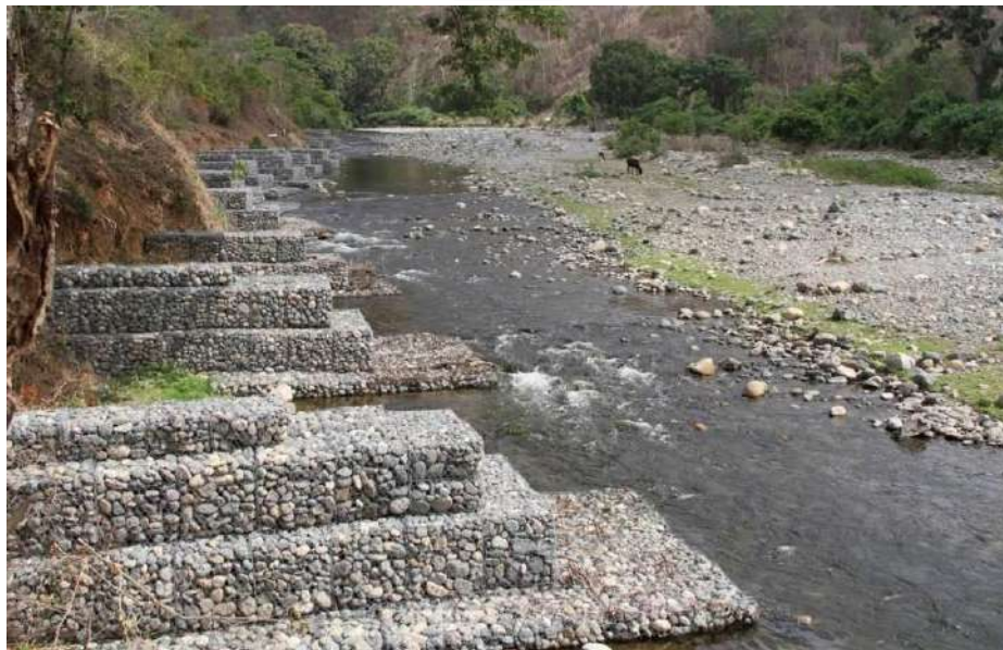
Figura N° 5: Vista de espigones con gaviones para el control de la erosión en ríos.
