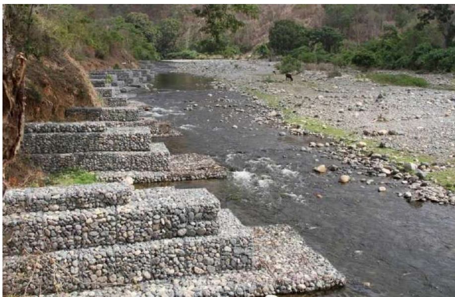
Figura N° 3. Vista de espigones con gaviones para el control de la erosión en ríos.
