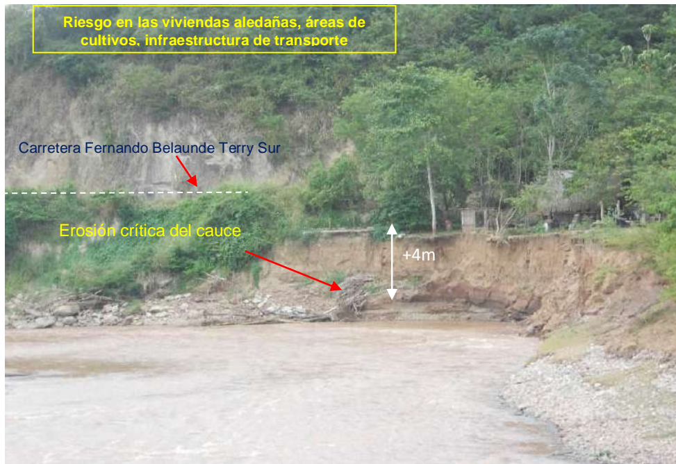
Figura 25. Erosión en el margen derecho del río, distrito de Sacanche.
