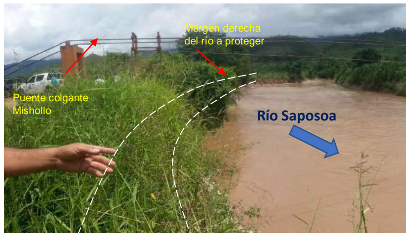
Figura 30 Terrenos de cultivo y estribo de puente en peligro por erosión.
