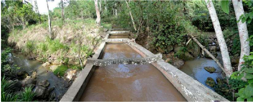
Figura N° 4.- Vista de la canaleta que cruza una pequeña quebrada rellena de bloques rodados en la localidad de Josué Alvarado (1.33 Km al O de Saposoa) en la margen derecha (donde se ubicó la Calicata N° 3), que forman parte de la terraza alta, a unos 120 m antes de llegar a la ribera del río donde forma una saliente.
