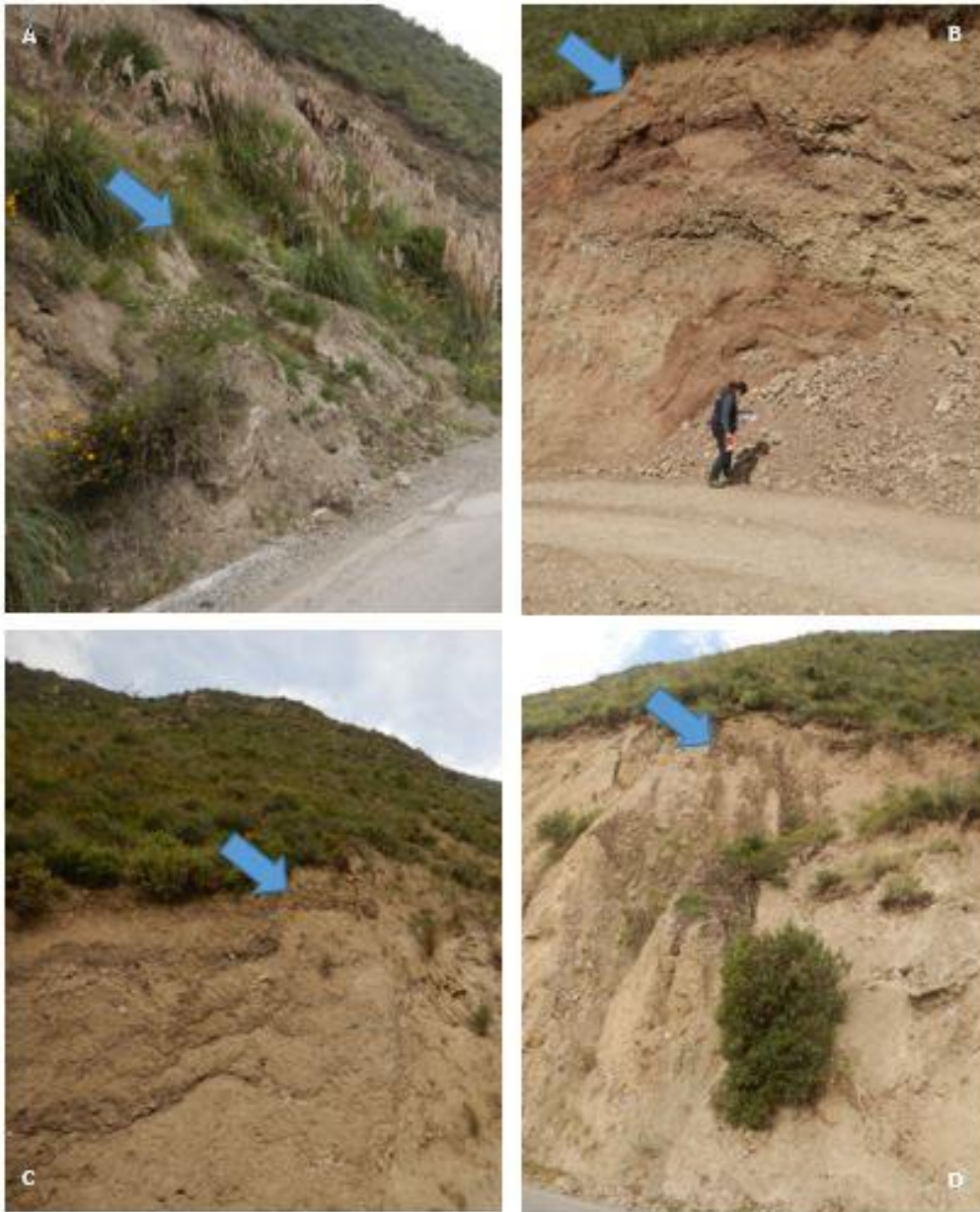
Figura 20. Imágenes A, B, C y D muestran puntos emanación de agua sobre talud del corte de carretera.
