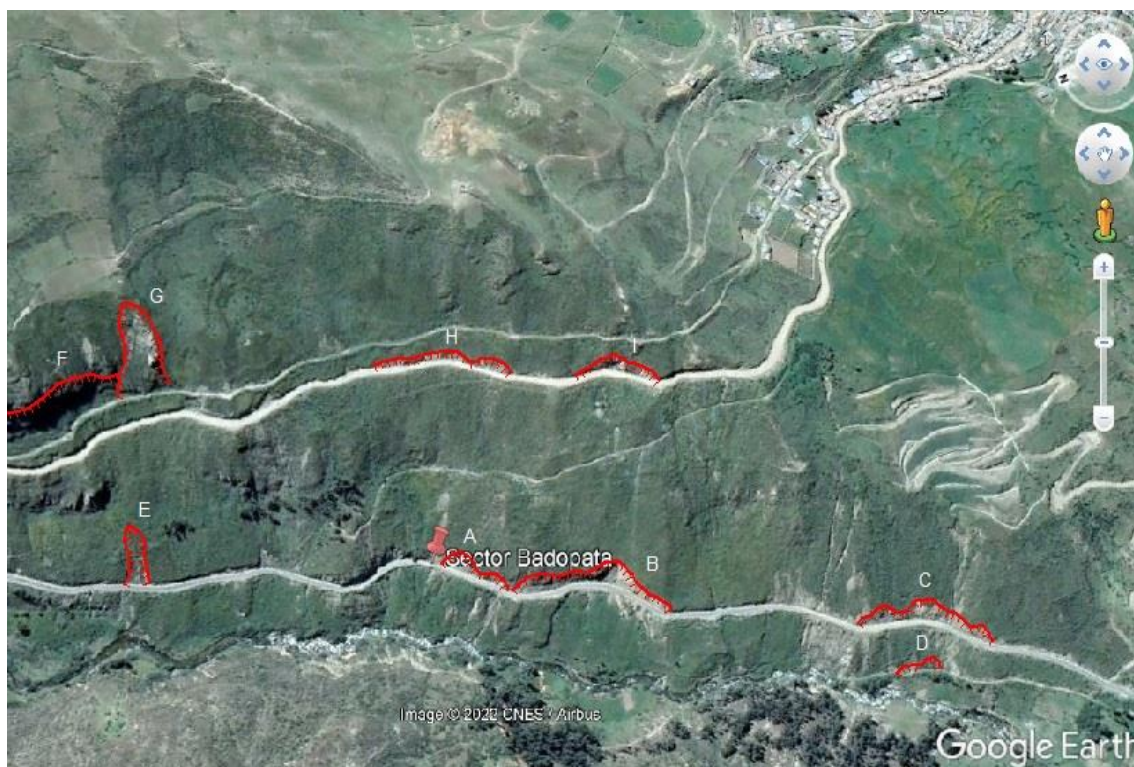
Figura 17. Vista de derrumbes identificados en el área de evaluación, captada de Google Earth.
