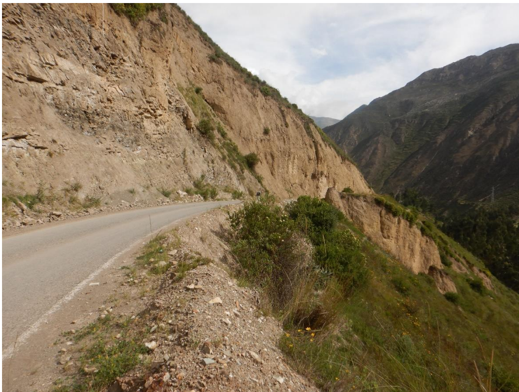
Figura 22. Se observa corte de talud, que inestabiliza la ladera.
