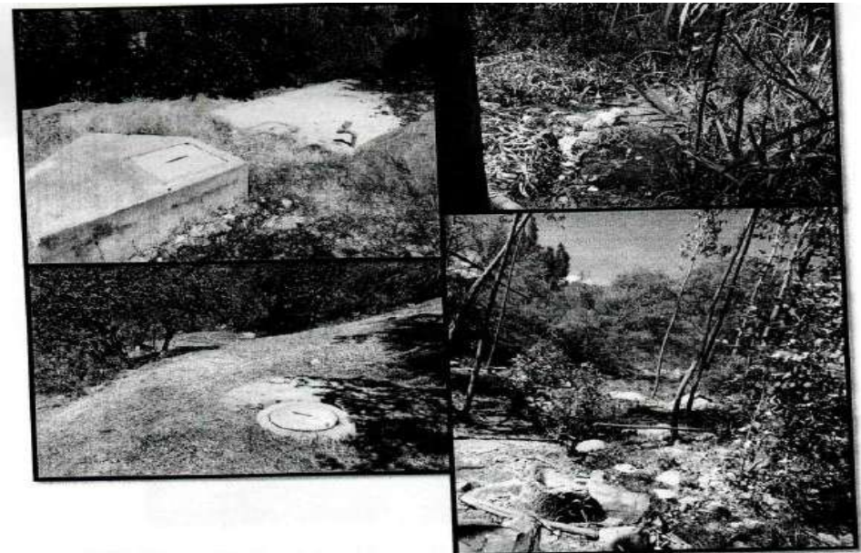
FOTO N° 01. SE OBSERVA EN LA FOTOS, LOS COMPONENTES DE AGUAS RESIDUALES LO CUAL ESTAN INOPERATIVOS POR LOS CUALES, EN PUNTO DE AFLUENTE DEL PTAR SALE UN OLOR DESAGRADABLE, EN CONSECUENCIA PROVOCA CONTAMINACION AMBIENTAL, ASI COMO LA SALUD DE LA POBLACION CERCANA CORE RIESGO.
