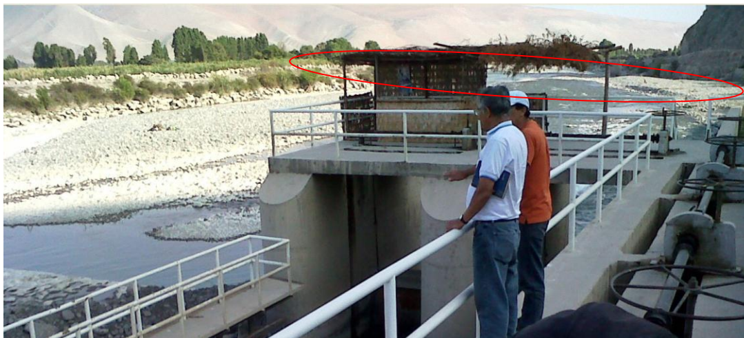
Figura 114. Existencia de Bocatoma Hacendados
