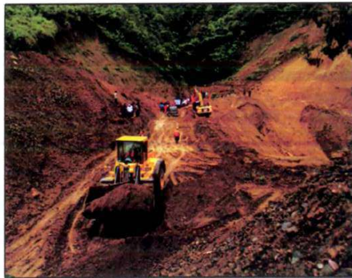
Foto N° 01: Deslizamiento en el sector de Santa María. Se observan los trabajos de limpieza en la trocha carrozable para habilitar el tránsito vehicular en la ruta Cusco-Quillabamba.
