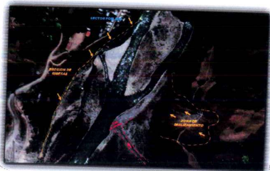
Foto N° 05: Vista Sector San Pablo se observa la erosión de riberas hacia la margen derecha y hacia la margen izquierda zona de deslizamiento y cono aluvional.
