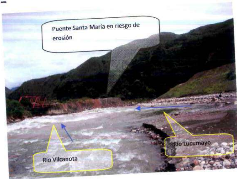
Foto. Riesgo de erosión en la margen derecha del puente Santa María, en la confluencia de los ríos Vilcanota y Lucumayo.
