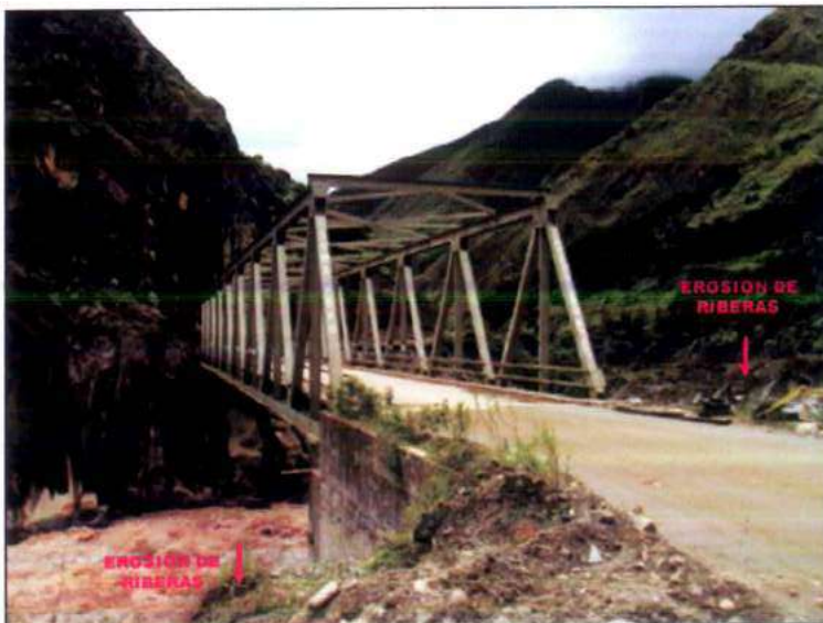
Foto N° 01: Vista Sector Carrilluchayoc, se observa la erosión de riberas.
