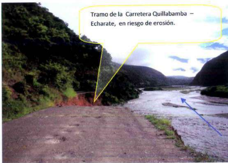
Foto. Riesgo de erosión de la carretera Quillabamba - Echarate en la margen izquierda del río Vilcanota, aprox. 1000 aguas abajo del centro poblado de Quillabamba.
