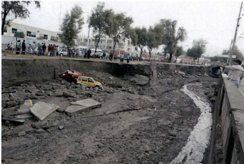
IMAGEN NRO. 1.1.3: EROSIÓN Y DERRUMBES, EN AV. VENEZUELA (AÑO 2013).
