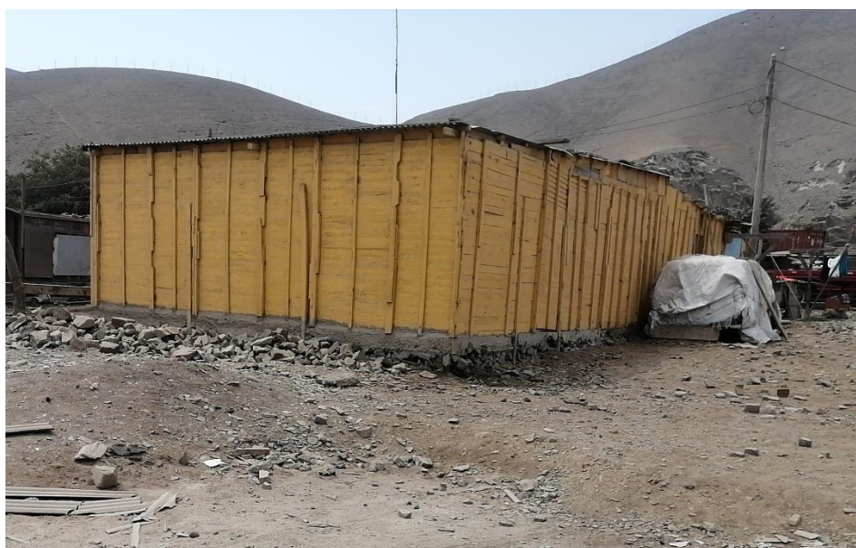
Foto N° 8. Vivienda con material precario de madera, no tienen agua ni desagüe. Mz B lote 18
