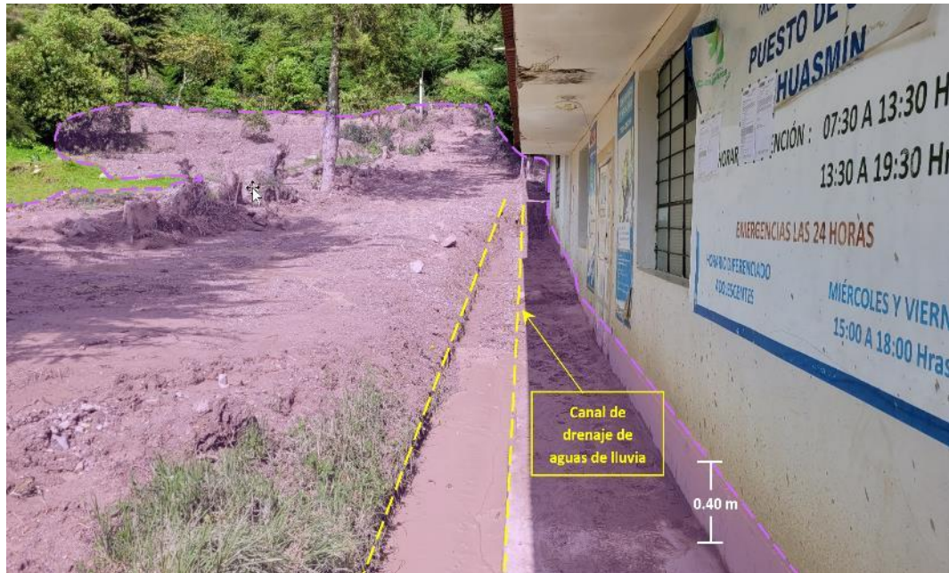
Figura 21. Se observa que el canal de drenaje de aguas de lluvia se colmató con en flujo de detritos.
