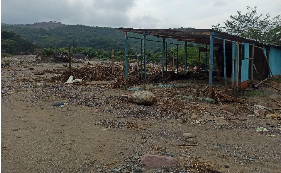
Fotografía 5. Flujo de detritos y sus efectos en el albergue La Caldera (1 casa afectada y 7 viviendas inhabitables).
