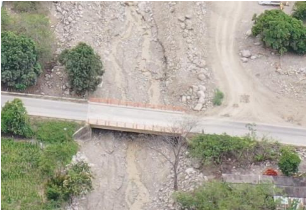
Fotografía 6. Flujo de detritos y sus efectos en el puente La Caldera.
