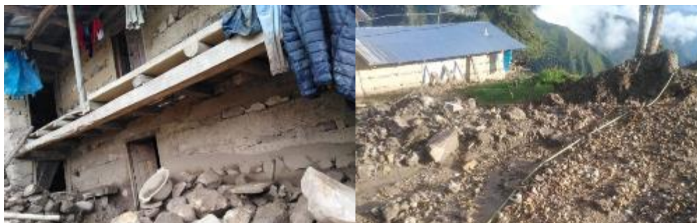
Fotografía 8. Viviendas afectadas durante la activación del flujo de detritos en La Chamana.
