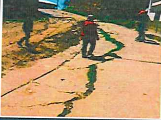
Fotografía N° 01.: Área de asentamiento afectando infraestructura vial en la ciudad de Parobamba.
