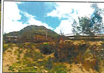
Fotografía N° 02.: Cerco Perimetrico de Institucion Educativa expuesto a la erosión fluvial del Río Rupac.
