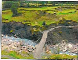
Fotografía N° 01. Puentes peatonales expuestos a la alta erosión fluvial en el río Rupac.
