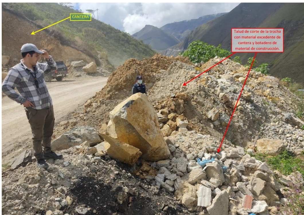
Figura 23. Material excedente de la cantera y escombros (material de desecho de construcción), es acumulado en el talud de corte.
