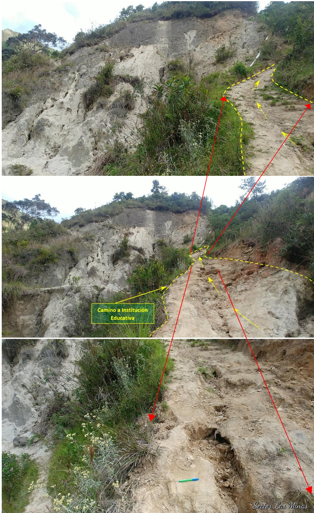
Figura 12. Zona de fuerte erosión hídrica afecta camino de acceso a Institución Educativa N° 17026 – Las Minas, desde la parte baja (vía afirmada). Coordenadas UTM WGS84, zona 17S, Norte: 9304071 – Este: 775273
