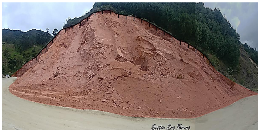
Figura 10. Se observa el derrumbe en el talud de corte de la carretera Sócota – Cutervo. Coordenadas UTM WGS84, Norte: 9304117 – Este: 755293.
