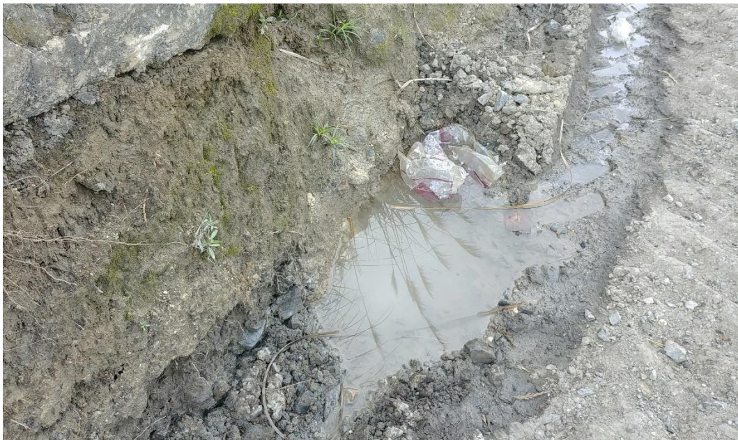
Fotografía 7. Surgencia de agua en la canaleta de la vía asfaltada, indicador de terrenos saturados.
