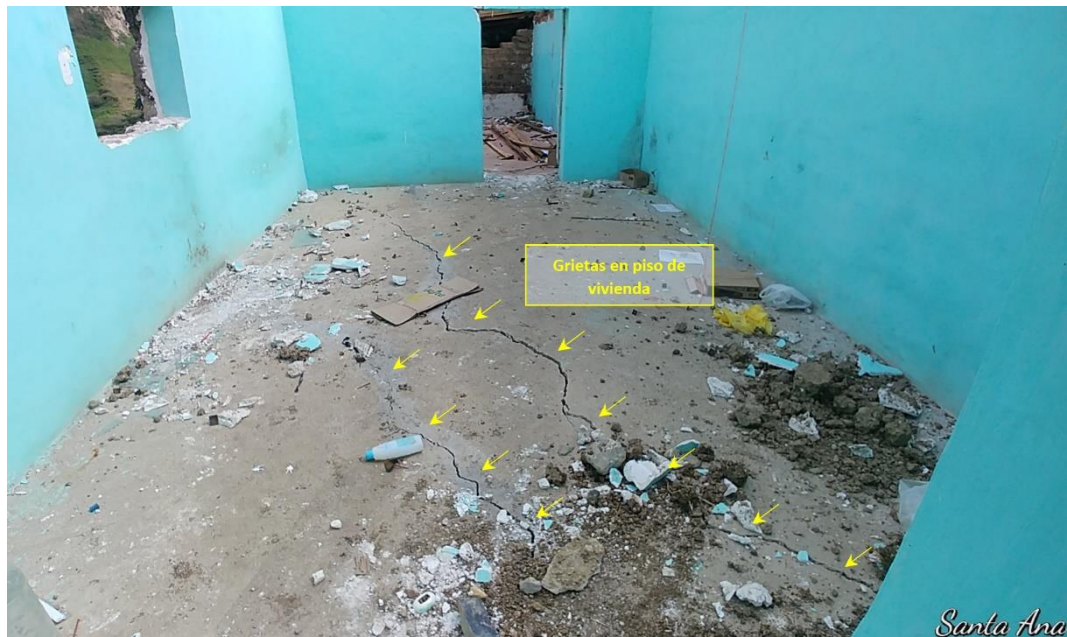
Figura 17. Vivienda inhabitable, pisos agrietados. Coordenadas UTM WGS84, Norte: 9301827 – Este: 753948.
