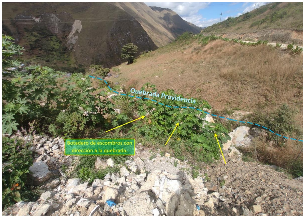
Figura 24. Escombros (material de desecho de construcción), es acumulado en el talud de corte en dirección a la quebrada.
