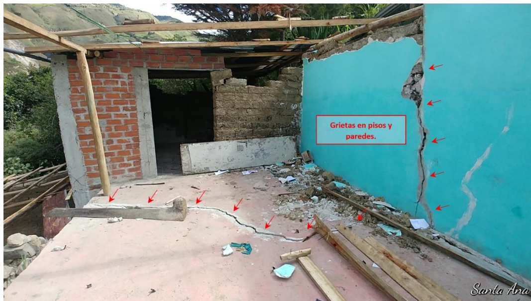
Figura 18. Vivienda muy afectada (inhabitable), paredes y pisos agrietados. Coordenadas UTM WGS84, Norte: 9301821– Este: 753944.
