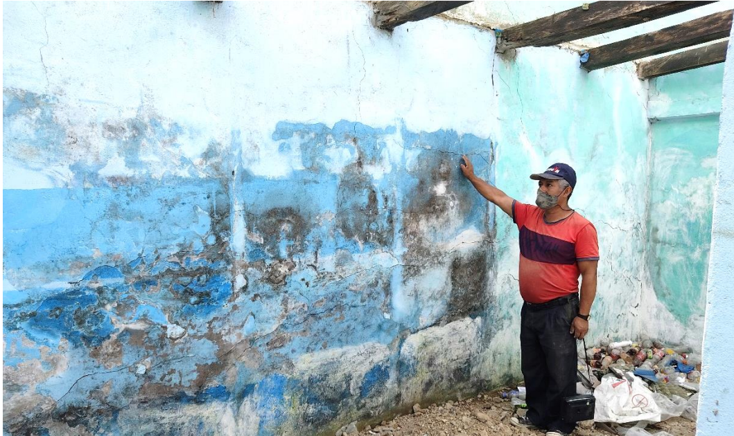
Fotografía 7. Humedad en pared de vivienda afectada.
