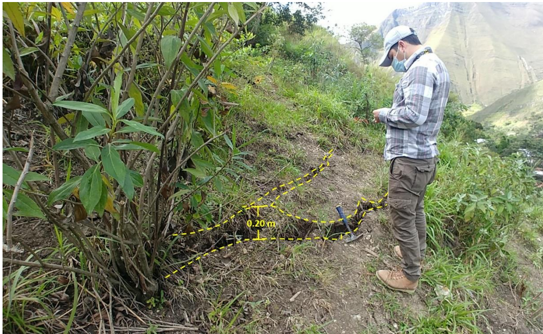
Figura 15. Grietas en la parte posterior al escarpe con longitud de 4 m y ancho de 0.20 m. Coordenadas UTM WGS84, Norte: 9301875 – Este: 753962.
