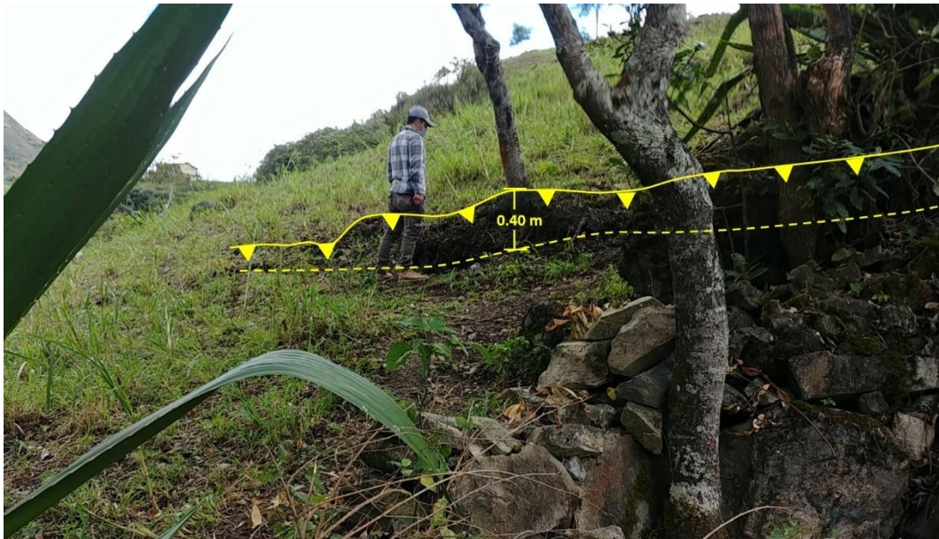
Figura 13. Escarpe principal, con salto vertical entre 0.20 a 0.50 m. Coordenadas UTM WGS84, Norte: 9351802 – Este: 813489.
