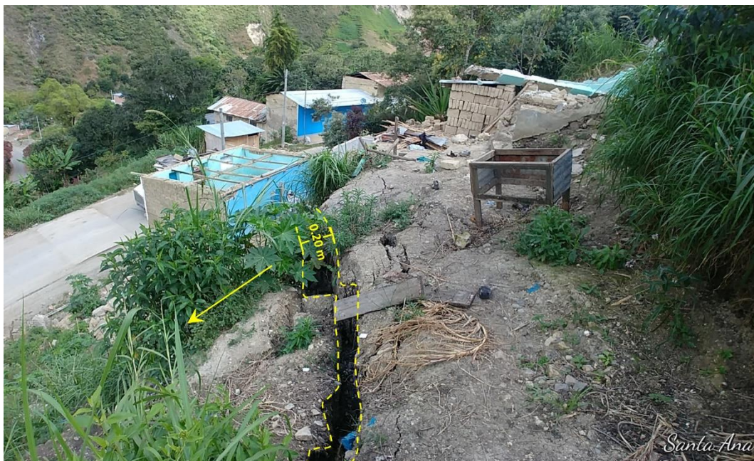
Figura 14. Grieta dentro del cuerpo deslizado con longitud de 8 m y ancho de 0.20 m. Coordenadas UTM WGS84, Norte: 9351876 – Este: 813457.
