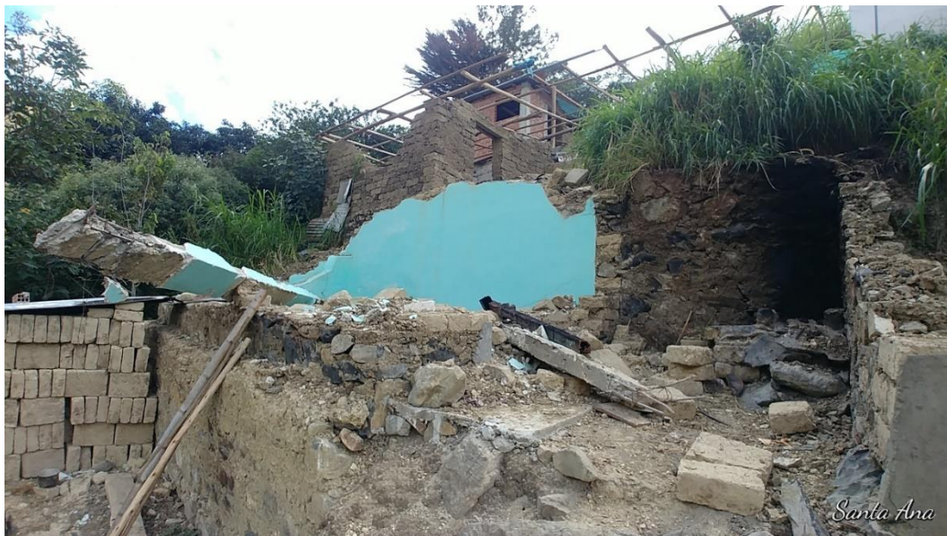
Figura 19. El deslizamiento originó el colapso de la vivienda. Coordenadas UTM WGS84, Norte: 9301816– Este: 753941.
