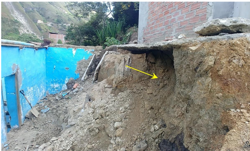
Figura 20. Bajo la losa de cemento puede apreciarse que, el terreno se encuentra saturado. Coordenadas UTM WGS84, Norte: 9301819 – Este: 753940
