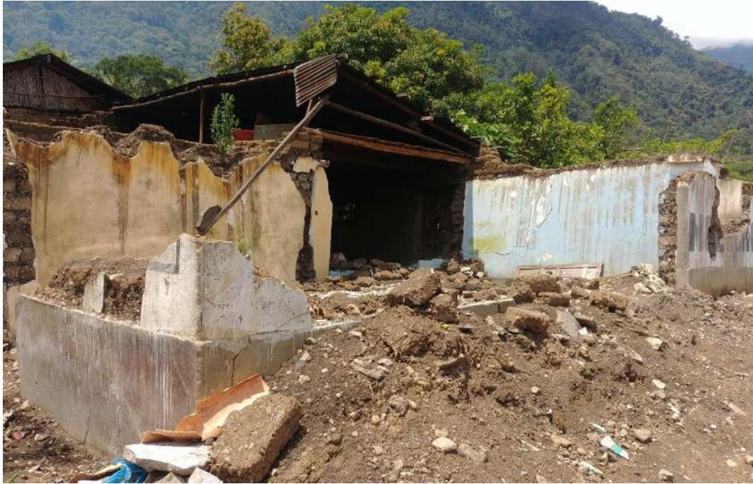
Fotografía 3. Viviendas totalmente destruidas en el flanco izquierdo del deslizamiento. Coordenadas UTM WGS84, Norte: 9351781– Este: 813495.
