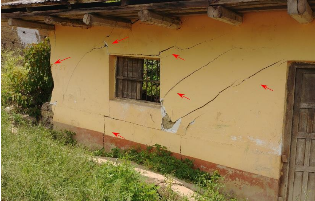
Figura 10. Grietas en pared de vivienda y colapso de muro. Coordenadas UTM WGS84, Norte: 9351831 – Este: 813474.
