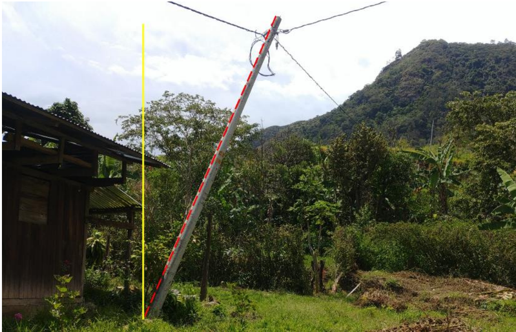
Figura 16. Postes de suministro eléctrico muy inclinados, hasta llegar a 50° del nivel del terreno. Coordenadas UTM WGS84, Norte: 9351878 – Este: 813427.
