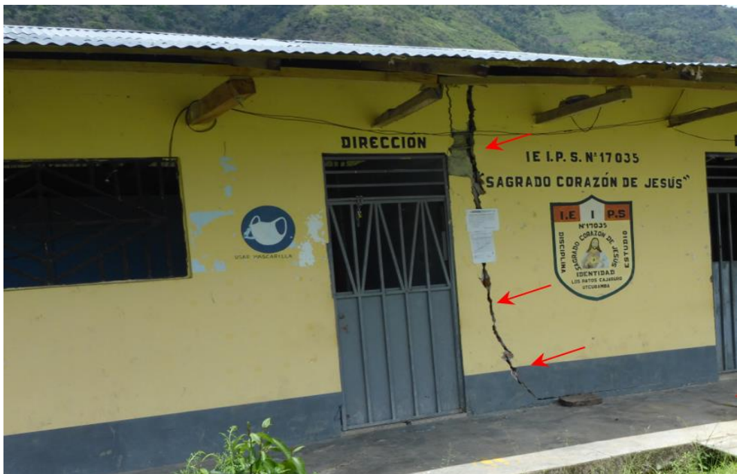
Figura 13. Pared de I. E. N° 17035, que puede colapsar, se aprecia agrietamientos de paredes. Coordenadas UTM WGS84, Norte: 9351800 – Este: 813405.
