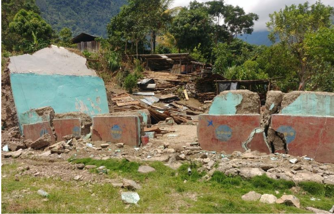
Fotografía 4. Vivienda destruida por el desplazamiento del deslizamiento. Coordenadas UTM WGS84, Norte: 9351858 – Este: 813465.
