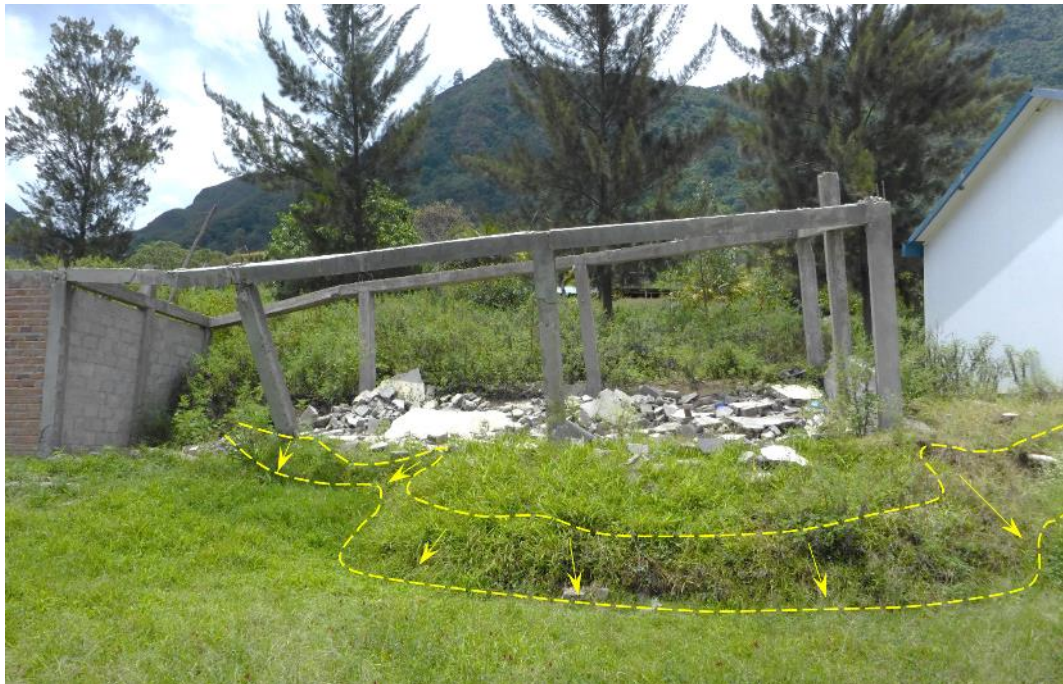
Figura 14. Colapso de columnas en proceso de construcción para aulas. Se aprecia agrietamiento del terreno (limitado con línea amarilla), que tiene un ancho de 80 cm y una longitud de 9 m.
