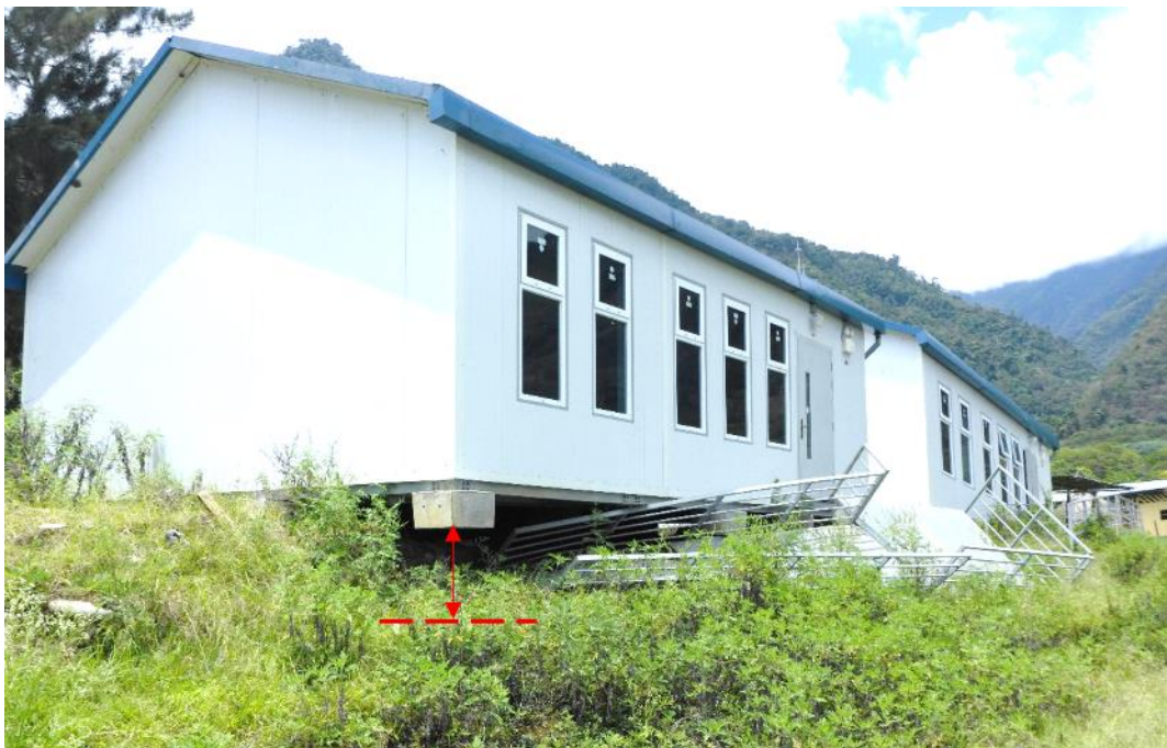
Figura 15. Aulas prefabricadas y accesos en mal estado, ocasionados por el avance del deslizamiento Coordenadas UTM WGS84, Norte: 9351803 – Este: 813418.
