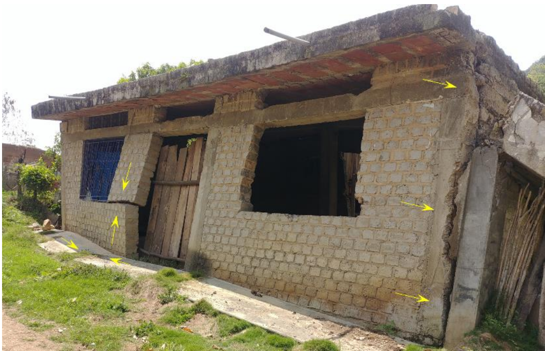
Figura 11. Vivienda muy afectada (inhabitable). Coordenadas UTM WGS84, Norte: 9351878 – Este: 813427.
