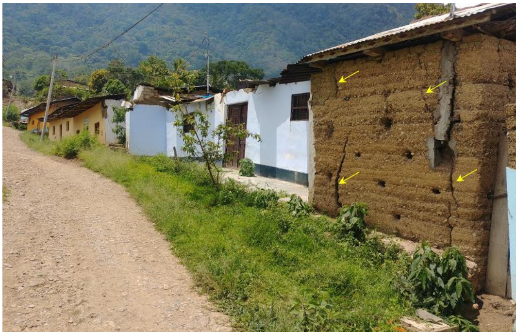
Figura 8. Grietas con ancho de 5 cm a 10 cm, en paredes de viviendas. Coordenadas UTM WGS84, Norte: 9351802 – Este: 813489.
