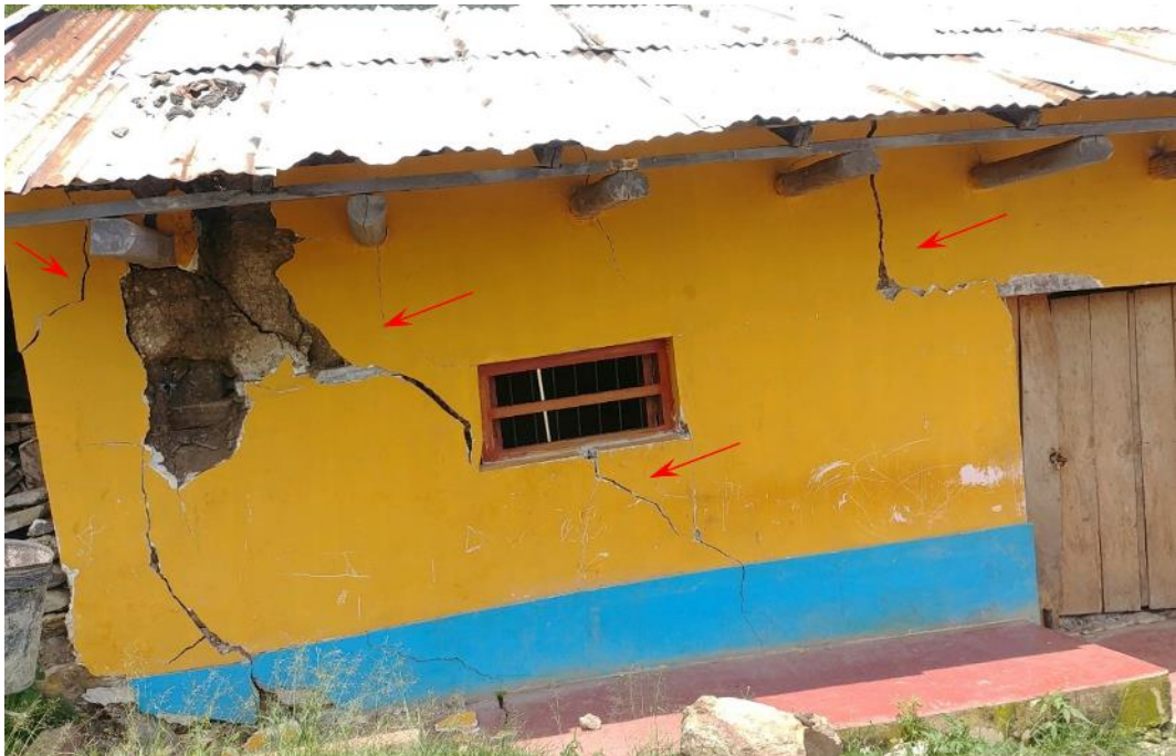
Figura 9. Grietas en pared de vivienda inhabitable. Coordenadas UTM WGS84, Norte: 9351856 – Este: 813466.
