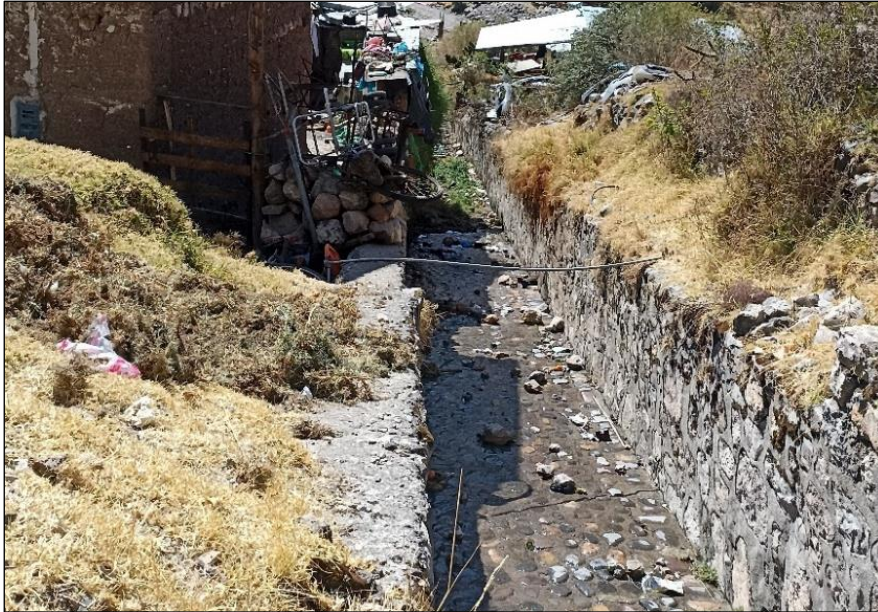
Figura N° 02. Imagen de la zona inferior de la quebrada Sasaiya en estado deteriorado.
