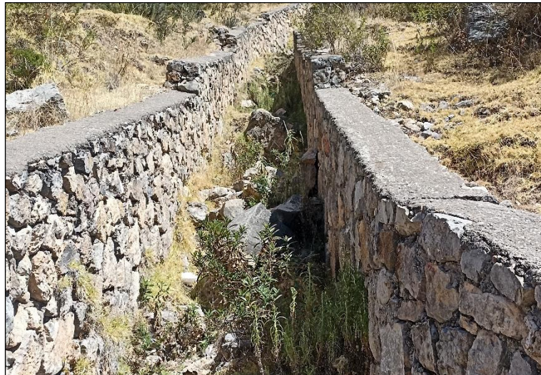
Figura N° 034. Sectores sin mantenimiento
