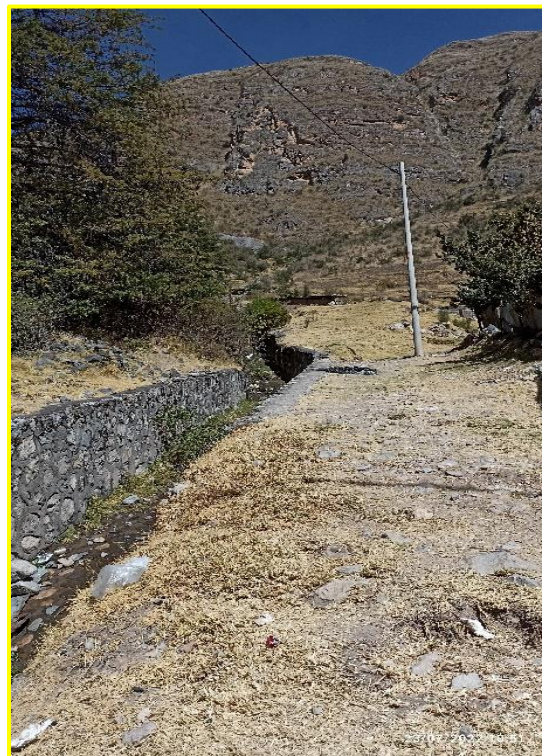
Fotografía 04: Se observa la parte media, vista hacia el oeste del cauce de la Qda. Sasaiya que se encuentra deteriorado por falta de mantenimiento a la estructura.
