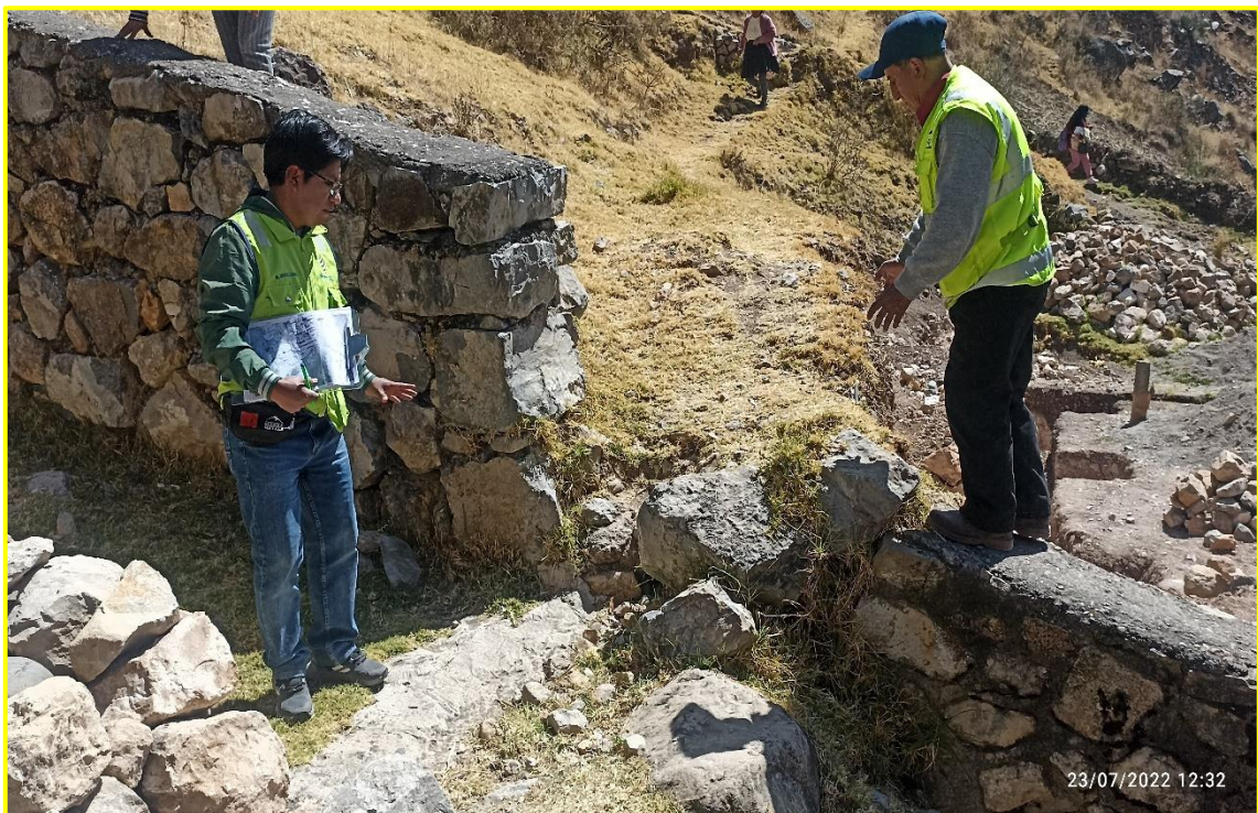
Fotografía 14: Ubicación de puntos críticos, parte media Qda Sasaiya
