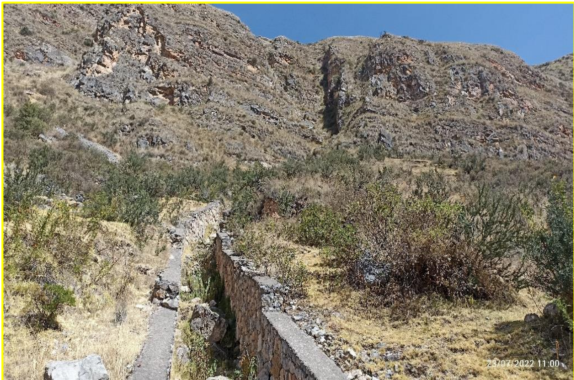
Fotografía 08: Vista de la infraestructura dañada del cauce de la Qda Sasaiya ubicado en la zona superior del área en evaluación
