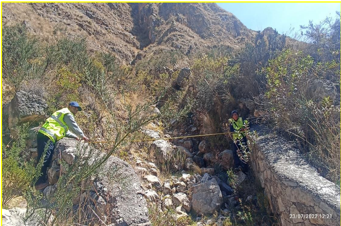
Fotografía 12: Levantamiento del cauce parte superior donde inicia la canalización de la Qda. Sasaiya, identificando daños y obstrucciones.
