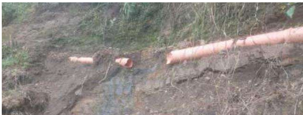
Fotografía 4. Daños en 50 m tramo de vía CA-920 (arriba) y 20 m tubería de regadío (abajo) por la reactivación de un derrumbe – flujo en junio de 2022. Ubicación - Este: 769971; Norte: 9294482; Altitud: 2307. Fuente: Municipalidad Distrital de Tacabamba.
