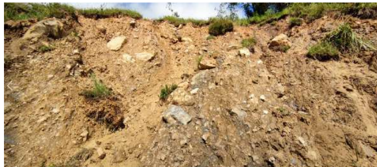
Fotografía 2. Depósito coluvio deluvial ubicado en un talud de la vía CA-920. Ubicación: E: 770021; N: 9294117; Z: 2311.
