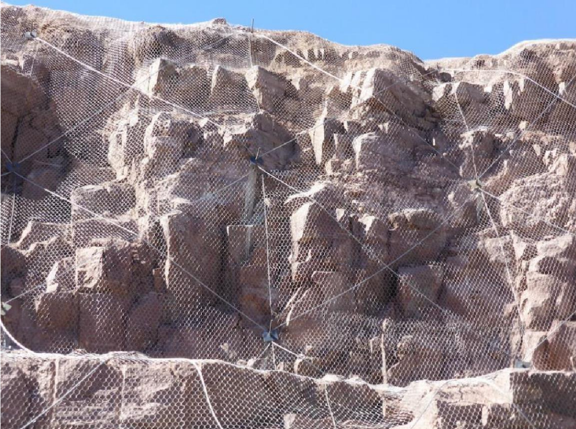
Fotografía 7. Control de caída de rocas utilizando mallas ancladas.
