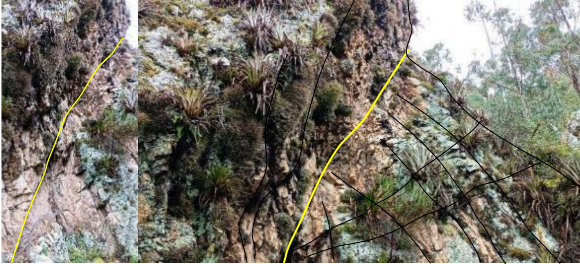
Figura 17. Afloramientos de areniscas muy fracturadas y deformadas originadas por una falla de tipo normal.
